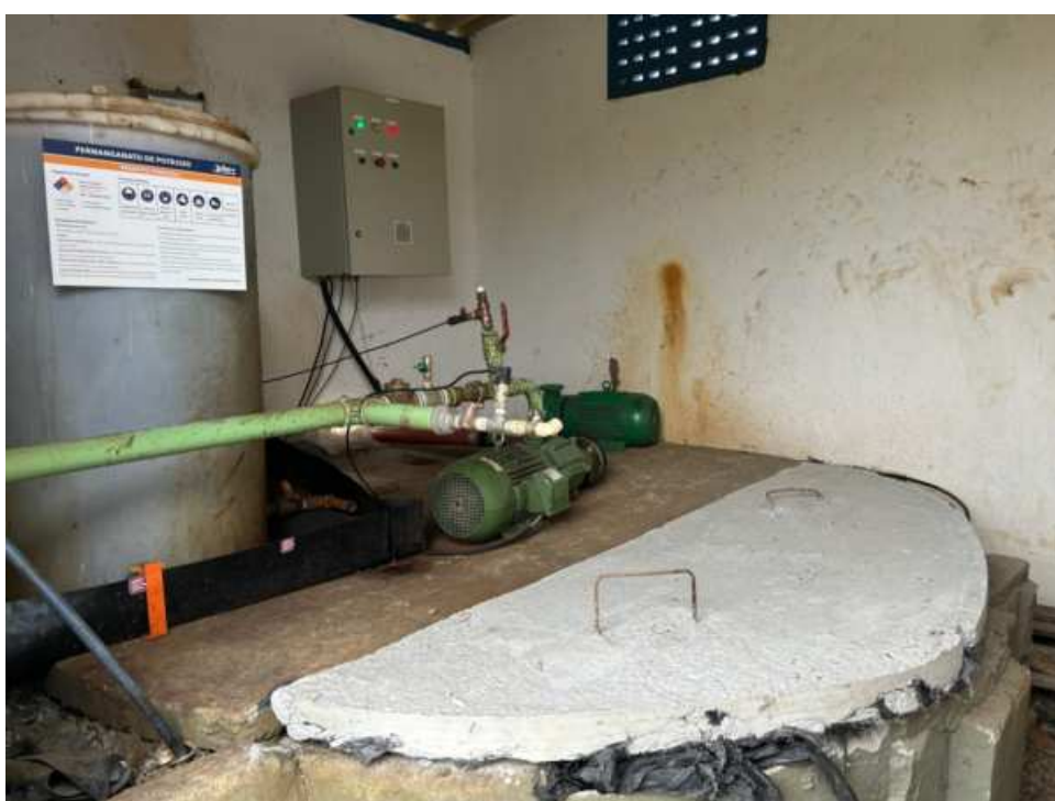
Foto 3 – Interior da EEAB
