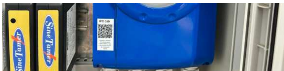
Foto 17– Macromedidor de vazão de saída
