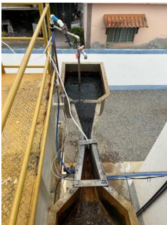
Foto 8 – Chegada da água bruta onde é realizada a dosagem do coagulante (sulfato de alumínio)
