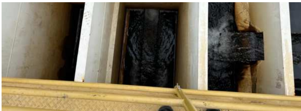
Foto 11 – Câmaras de filtração
