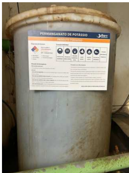
Foto 5 – Tanque de Permanganato de Potássio
