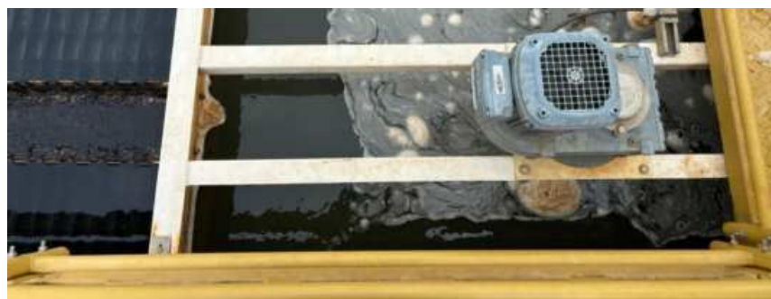
Foto 9 – Tanque de floculação
