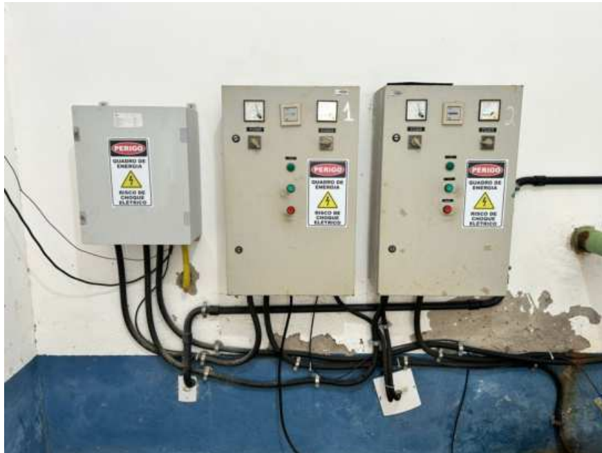
Foto 16 - Painel de automação dos conjuntos motobombas
