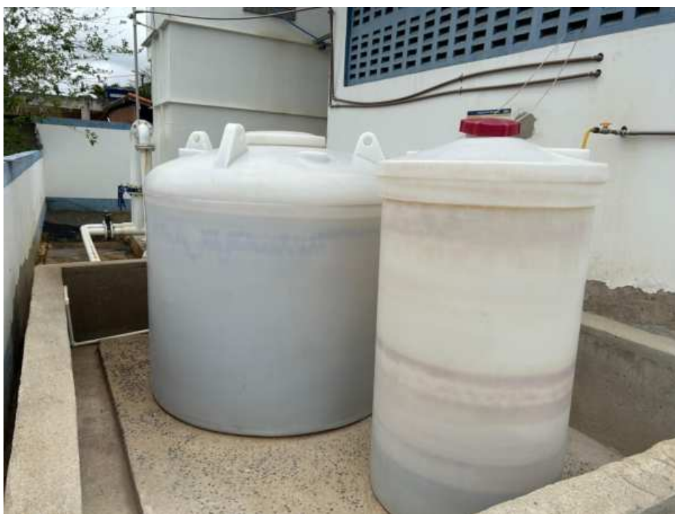
Foto 12 – Tanques de hipoclorito de sódio com dique de contenção
