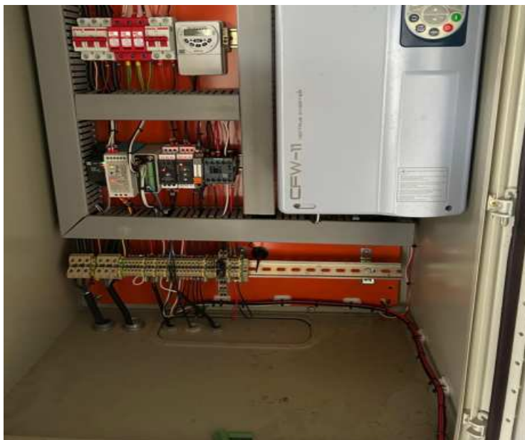
Foto 4 – Interior do quadros de automação e inversor de frequência da unidade
