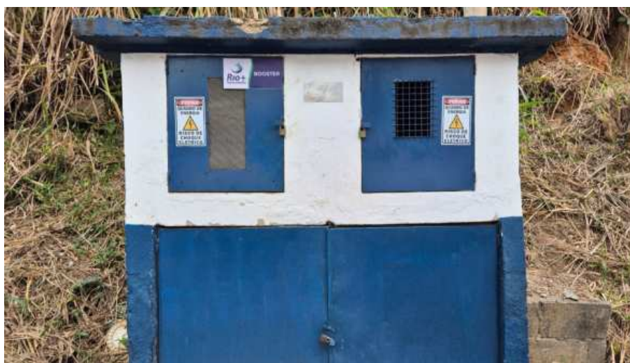
Foto 5 – Abrigo da EEAT com identificação
