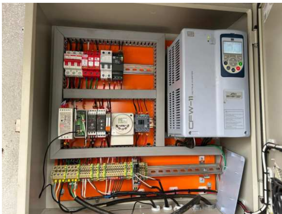
Foto 20 – Interior do painel de automação e visualização do inversor de frequência
