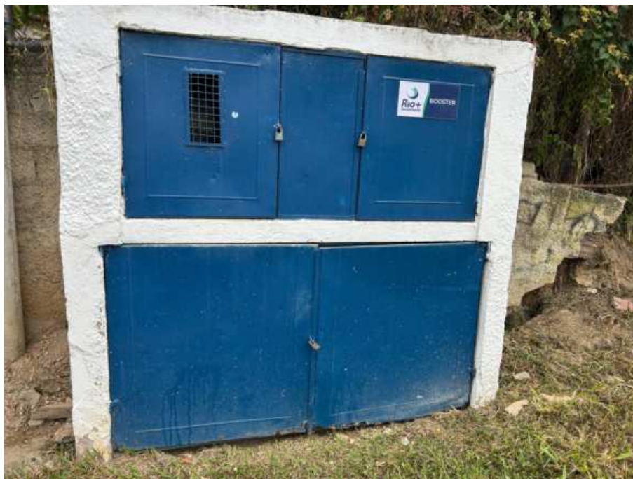
Foto 25 – Abrigo da EEAT com identificação
