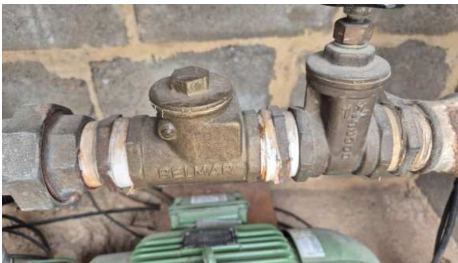
Foto 7 – Válvula de retenção
