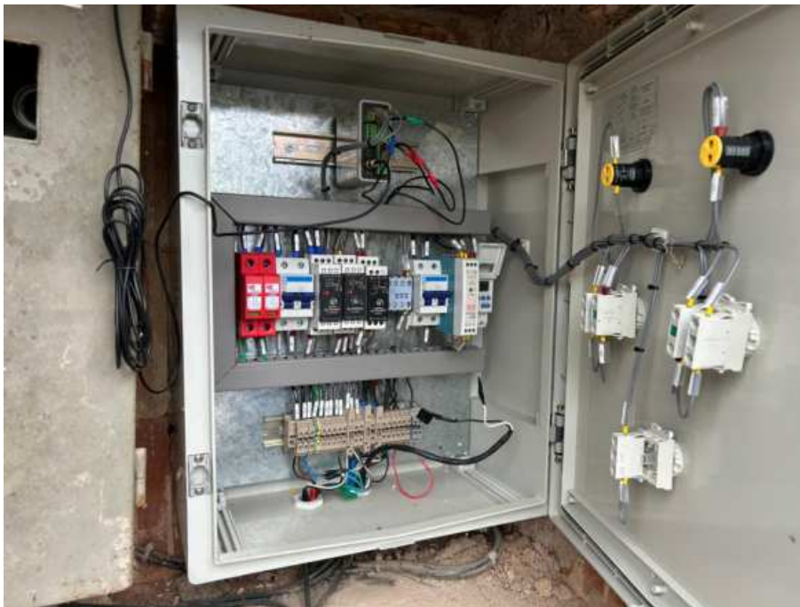
Foto 27 – Interior do painel de automação
