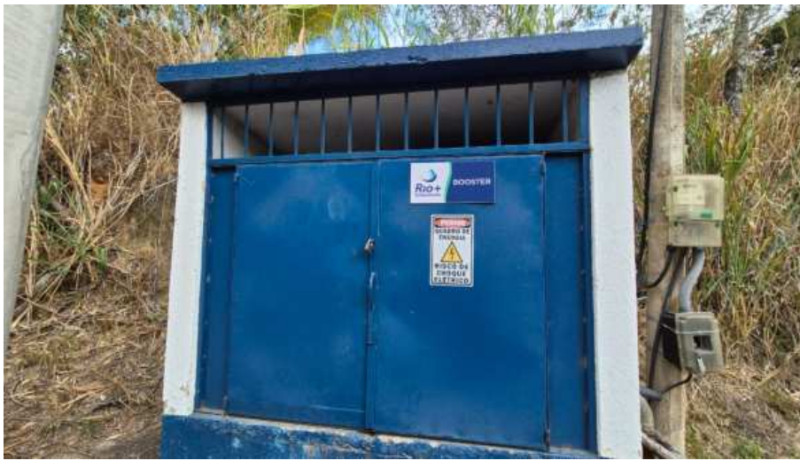
Foto 1 – Abrigo da EEAT com identificação
