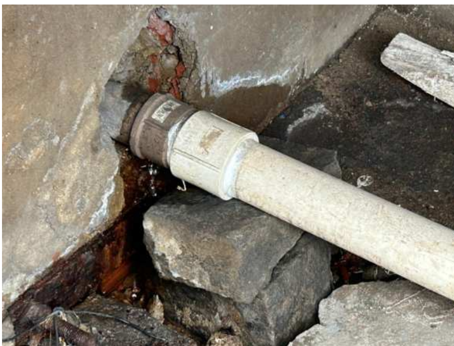
Foto 24 – Identificação de vazamento em conexão
