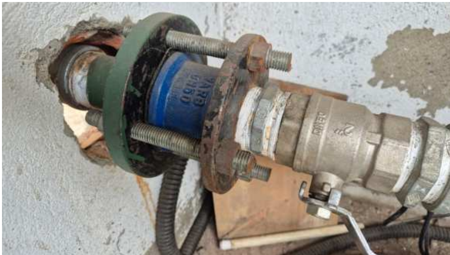
Foto 3 – Válvula de retenção
