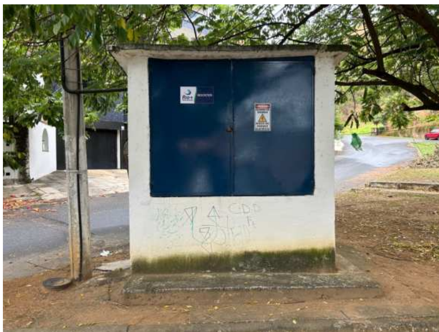
Foto 12 – Abrigo da EEAT com identificação
