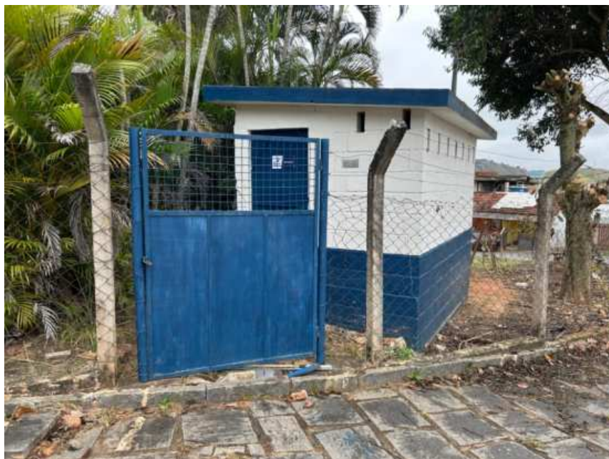
Foto 9 – Abrigo da EEAT com identificação
