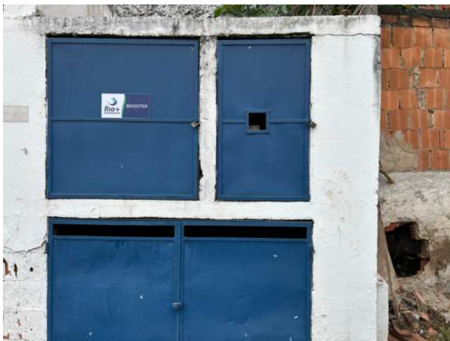
Foto 21 – Abrigo da EEAT com identificação
