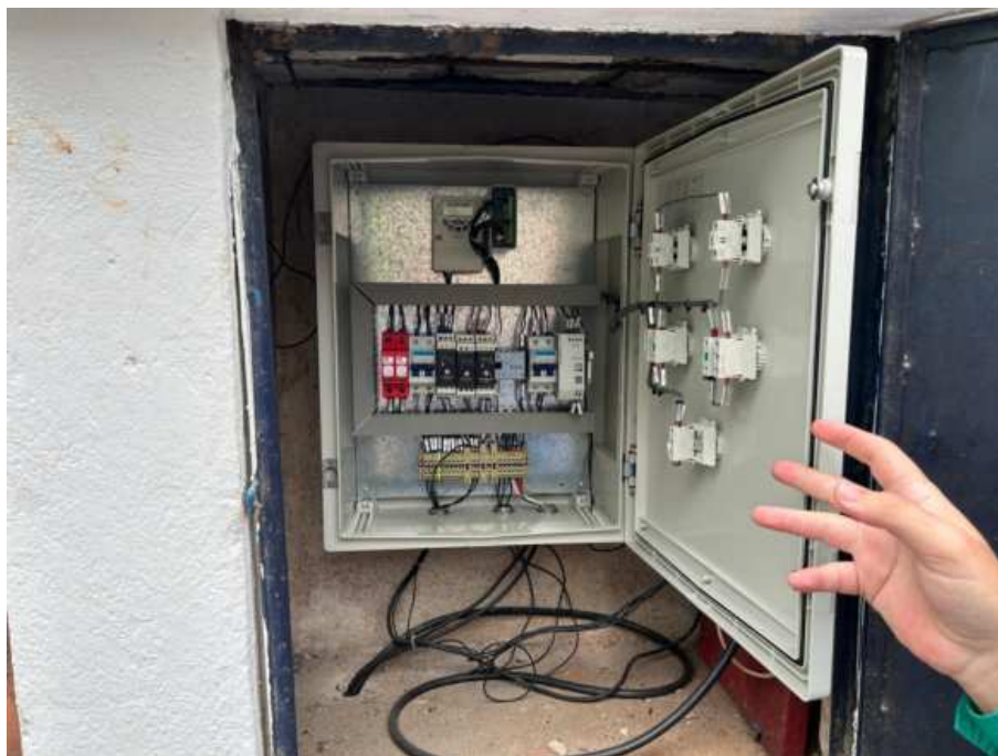
Foto 17 – Interior do painel de automação
