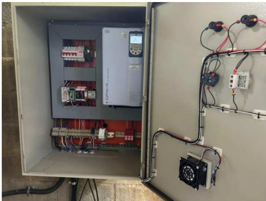
Foto 11 – Interior do painel de automação e visualização do inversor de frequência
