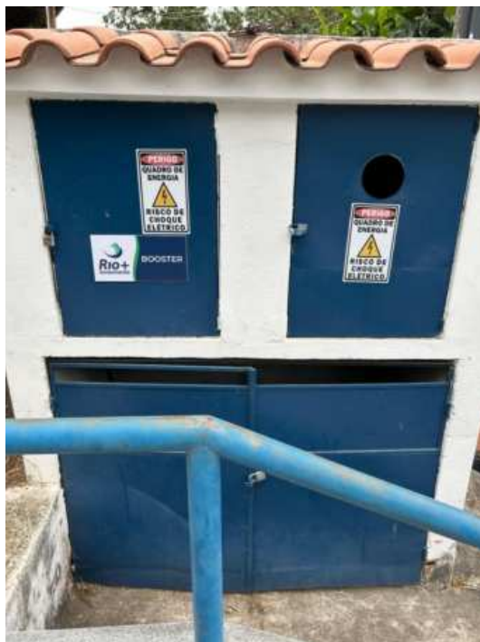
Foto 15 – Abrigo da EEAT com identificação
