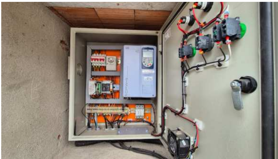
Foto 8 – Interior do painel de automação e visualização do inversor de frequência
