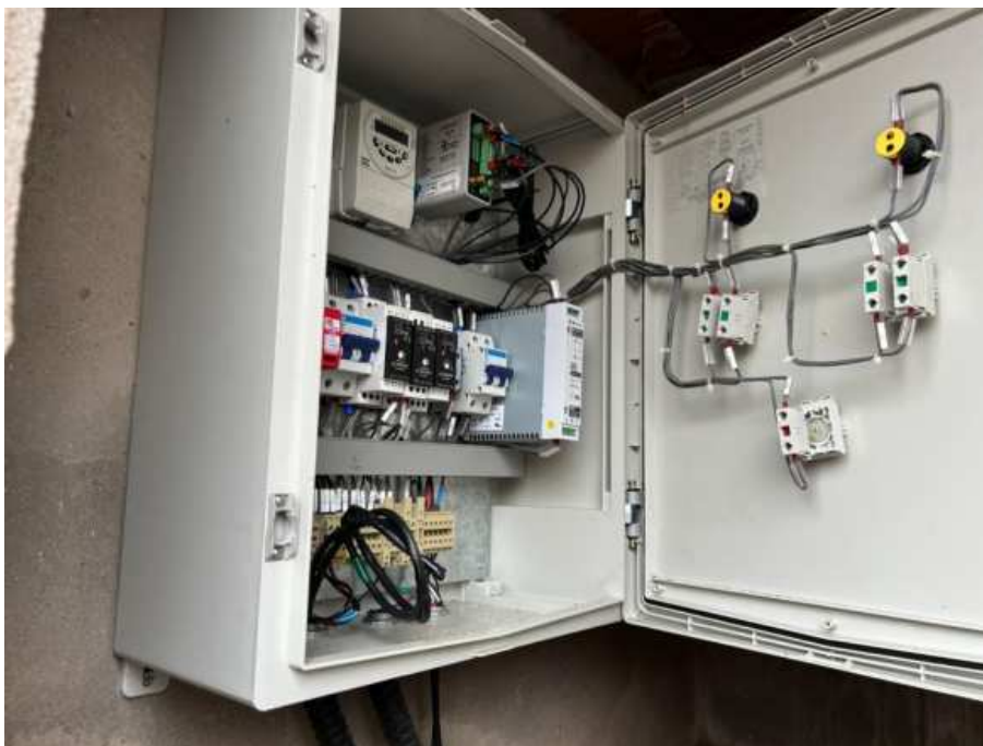
Foto 23 – Interior do painel de automação
