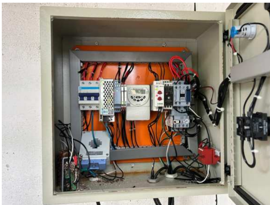
Foto 14 – Interior do painel de automação
