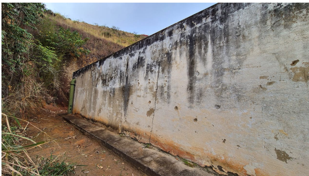
Foto 2 – Rachaduras presentes nas paredes e na base do reservatório
