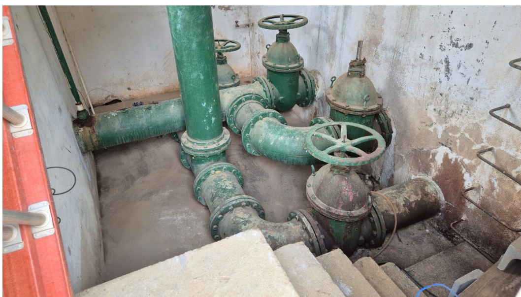
Foto 4 – Casa de válvulas
