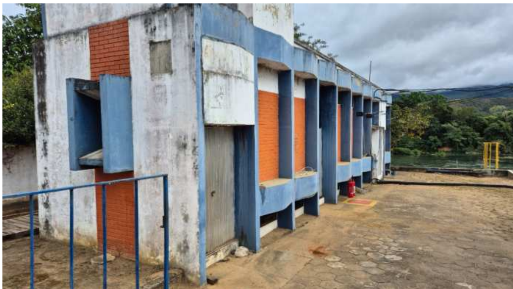
Foto 6 - Subestação elétrica da EEAB
