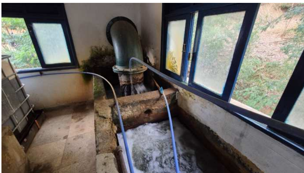
Foto 10 – Adutora de água bruta na ETA
