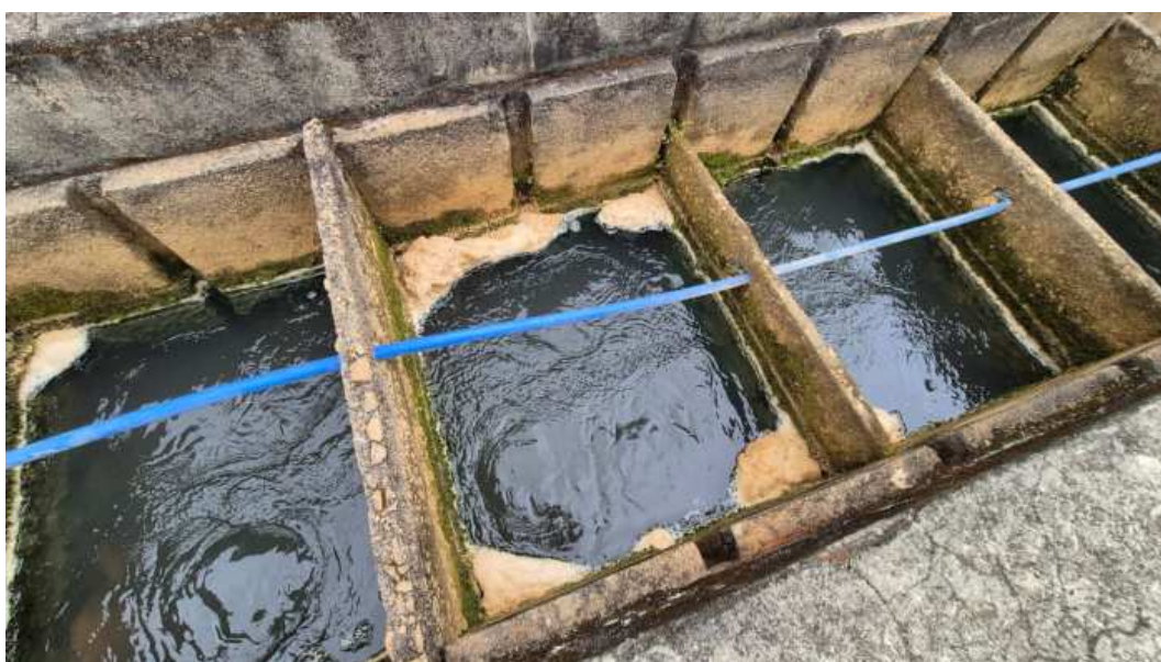
Foto 14 - Crescimento de vegetação observado nos floculadores
