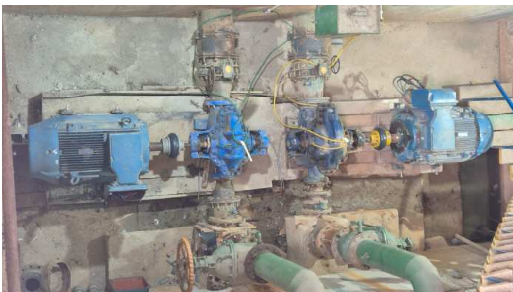
Foto 7 - Conjuntos motobombas da EEAB
