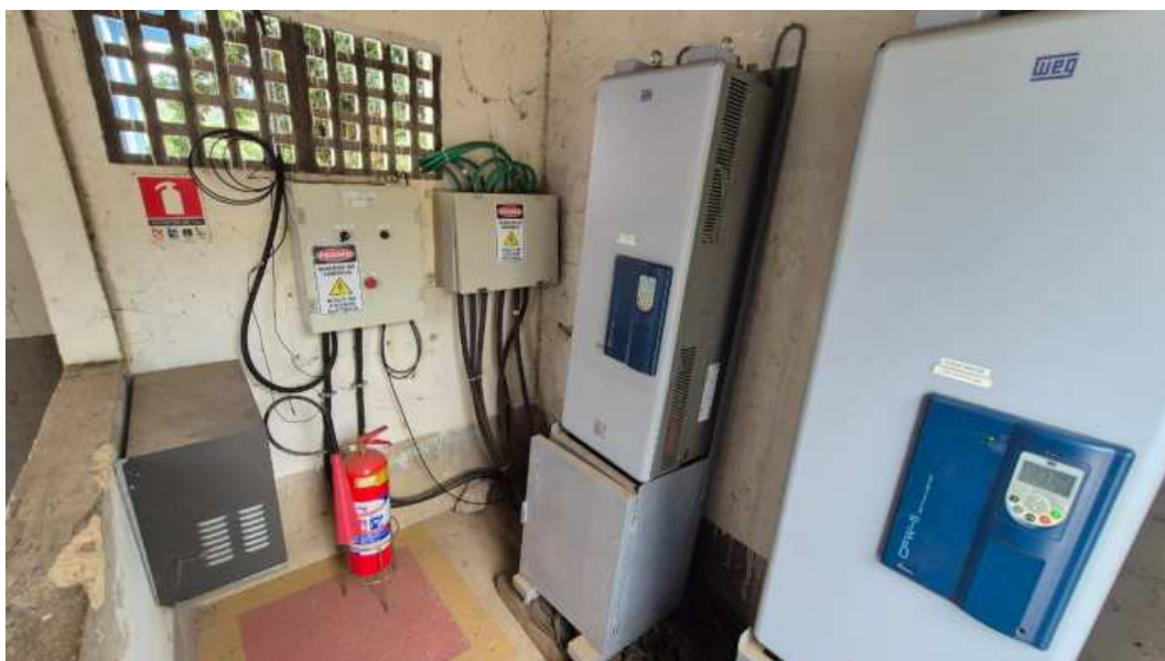
Foto 8 - Quadros de automação com sinalização de risco e inversores de frequência da unidade
