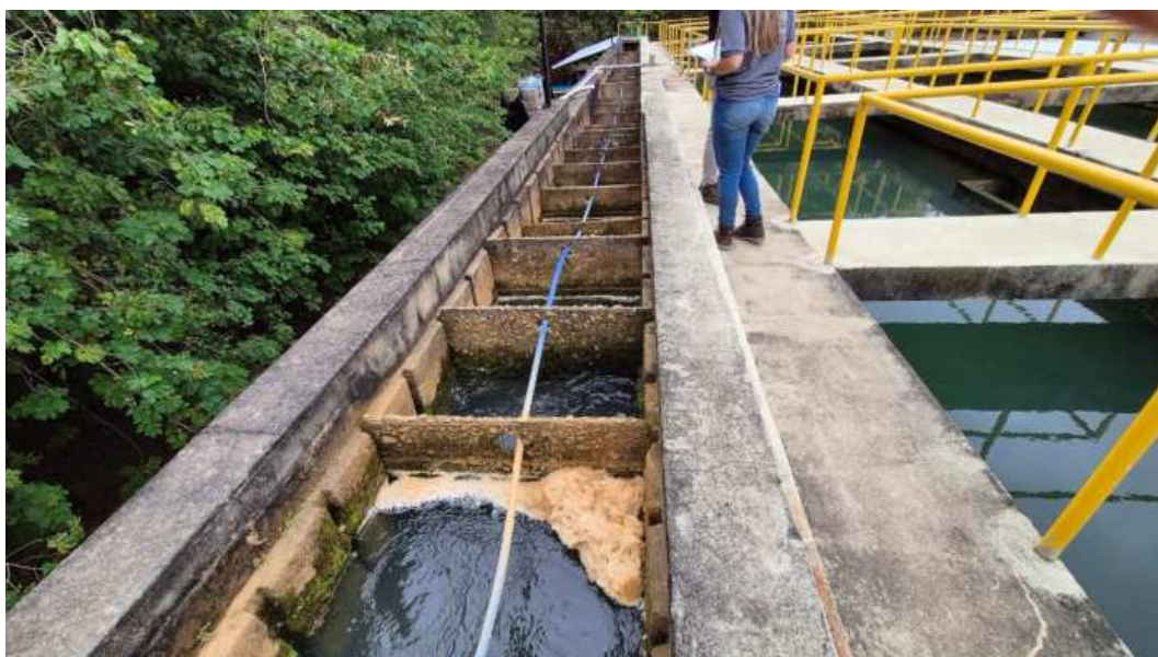
Foto 13 – Floculadores precisando de limpeza
