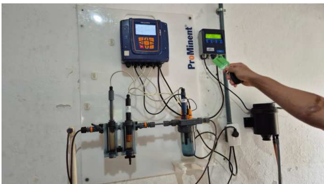
Foto 12 - Equipamentos de medição de turbidez e dosagem
