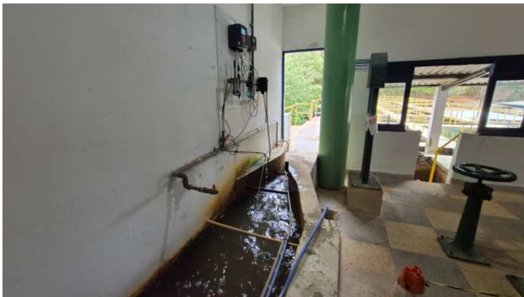
Foto 11 - Tanque de estabilização onde é feita a dosagem de coagulante
