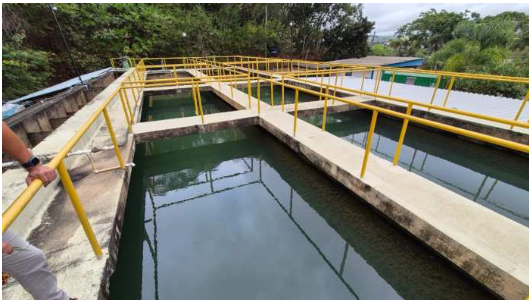
Foto 15 - Tanques de decantação
