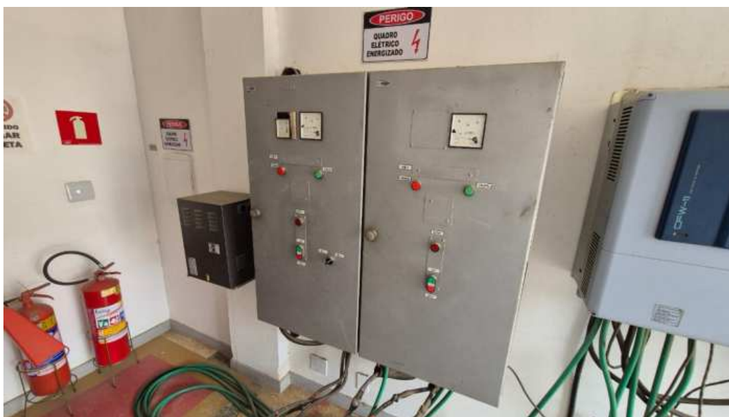
Foto 24 - PAINEL DE AUTOMAÇÃO DOS CONJUNTOS MOTOBOMBAS
