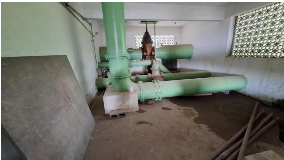
Foto 05 – Tubulações de saída
