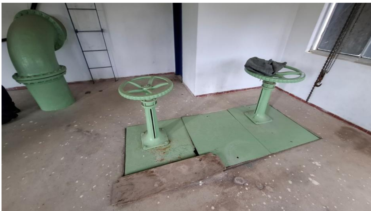
Foto 06 – Registros para operação
