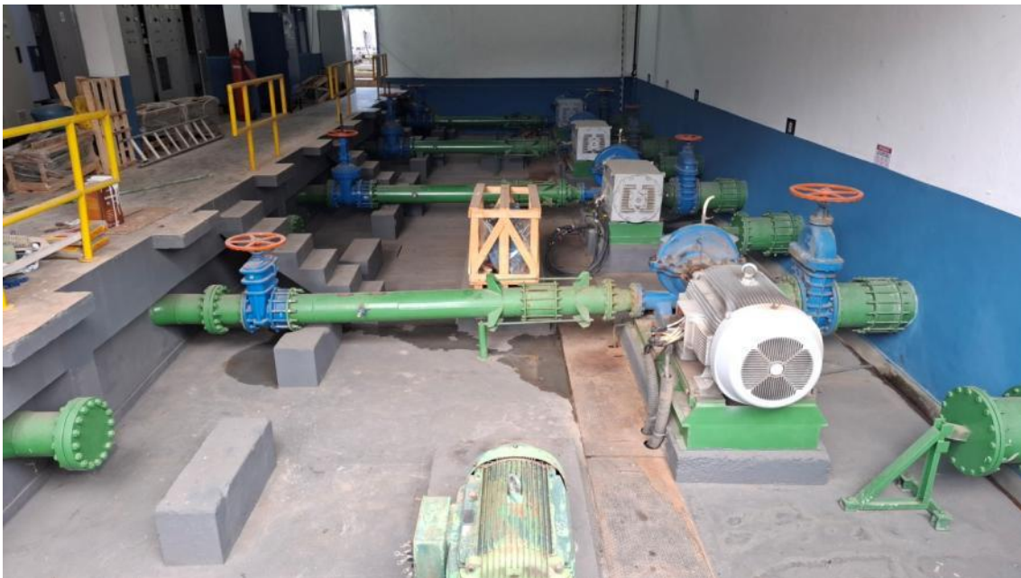
Foto 17 – Conjunto de bombas
