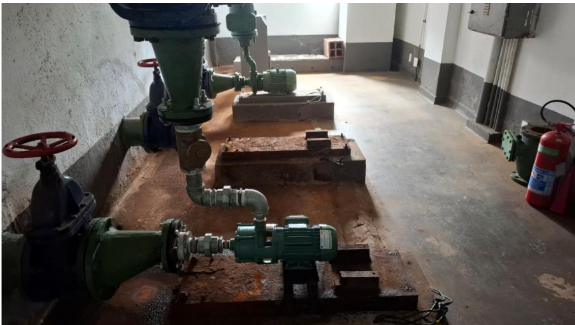
Foto 09 – Bombas de limpeza dos filtros foram adequadas
