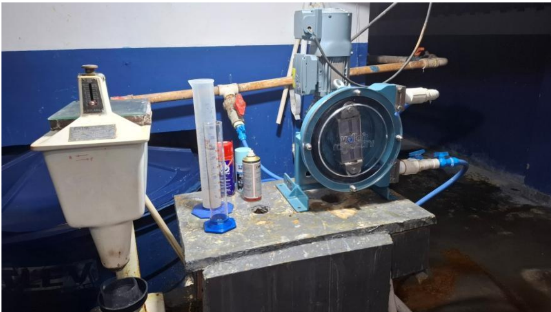
Foto 10 – Dosador de sulfato de alumínio
