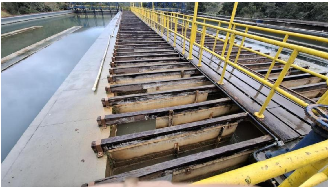
Foto 05 – Floculadores; passarela com piso de madeira exposta a intempéries, podendo causar apodrecimento
