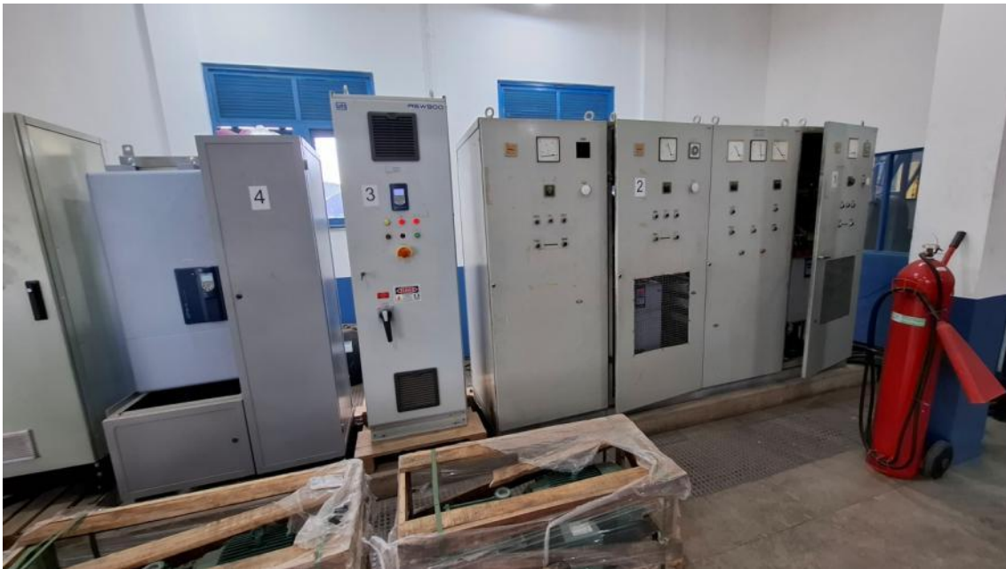
Foto 18 – Painelelétrico das bombas
