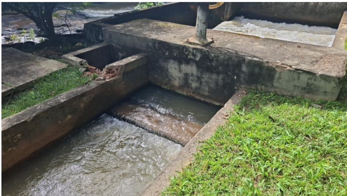
Foto 07 – Tanque de regulação da vazão
