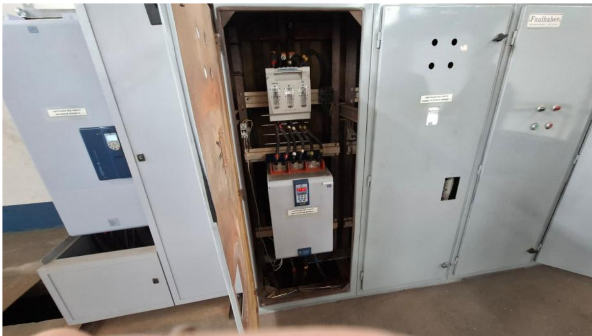
Foto 13 – Pannel elétrico; à esquerda, inversor de frequência de um motor; à direita, softstarter
