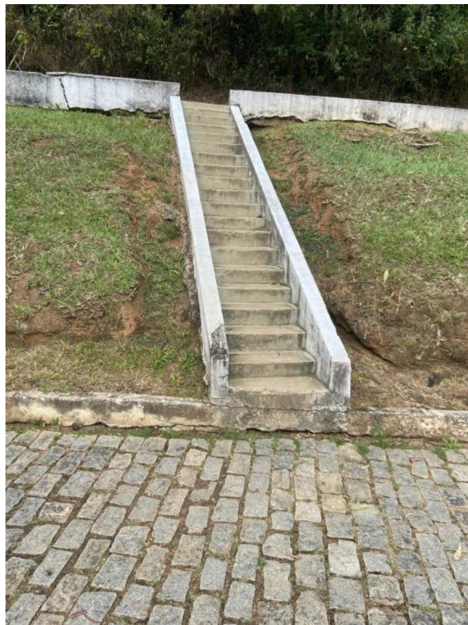
Foto 04 – Escada sem guarda-corpo
