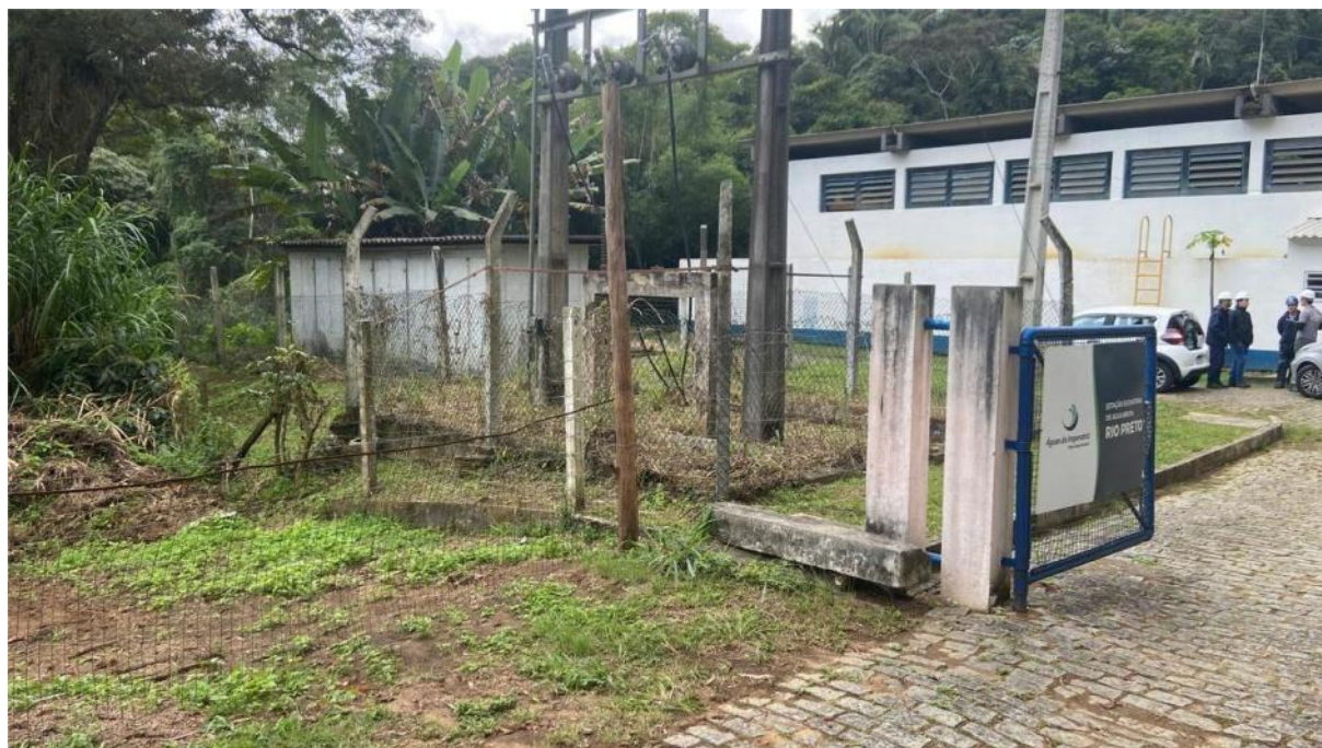
Foto 02 – Cerca não oferece muita proteção, necessitando de reformas
