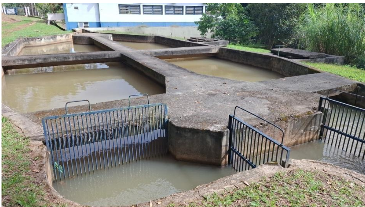
Foto 08 – Gradeamento e caixas de areia; pré-tratamento com duas linhas, possibilitando a manutenção sem interromper a unidade
