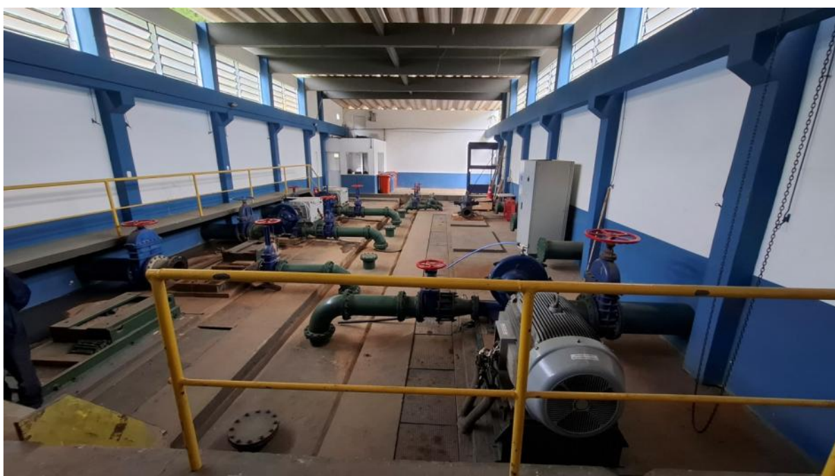
Foto 10 – Conjuntos moto-bomba no interior do abrigo
