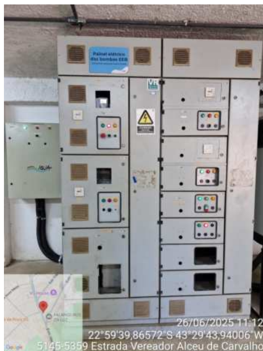
Foto 03 – Painel elétrico da EEB
