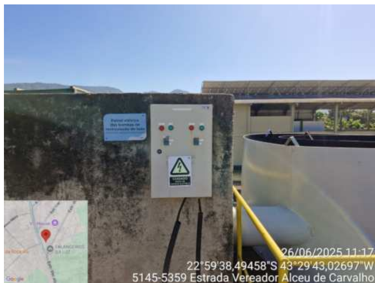
Foto 13 – painel elétrico das bombas submersíveis de recirculação
