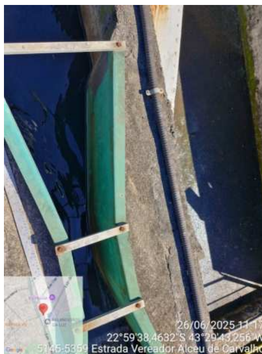
Foto 05 – Calha Parshall de entrada
