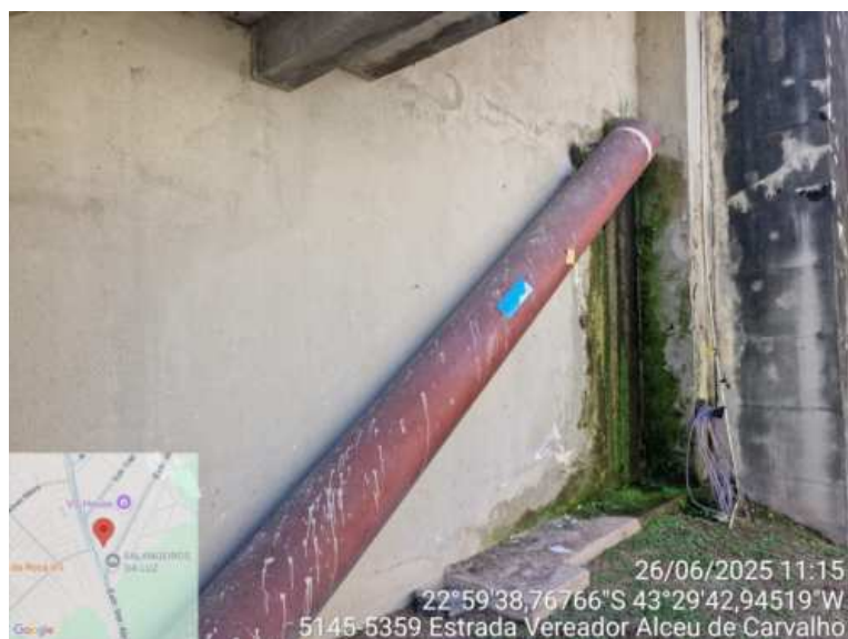
Foto 20 – tubulação de saída do efluente tratado
