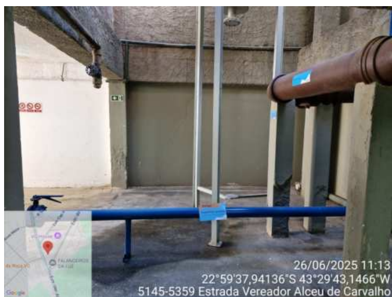
Foto 09 – tubulação do aerador
