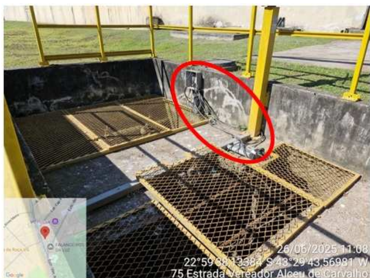
Foto 02 – Poço de sucção
