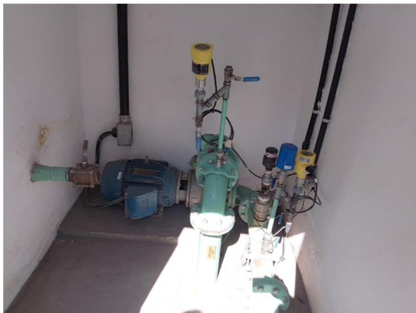
Foto 1 – Interior do abrigo da elevatória
