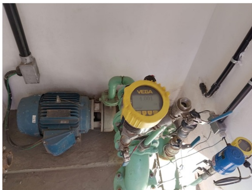
Foto 8 – Equipamentos elétricos em bom estado
