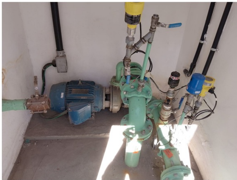
Foto 10 – Tubulações não providas de válvulas
