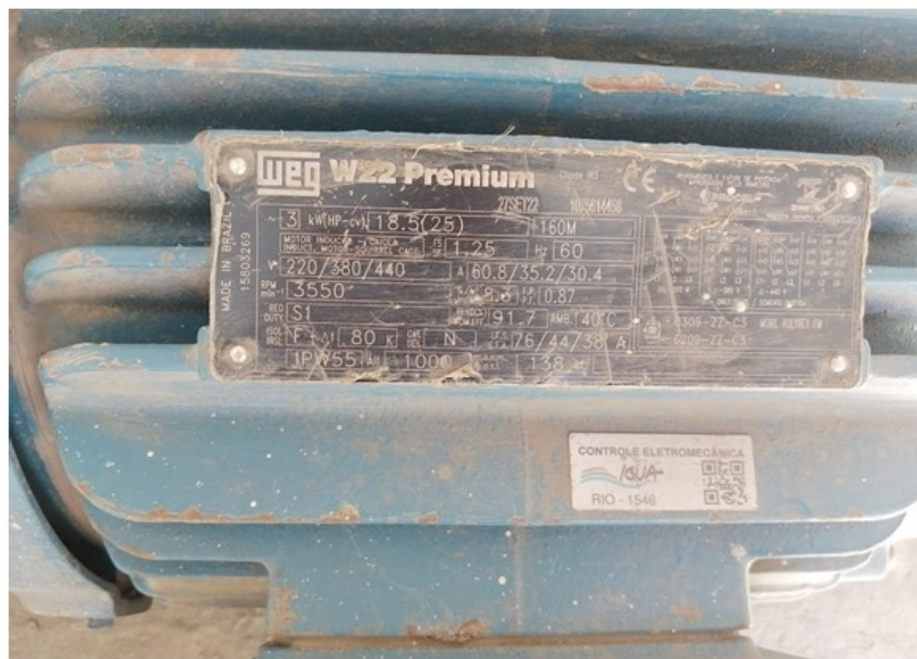
Foto 9 – Plaqueta das informações elétricas da motobomba
