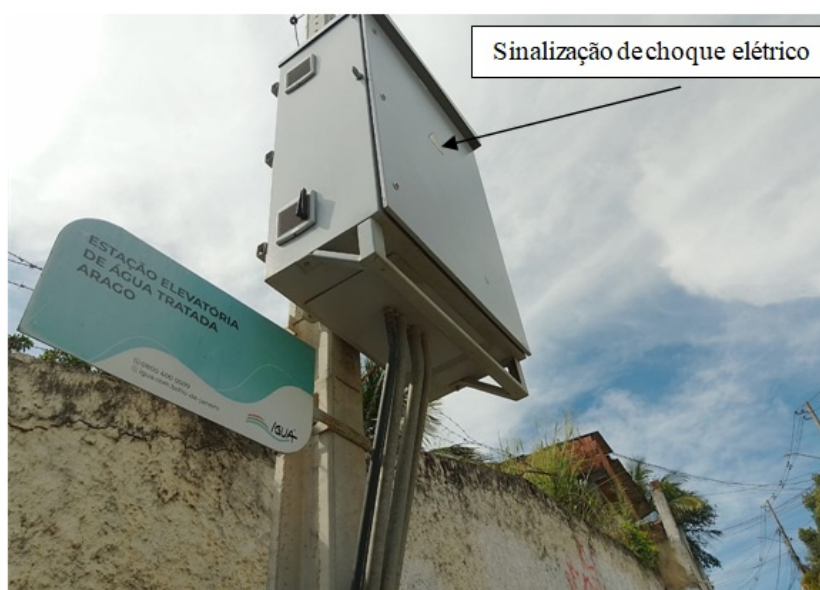
Foto 2 – Sinalização de choque elétrico
