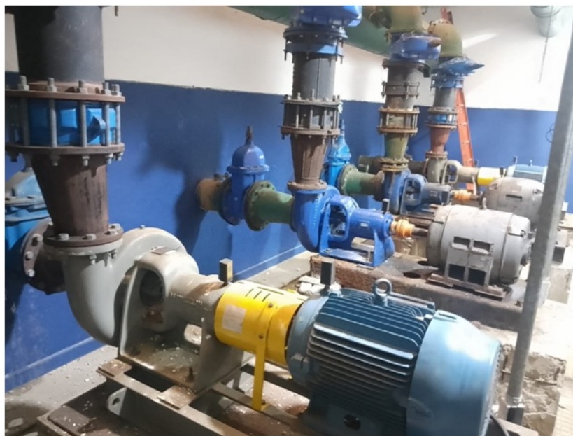
Foto 5 – Tubulações de sucção e recalque, válvulas de retenção e válvulas de fechamento
