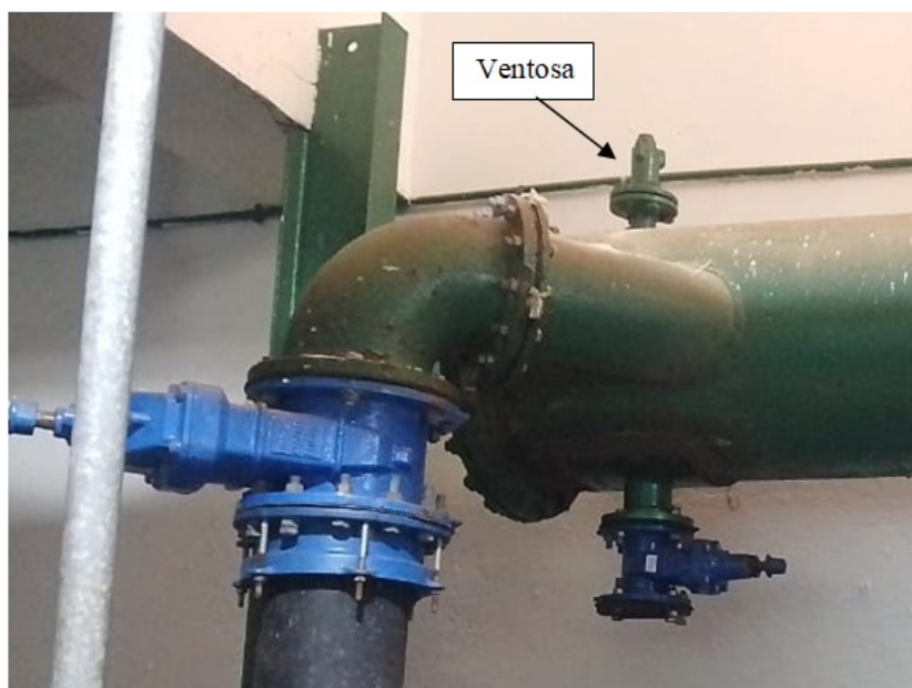
Foto 10 – Ventosa na tubulação DN 600 mm
