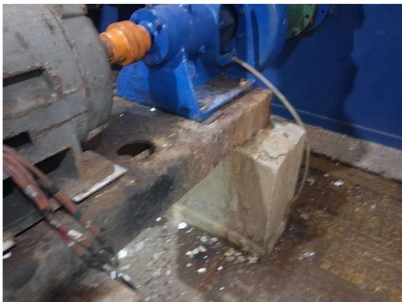
Foto 13 – Vazamento de água
