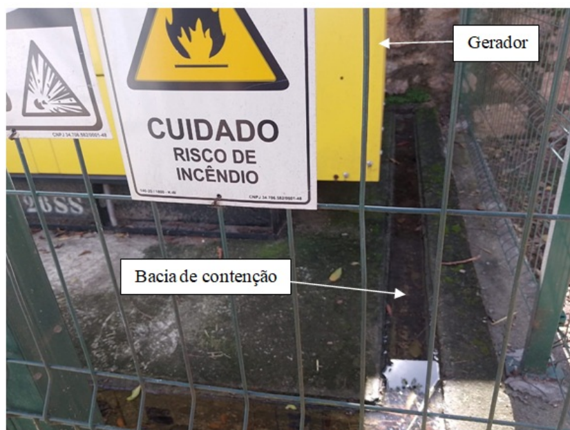
Foto 3 – Gerador e bacia de contenção
