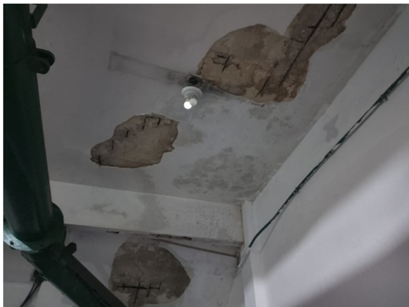
Foto 1 – Ferragens aparentes e infiltração na laje superior
