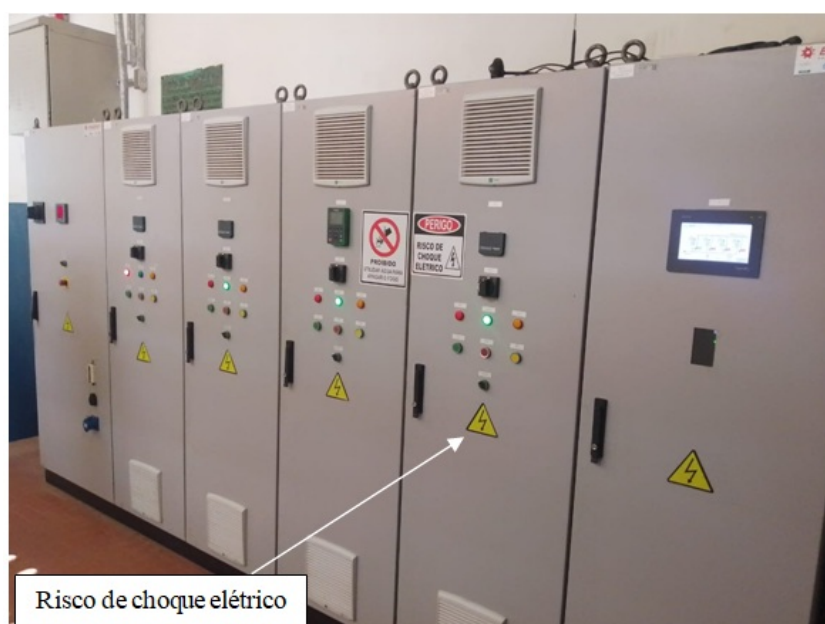
Foto 16 – Painéis elétricos dos grupos de motobombas com sinalização de risco de choque elétrico
