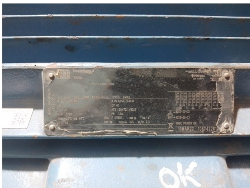
Foto 12 – Plaqueta com informações elétricas da motobomba
