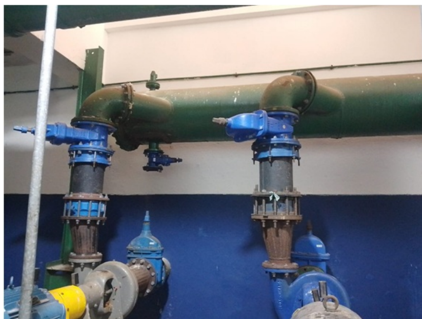
Foto 6 – Tubulações de sucção e recalque, válvulas de retenção e válvulas de fechamento
