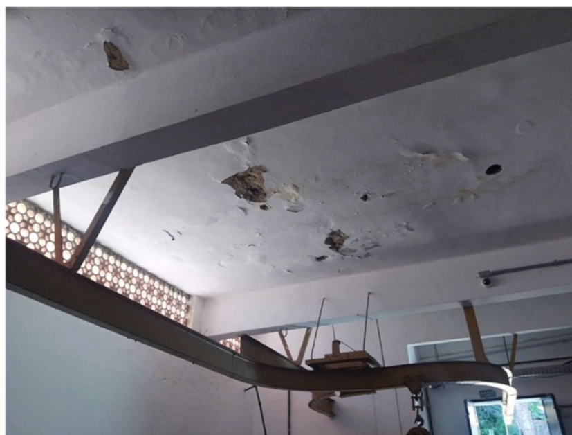
Foto 2 – Infiltrações na laje superior
