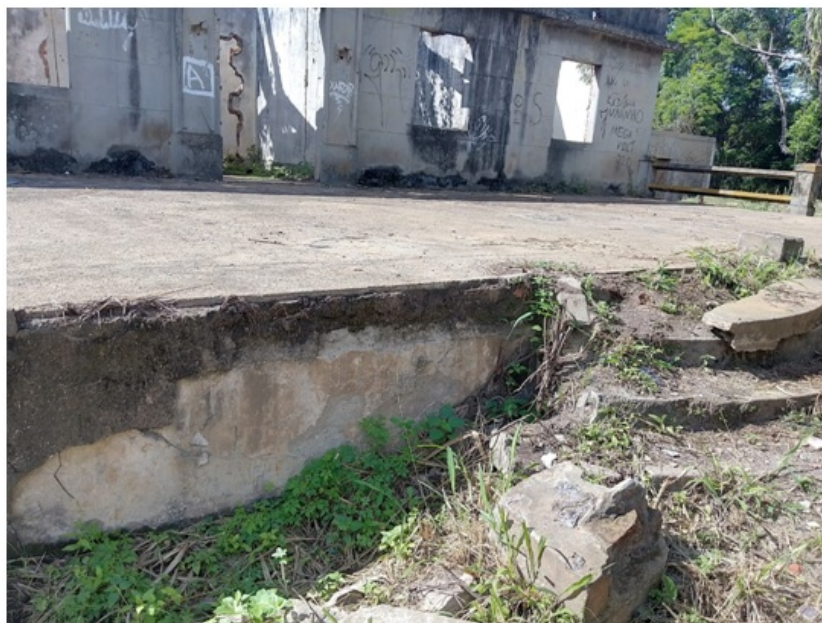
Foto 1 – Entrada do reservatório sem nenhuma proteção
