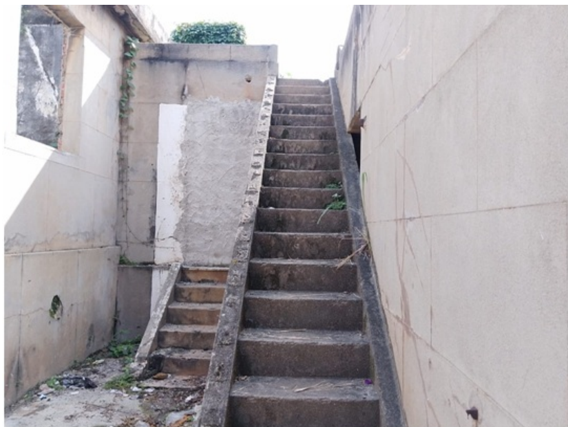
Foto 10 – Escada externa sem guarda corpo
