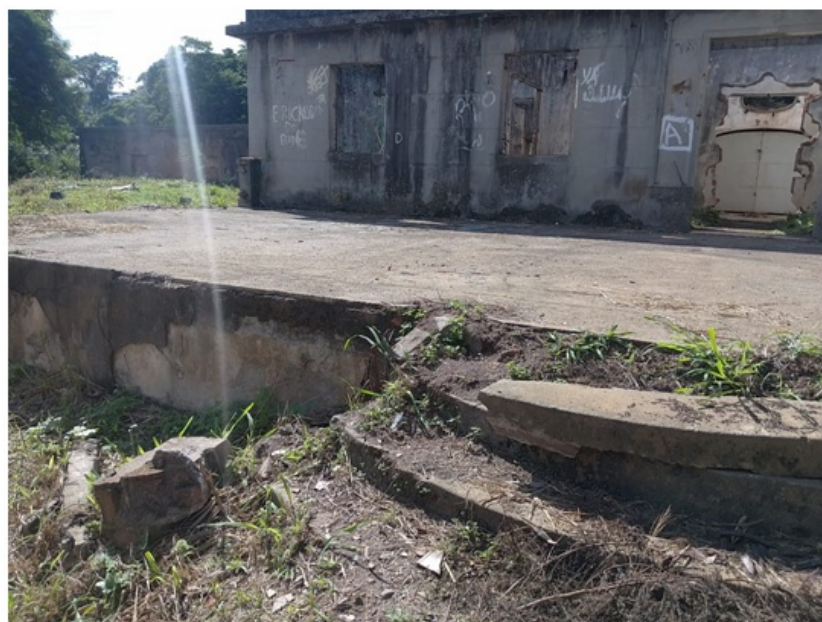
Foto 2 – Entrada do reservatório sem nenhuma proteção
