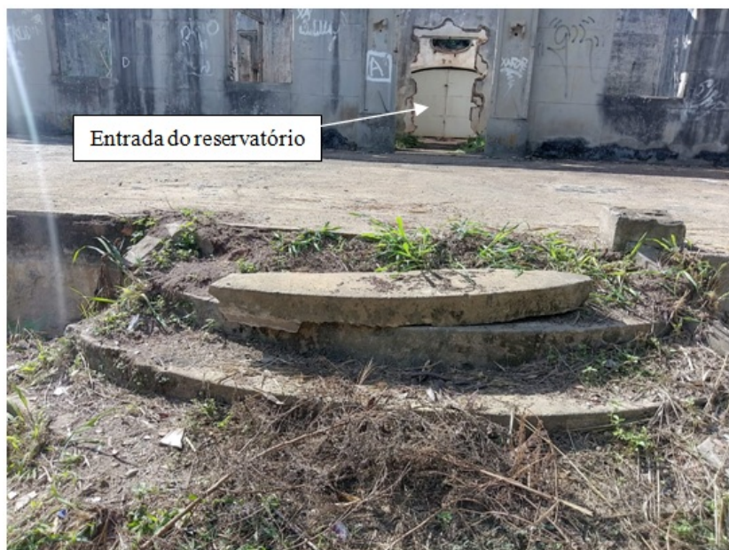
Foto 7 – Escada e edificação destruída
