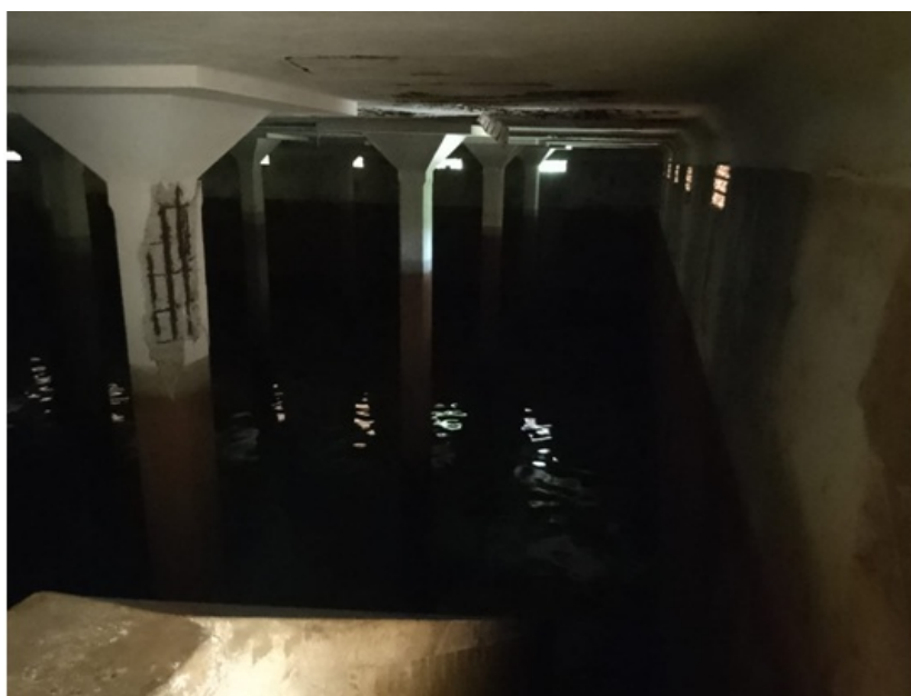
Foto 16 – Ferragens aparentes no pilar
