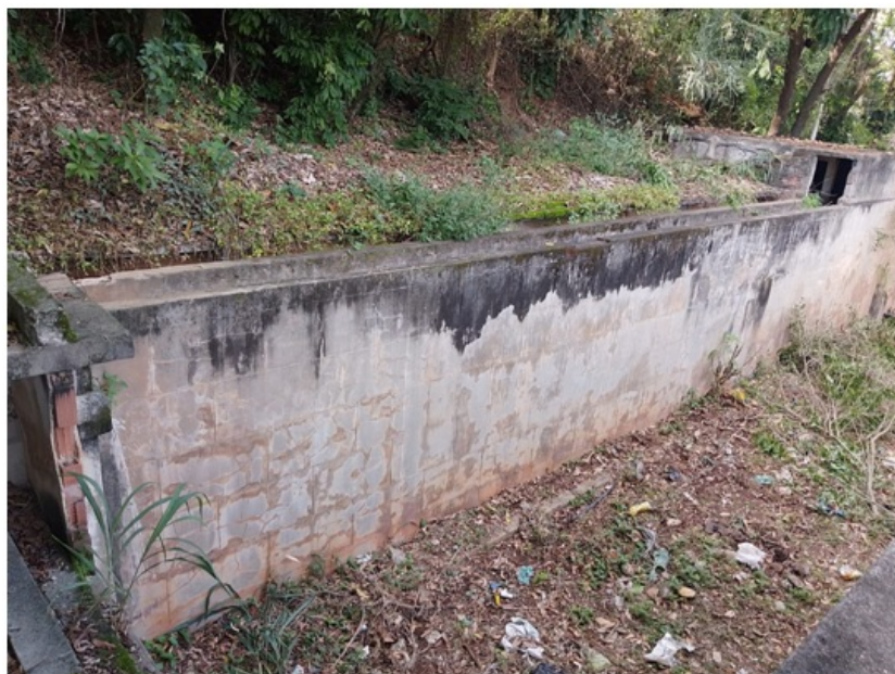
Foto 3 – Fundos do reservatório sem nenhuma proteção
