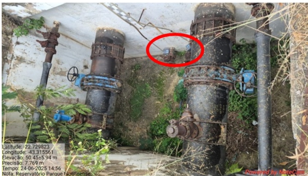
Foto 6: Barrilete de distribuição com dataloggers
