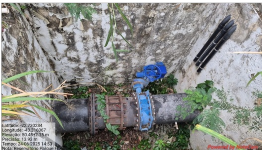
Foto 8: Barrilete de distribuição
