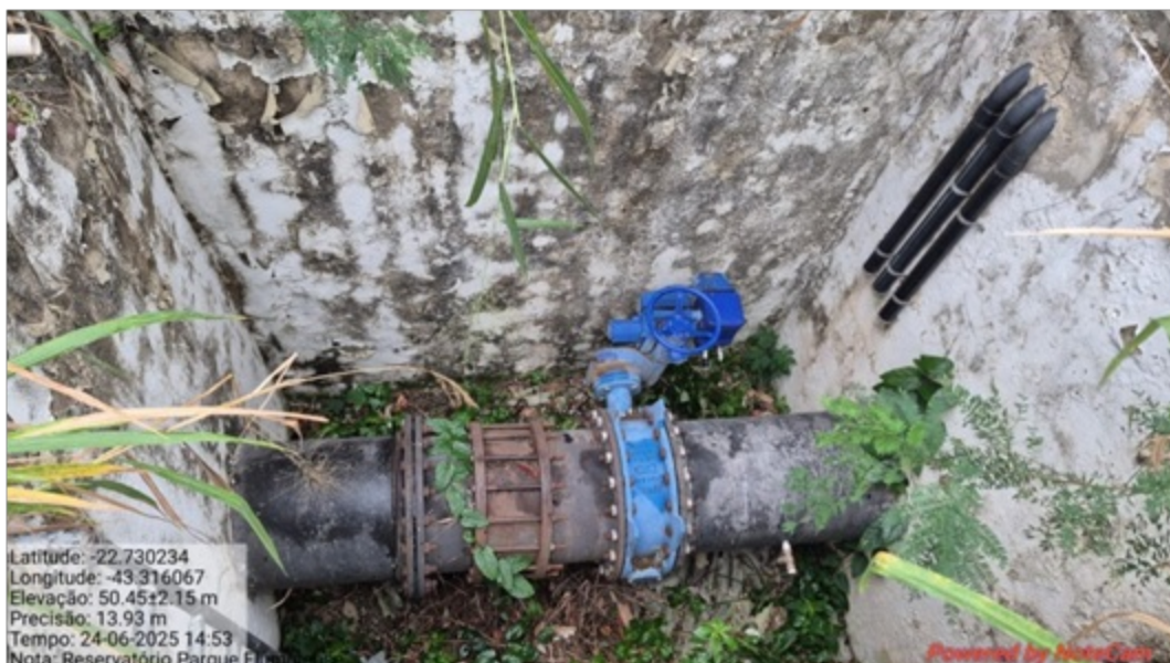
Foto 11: Barrilete de distribuição
