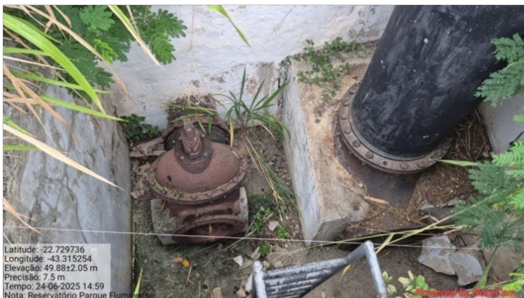
Foto 10: Tubulação extravassora e fundo
