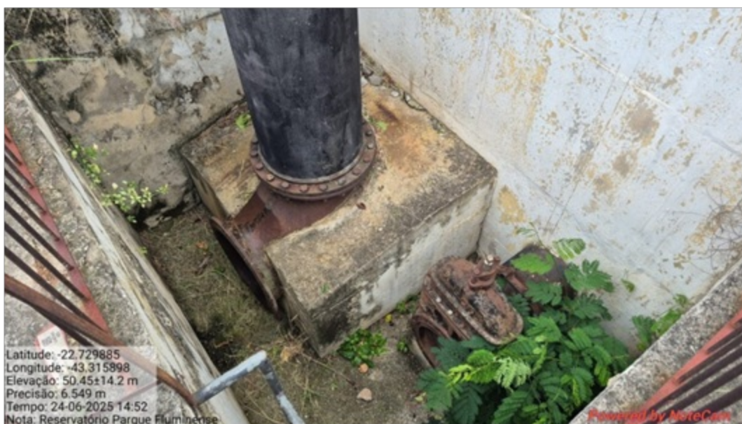
Foto 9: Tubulação extravassora e fundo
