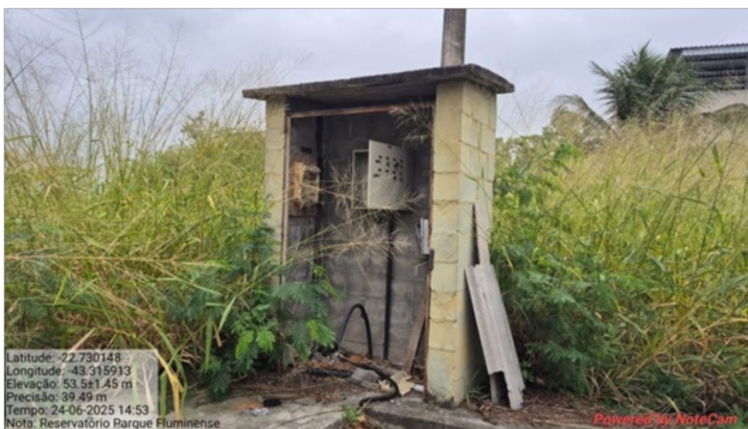
Foto 14: Abrigo para painel de comando inutilizado
