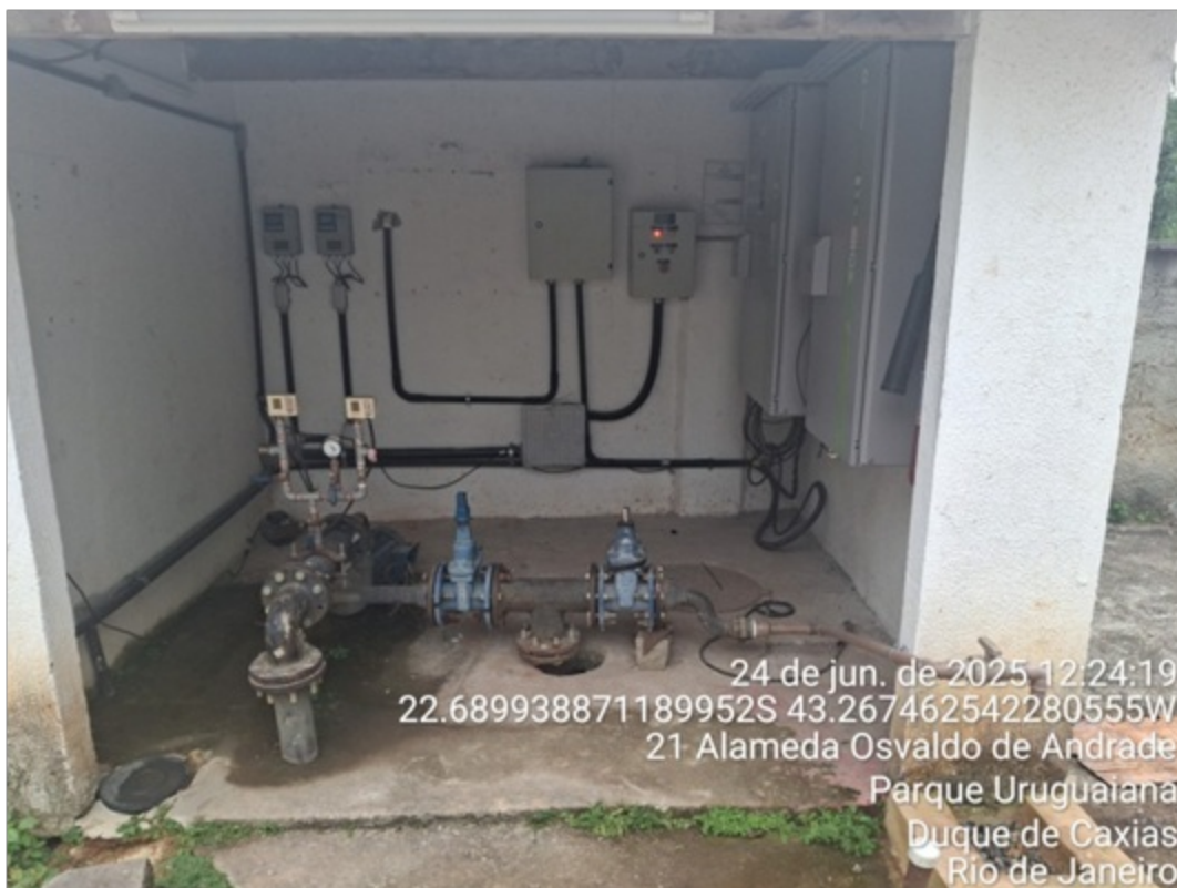
Foto14: Abrigo painéis e elevatória para abastecimento da região
