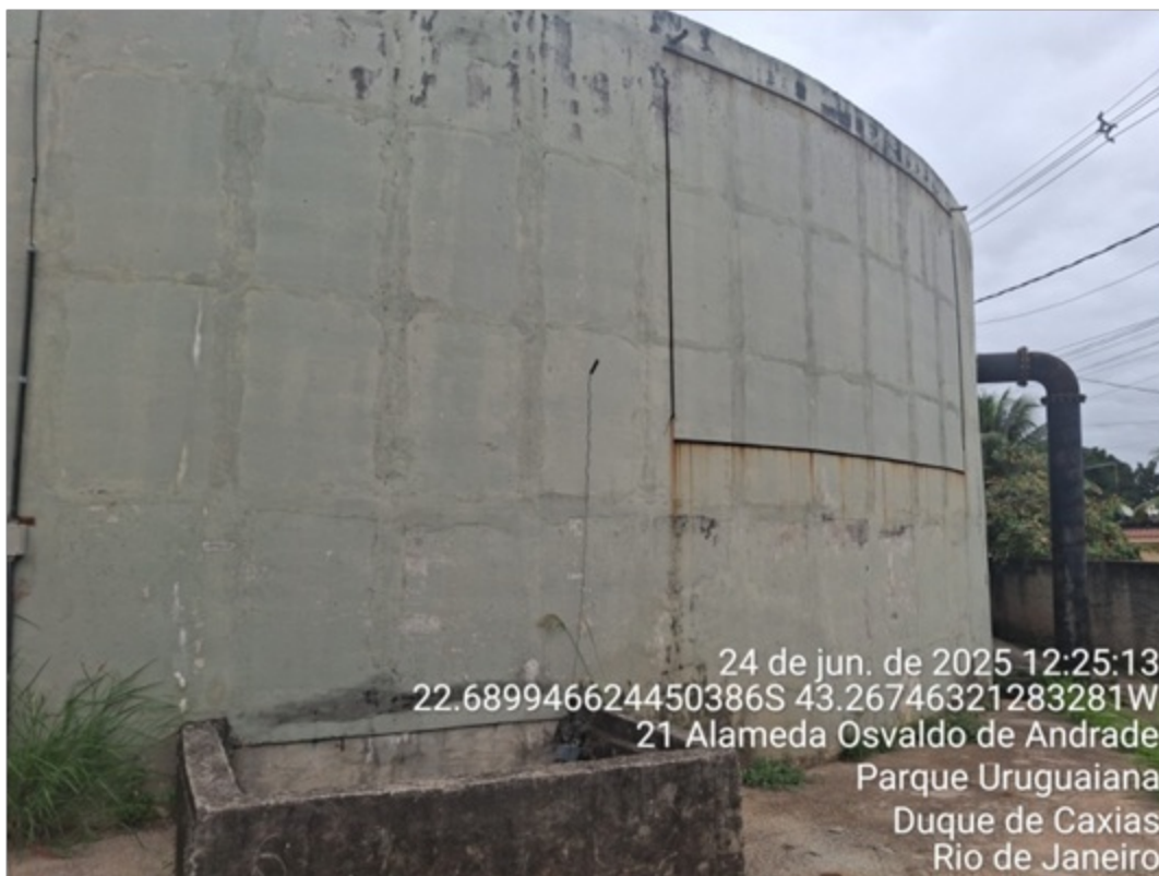
Foto 7: Tubulação extravassor ao fundo
