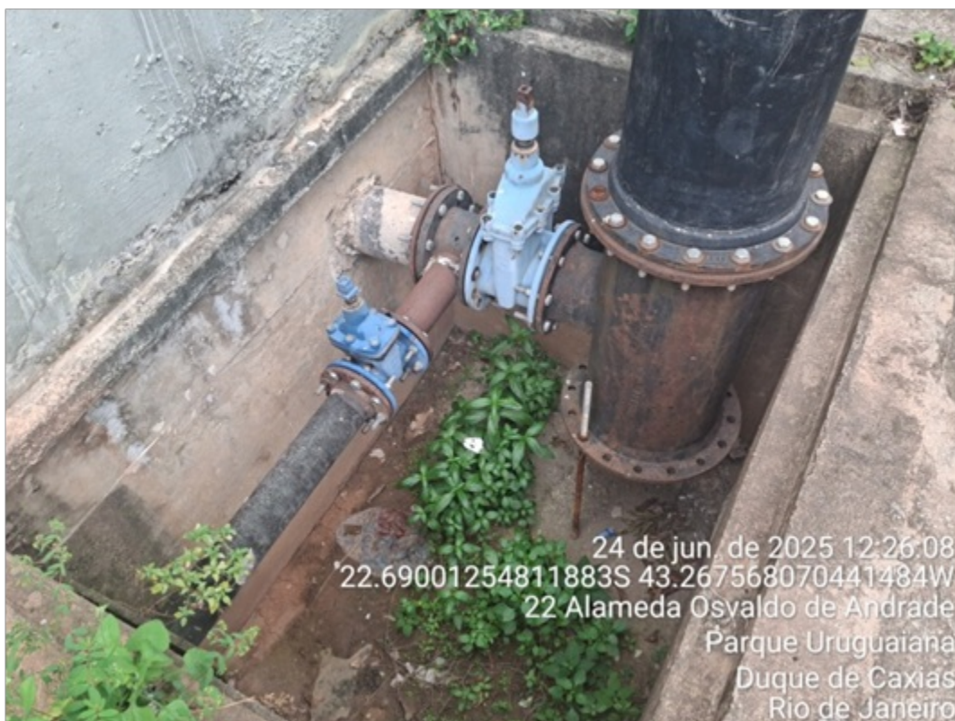
Foto 8: Válvula extravassor com By-pass
