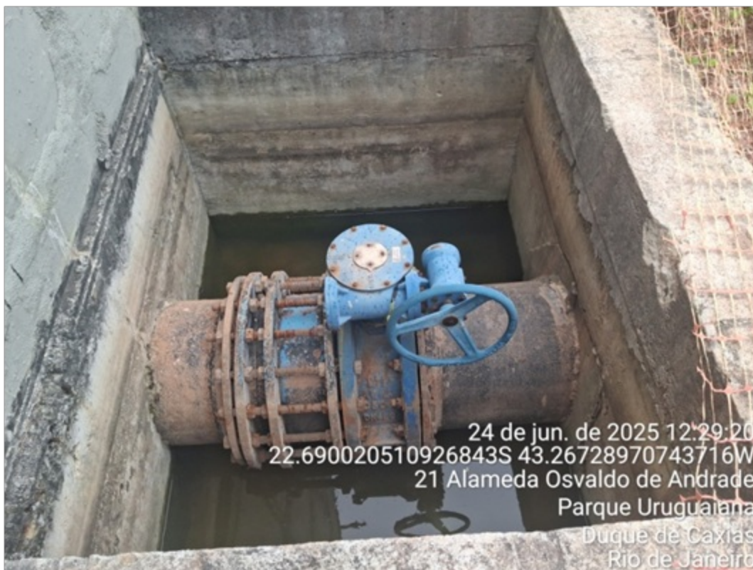
Foto 9: Barrilete de chegada
