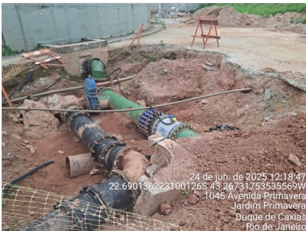
Foto 12: Macromedidor instalado pela concessionária
