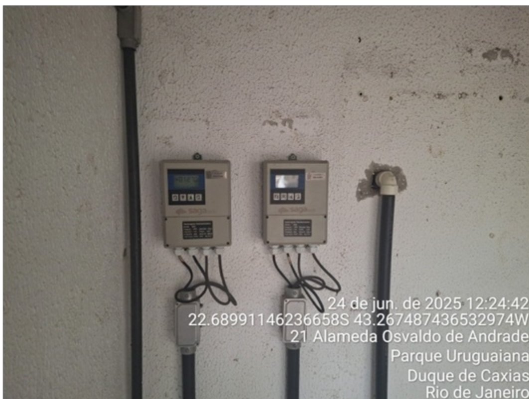
Foto15: Medidores de vazão
