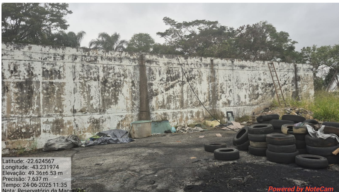
Foto 3. Reservatório com pneus e entulho no entorno
