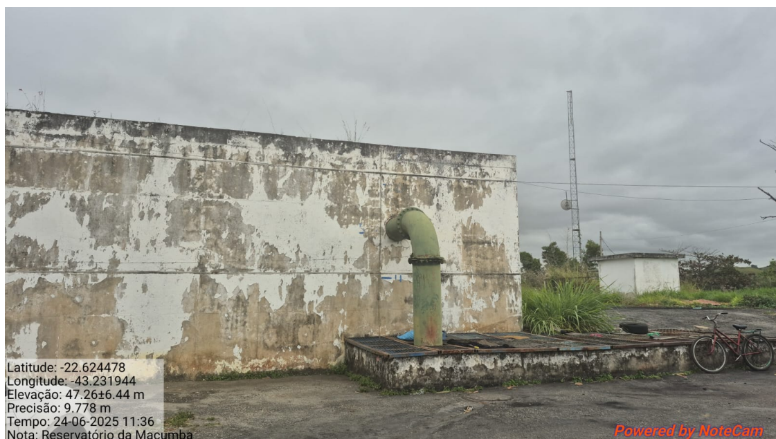
Foto 1. Reservatório sem cercamento e isolamento, com pintura precária
