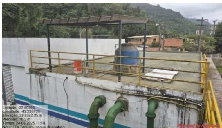
Foto 13. Tanque de contato
