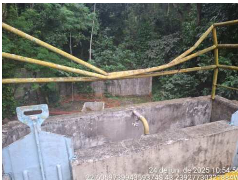
Foto 11. Guarda corpo danificado
