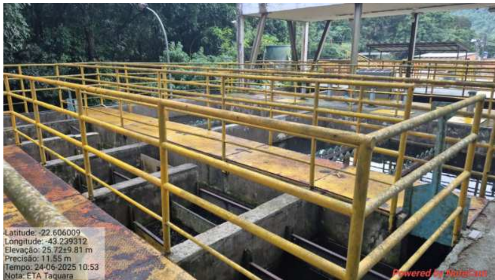
Foto 2. Etapa de floculação da ETA nova
