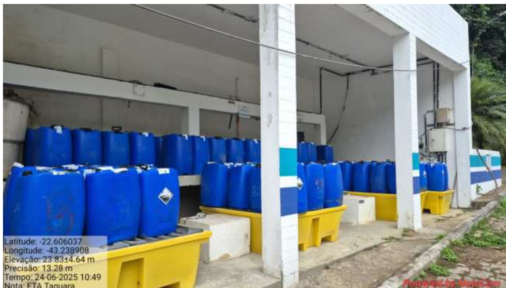
Foto 9. Bombonas de flúor
