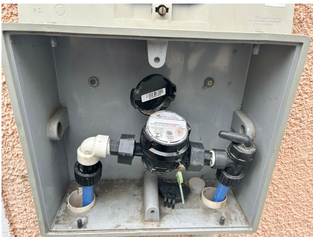
Foto 3 - Hidrômetro do imóvel
