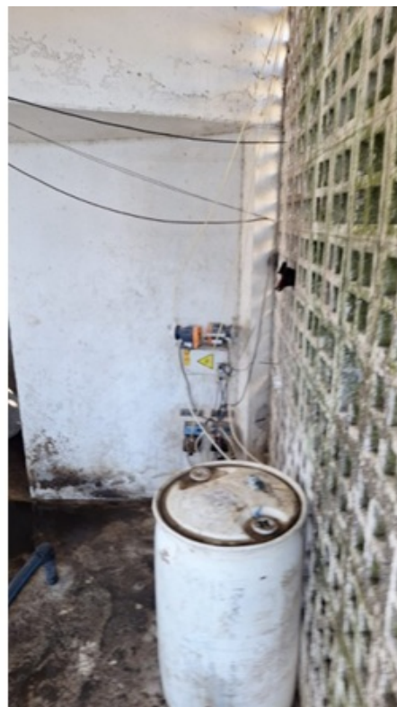
Fotos 16 e 17 – Depósito de hipoclorito de sódio; e dosador para desinfecção com bombona sem baia de contenção. Instalações elétricas e tubulações do produto penduradas como um varal.
