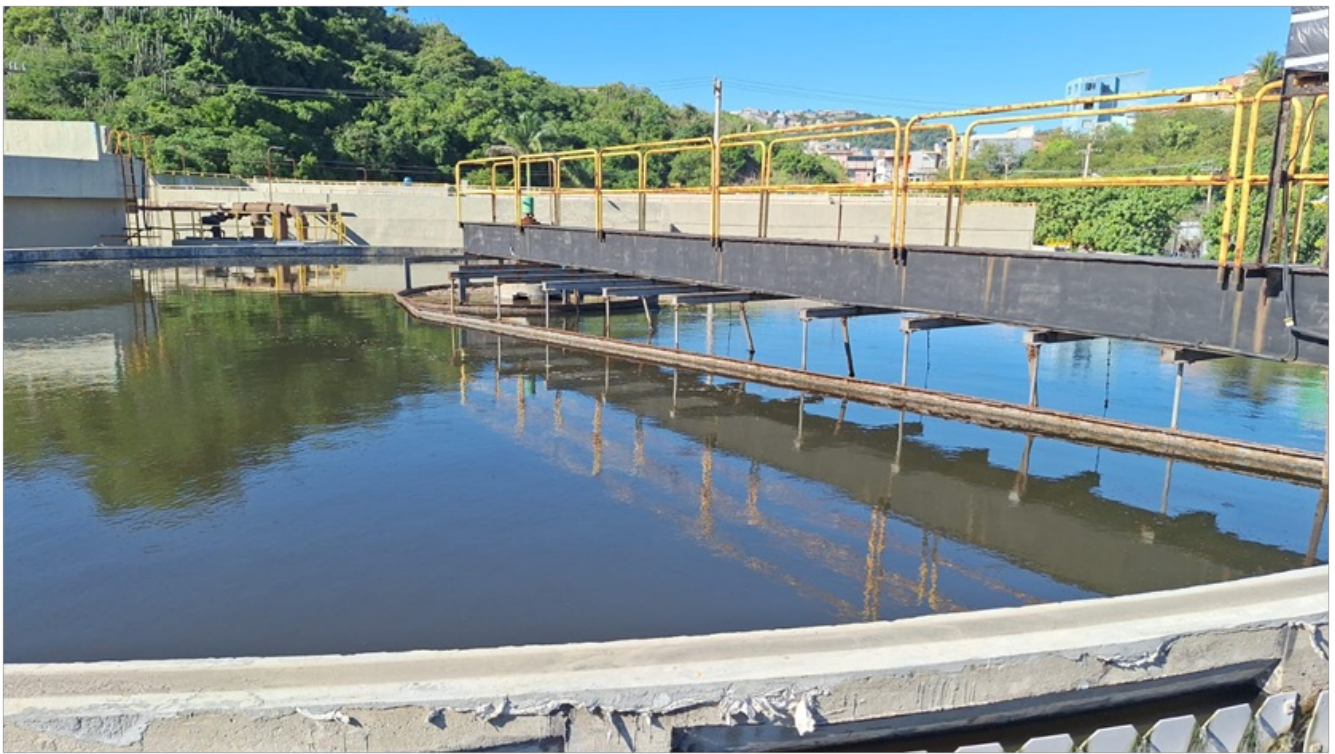
Foto 14 – Decantador Secundário ( único ), com partes já bem oxidadas.
