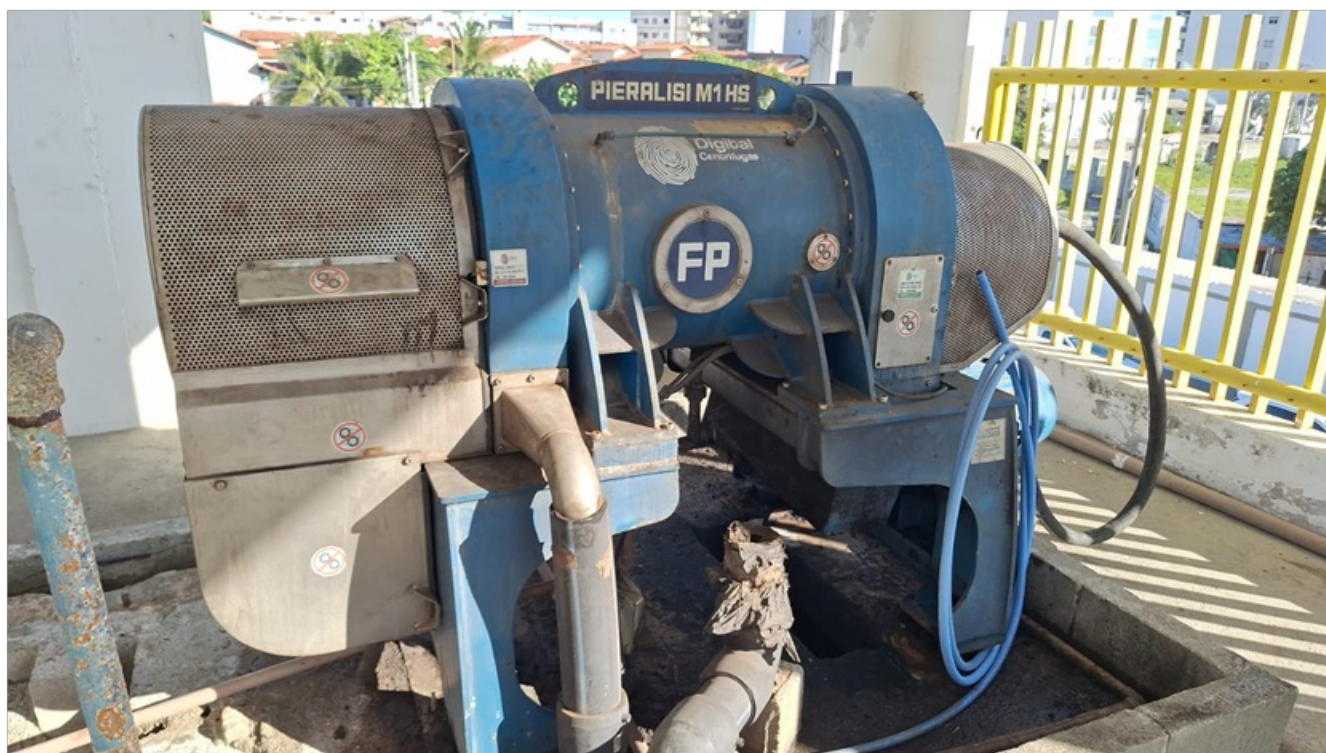
Foto 18 – Centrífuga, que estava em operação apesar do pouco volume de lodo gerado pela baixa vazão e pela recirculação. O lodo recebe dosagem de polímero para otimizar a coagulação.
