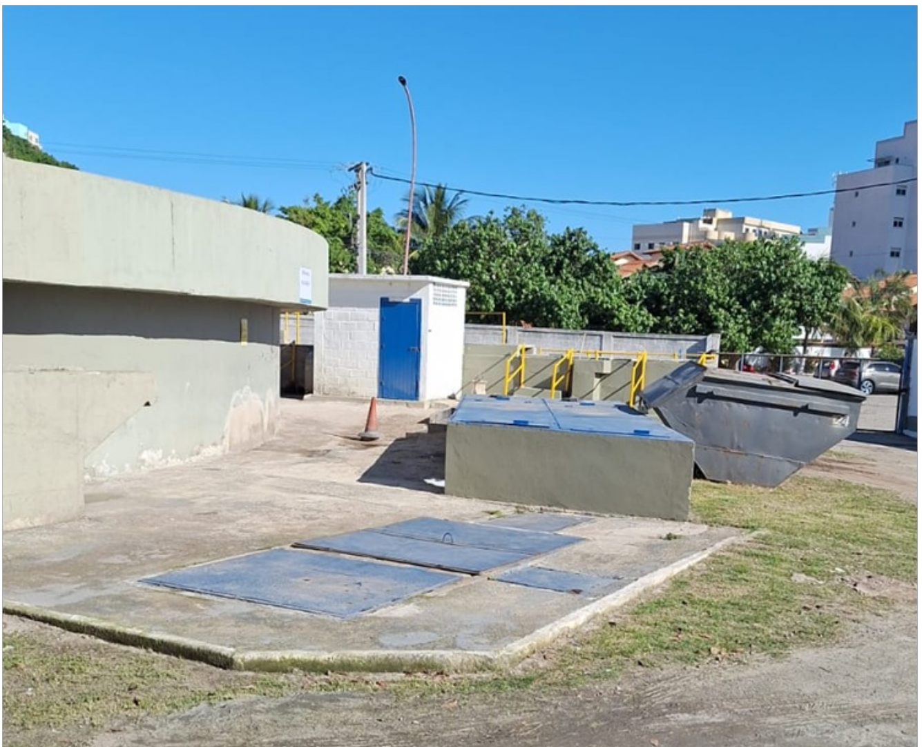
Foto 15 – Elevatória de recirculação do lodo do decantador e da fase líquida do lodo da centrífuga.
