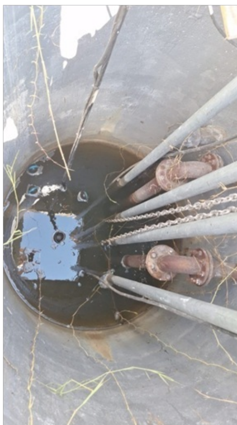
Foto 5 – Poço da EEE com tubulações para duas bombas. .
