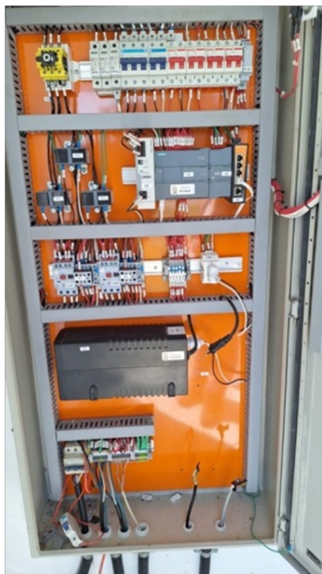
Foto 4 – Quadro com telemetria, e acionamento manual.
