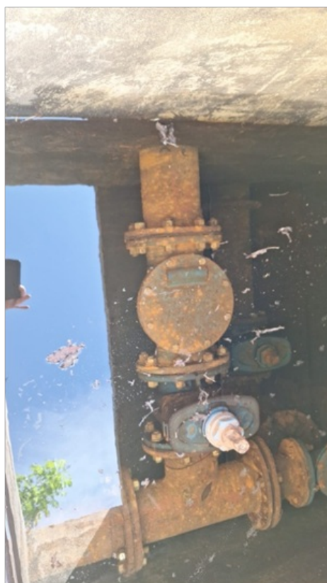
Fotos 7 – Caixa do barrilete cheia, necessitando de drenagem.
