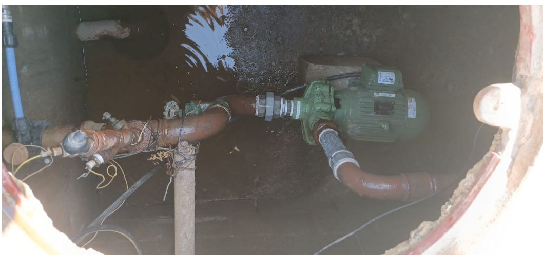
Foto 3 - Visualização da motobomba no interior do abrigo
