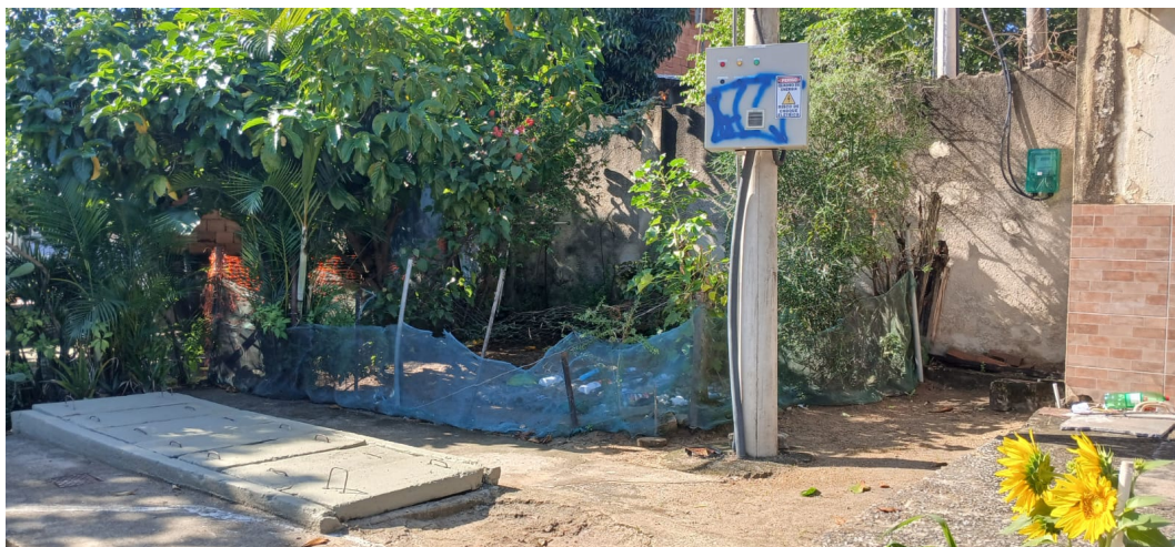
Foto 1 - EEAT Jardim Luana sem identificação da Concessionária
