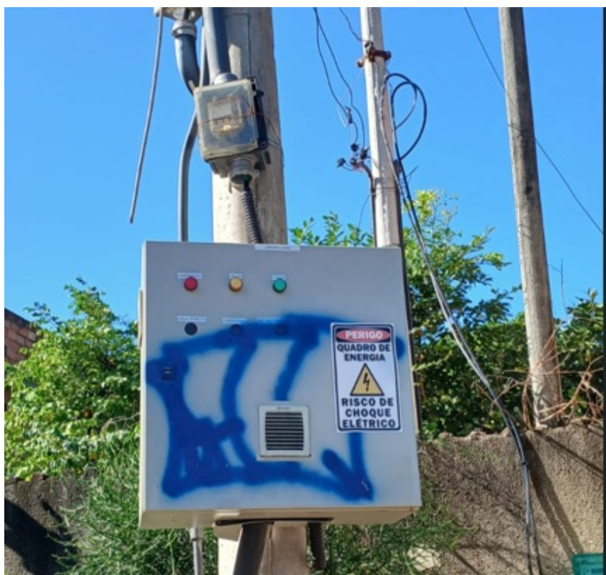
Foto 4 - Pannel de automação com sinalização de risco
