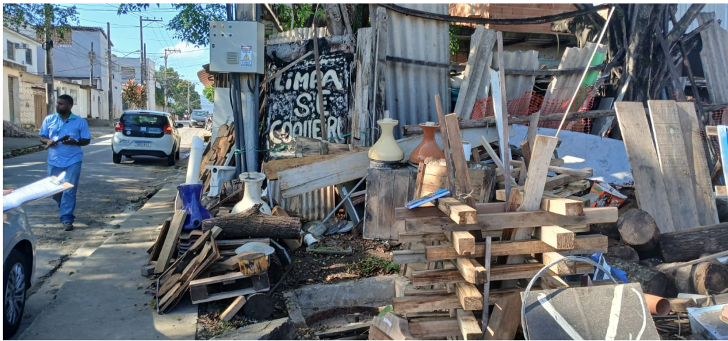
Foto 1 - EEAT da Nega sem identificação e cercada de entulho ao redor.
