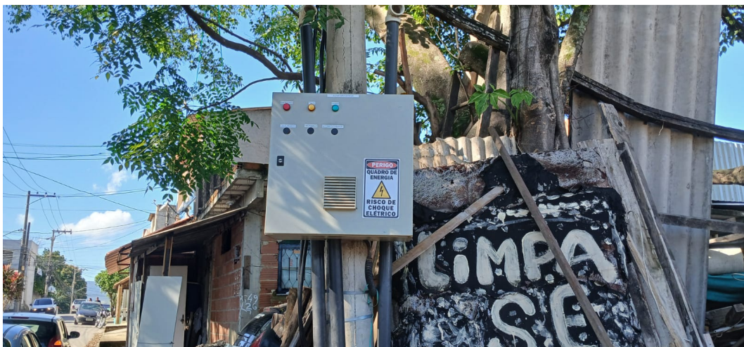
Foto 5 - Pannel de automação com sinalização de risco
