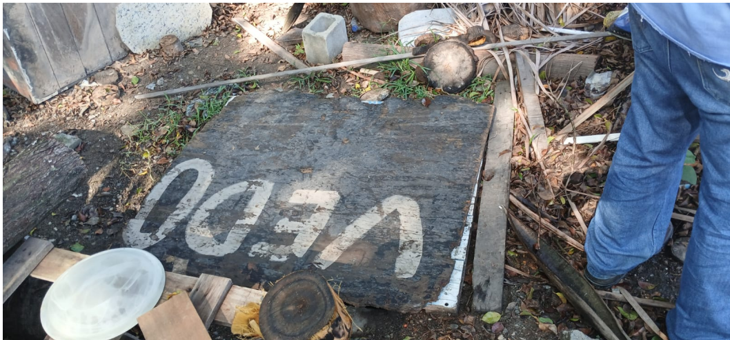
Foto 2 - Tampo improvisado de madeira
