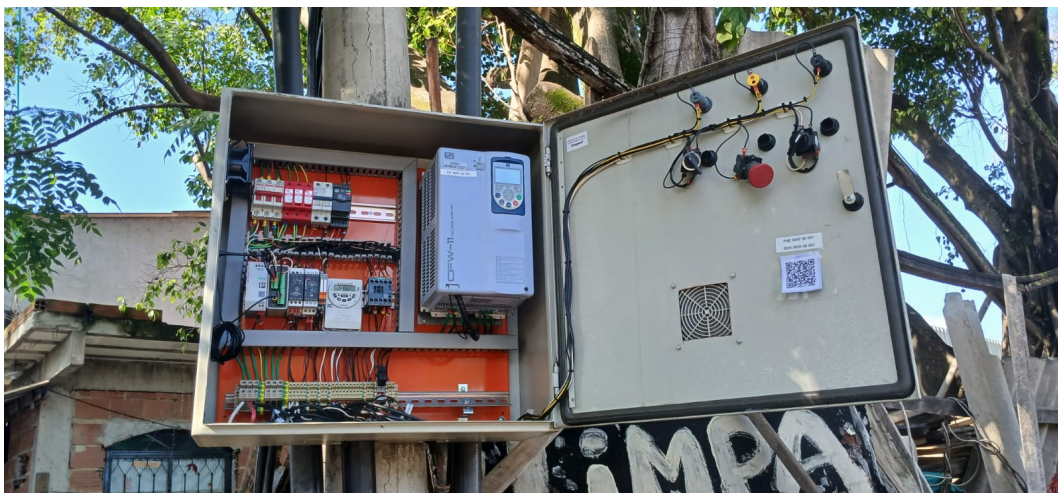
Foto 6 - Interior do pannel de automação com equipamentos bem conservados
