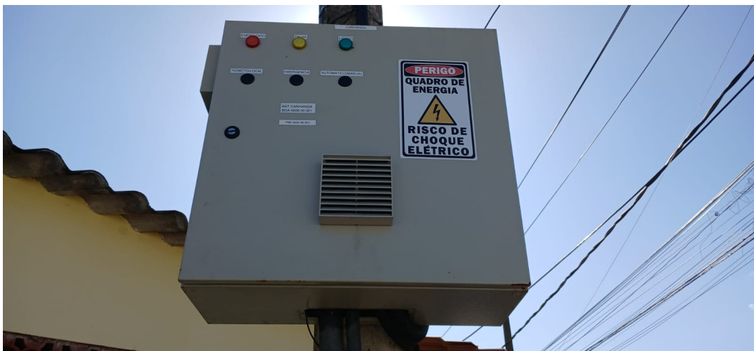
Foto 4 - Pannel de automação com sinalização de risco
