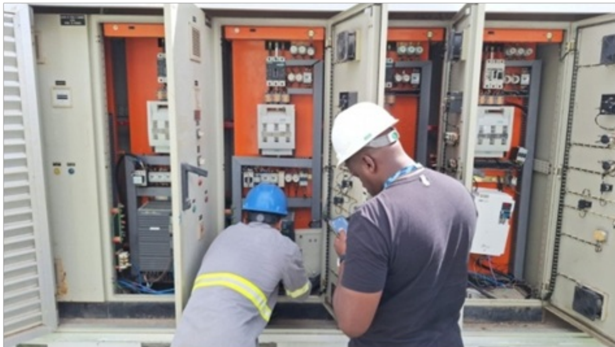
Foto 4 – Quadro de comando das duas EEE's ( do Rio Salgado barrado; e do interceptor/drenagem do logradouro) .
