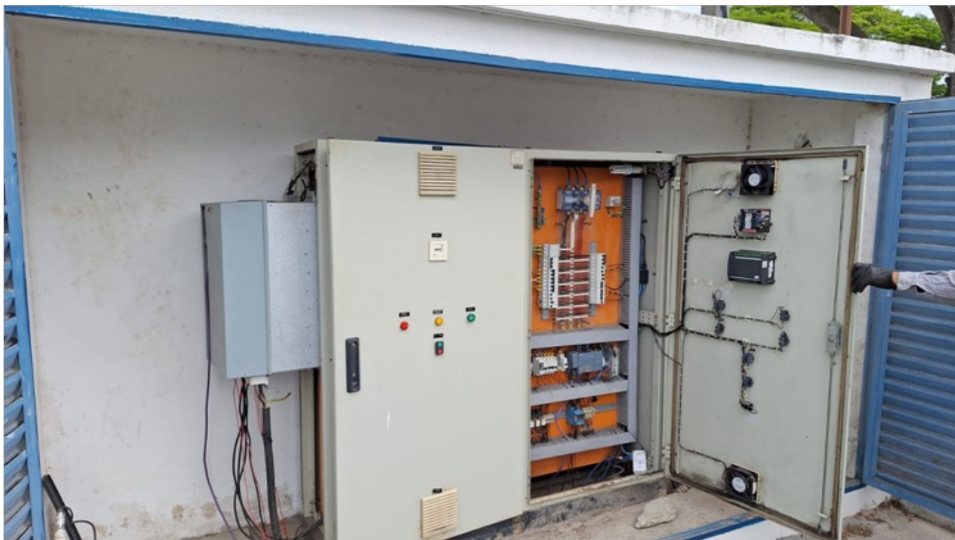
Foto 3– Quadro com inversor/telemetria, e também acionamento manual.
