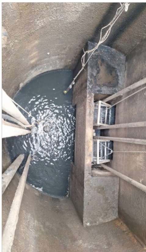
Foto 4 – Poço da EEE com gradeamento para limpeza .
