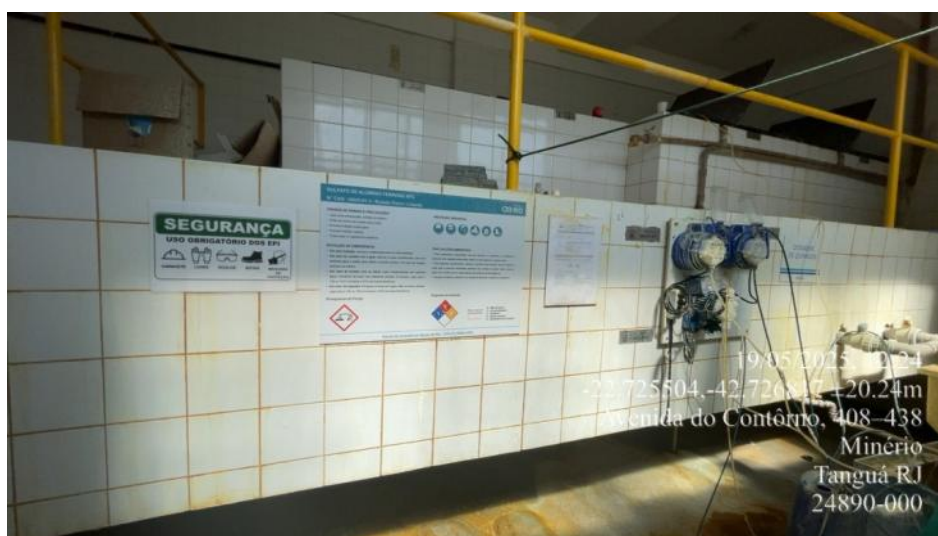
Foto 14 – Casa de química com bombas de dosagem de químicos
