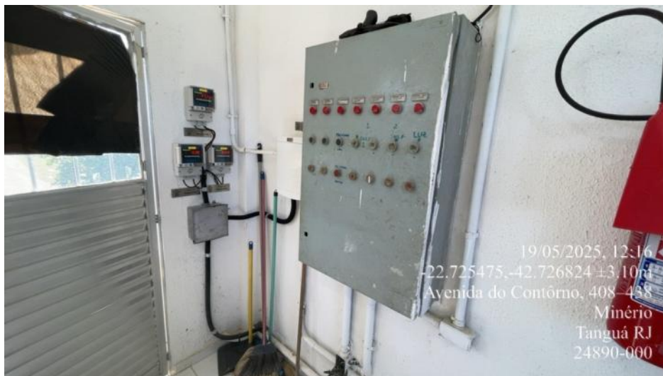
Foto 27 – Macromedidores e painel de comando da ETA
