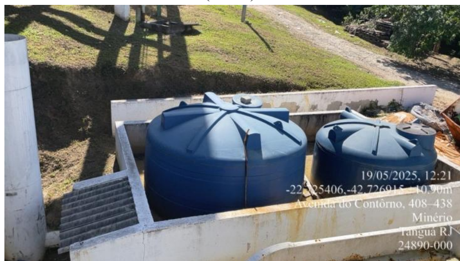
Foto 15 – Tanques de armazenamento de sulfato de alumínio sem identificação
