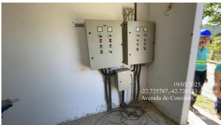
Foto 26 – Painelelétrico sem sinalização de segurança da EEAT 2
