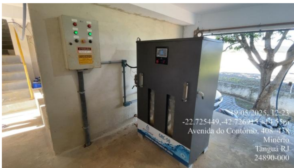
Foto 17 – Pannel de comando de aplicação de produtos químicos
