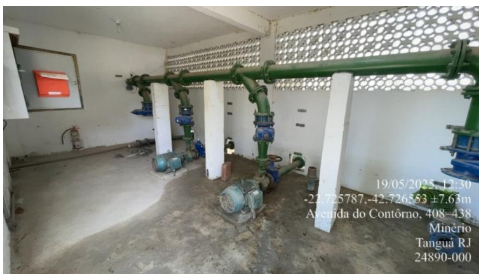
Foto 25 – Vista interna da EEAT 2
