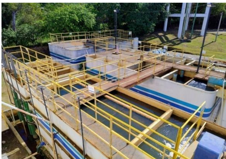
Foto 6 – Vista geral dos módulos de tratamento
