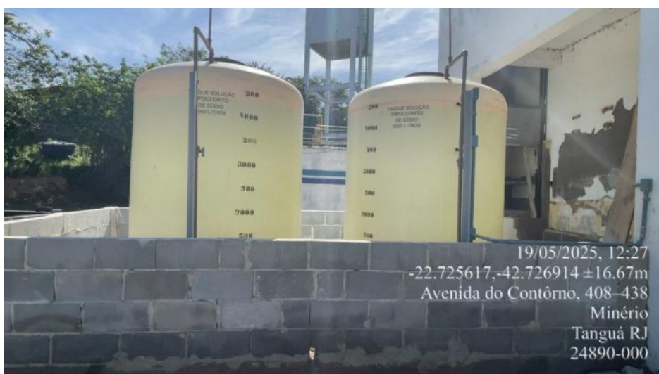
Foto 18 – Tanques de armazenamento de hipoclorito
