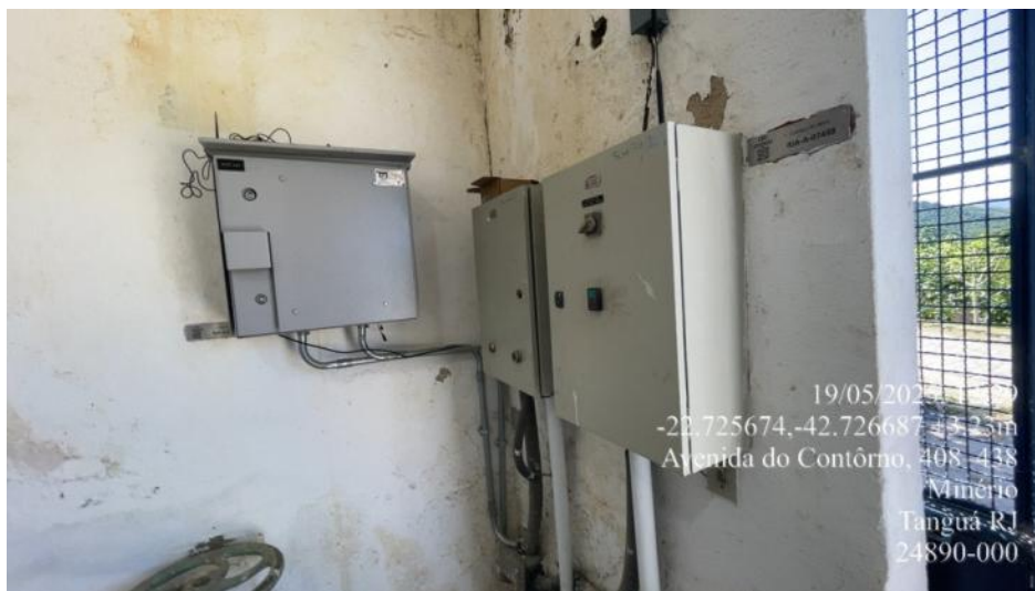
Foto 23 – Cabine elétrica da EEAT 1 sem sinalizações de segurança
