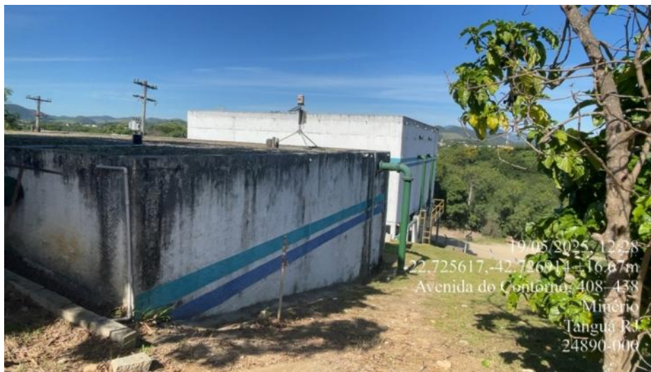
Foto 19 - Reservatórios de 500 e 1000m³
