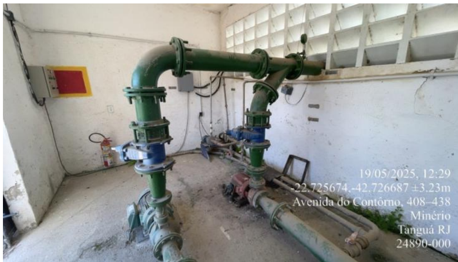
Foto 22 – Vista interna da EEAT 1
