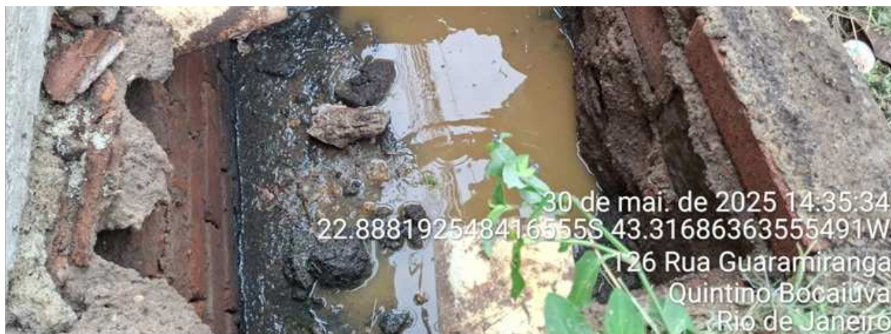
Foto 13 – Caixa de esgoto fora do padrão localizado na Rua Guaramiranga
