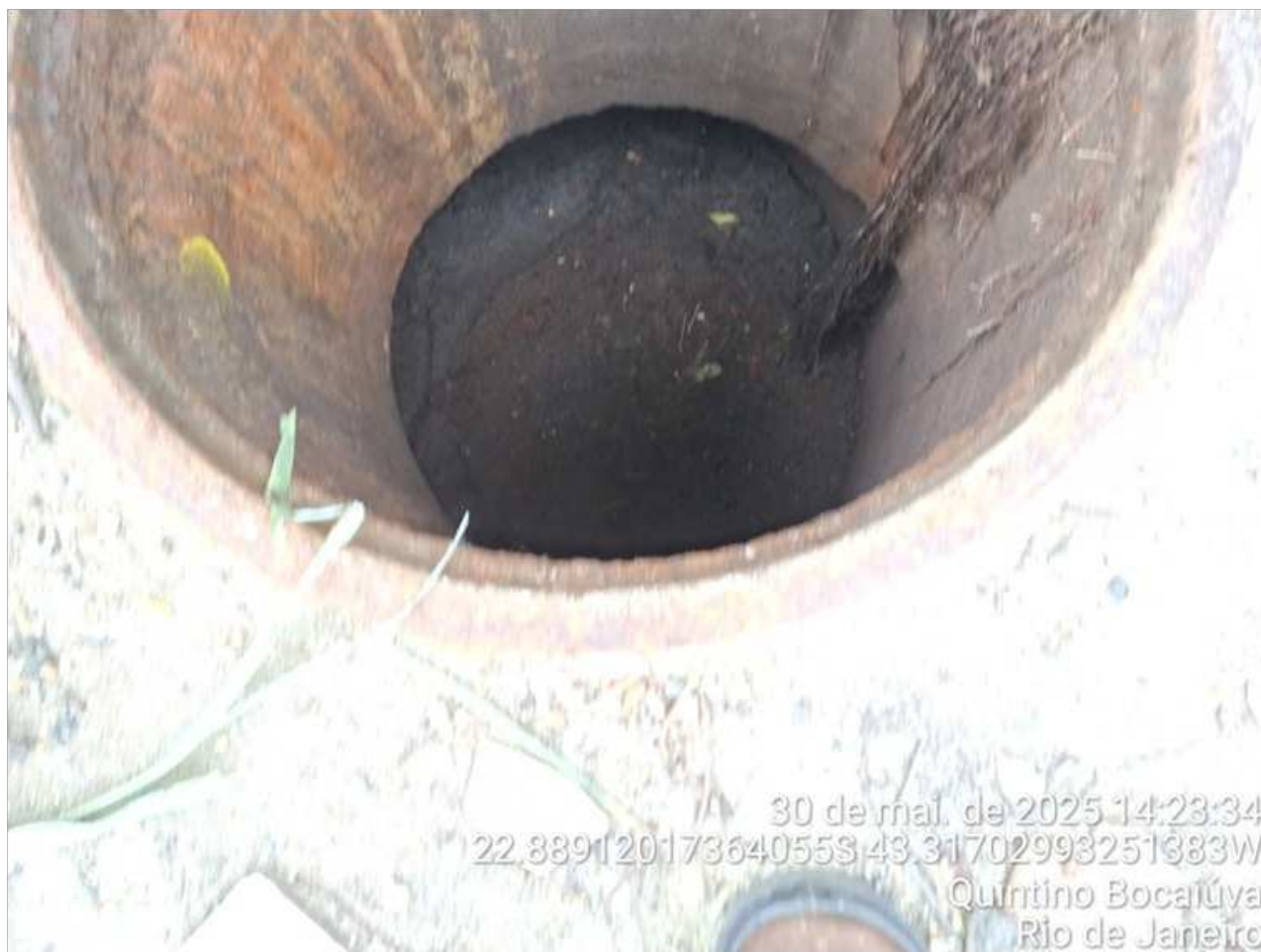
Foto 5 – PV de águas pluviais assoreado
