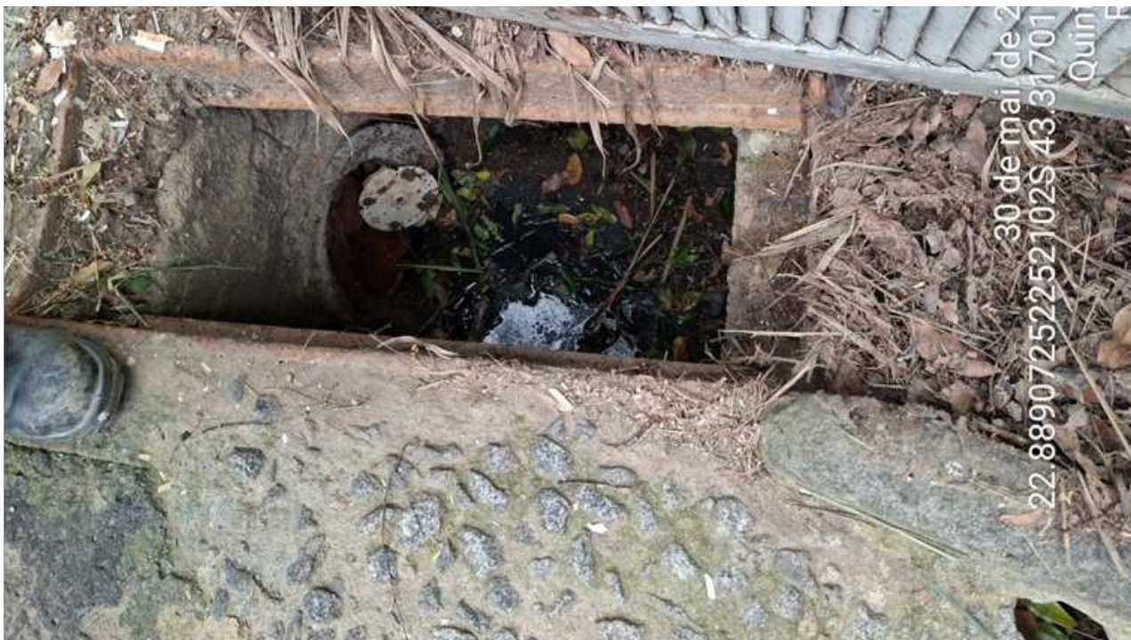
Foto 6 – Caixa de passagem água pluvial
