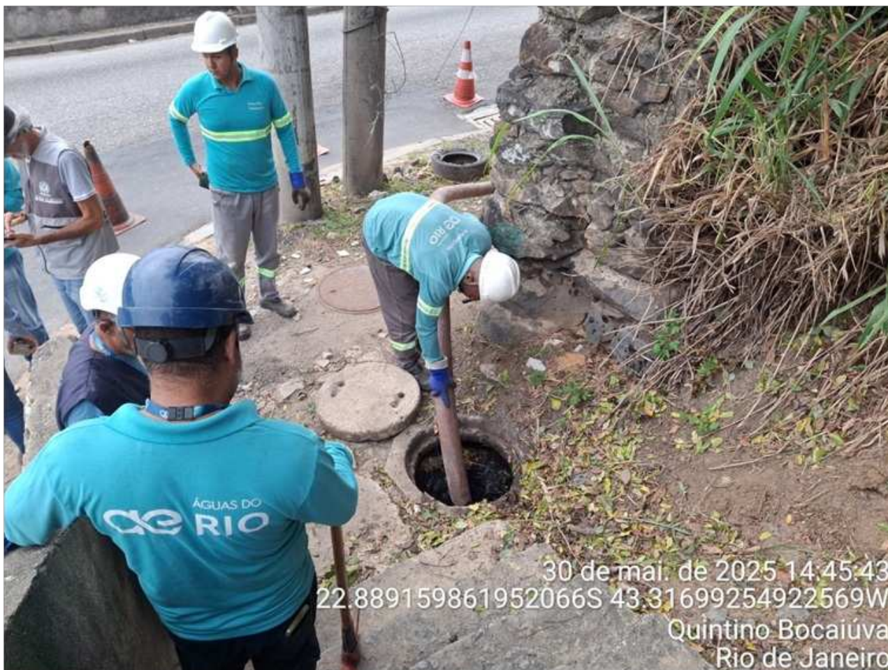
Foto 10 – Limpeza pela concessionária do PV de água pluvial que recebe contribuição de esgoto
