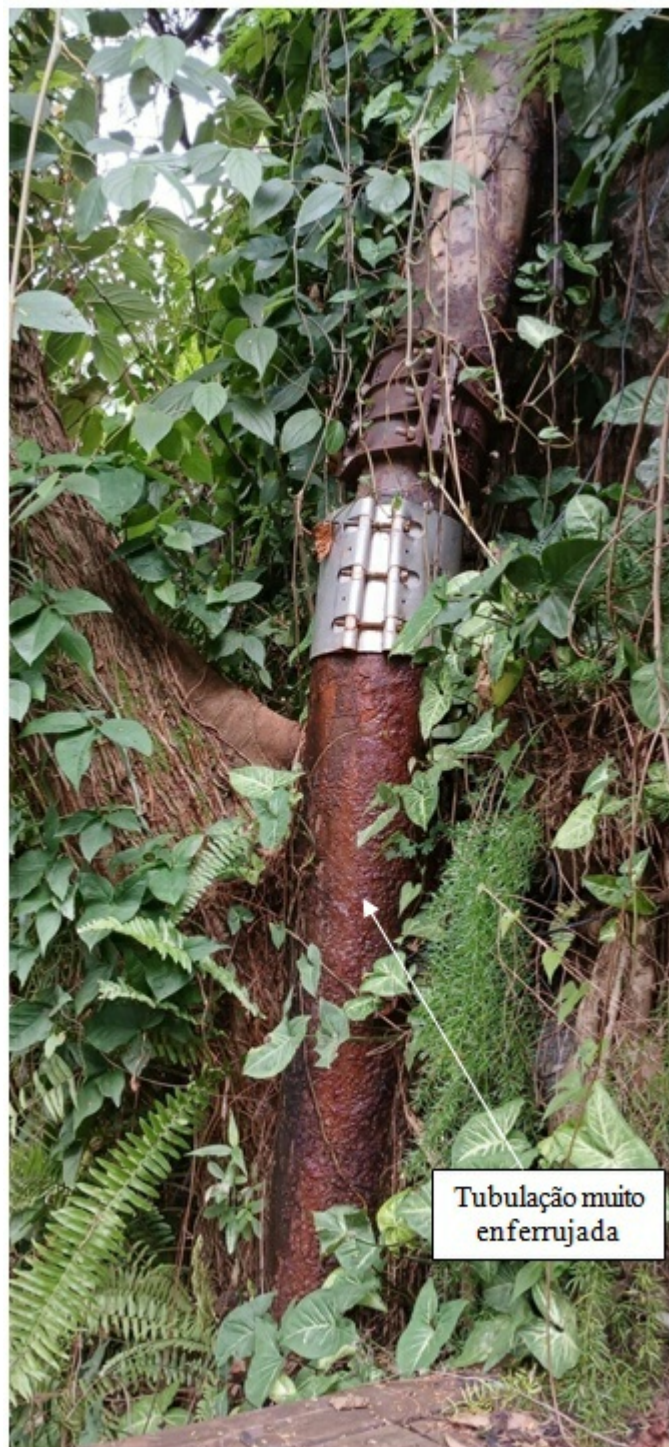
Foto 3 – Tubulação de recalque
