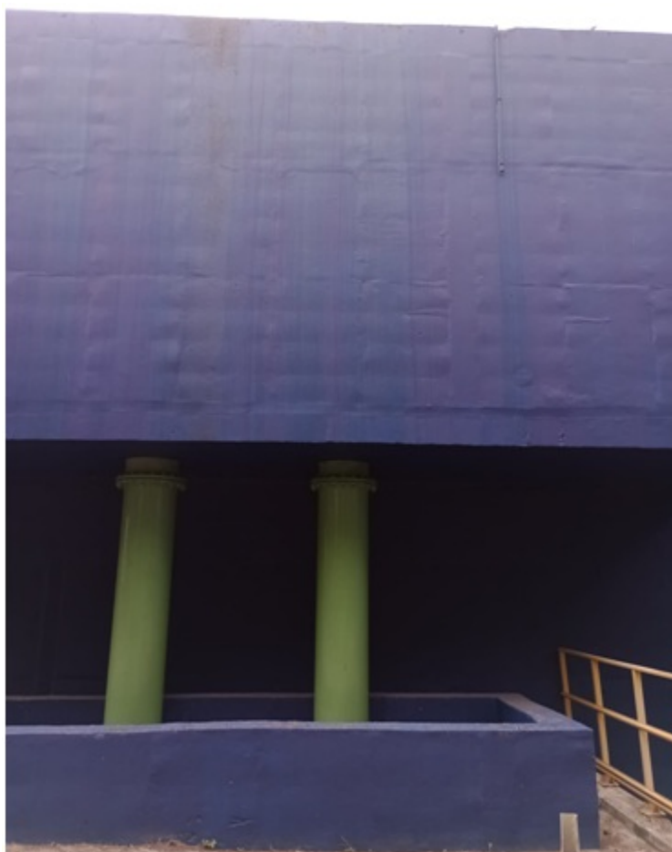
Foto 21 – Tubulações extravasoras da 2ª célula
