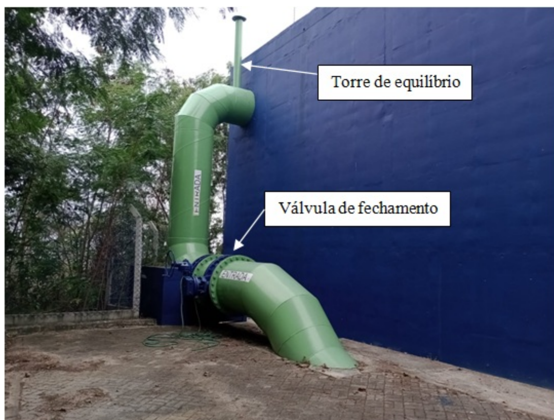
Foto 16 – Tubulação de entrada da 2ª célula
