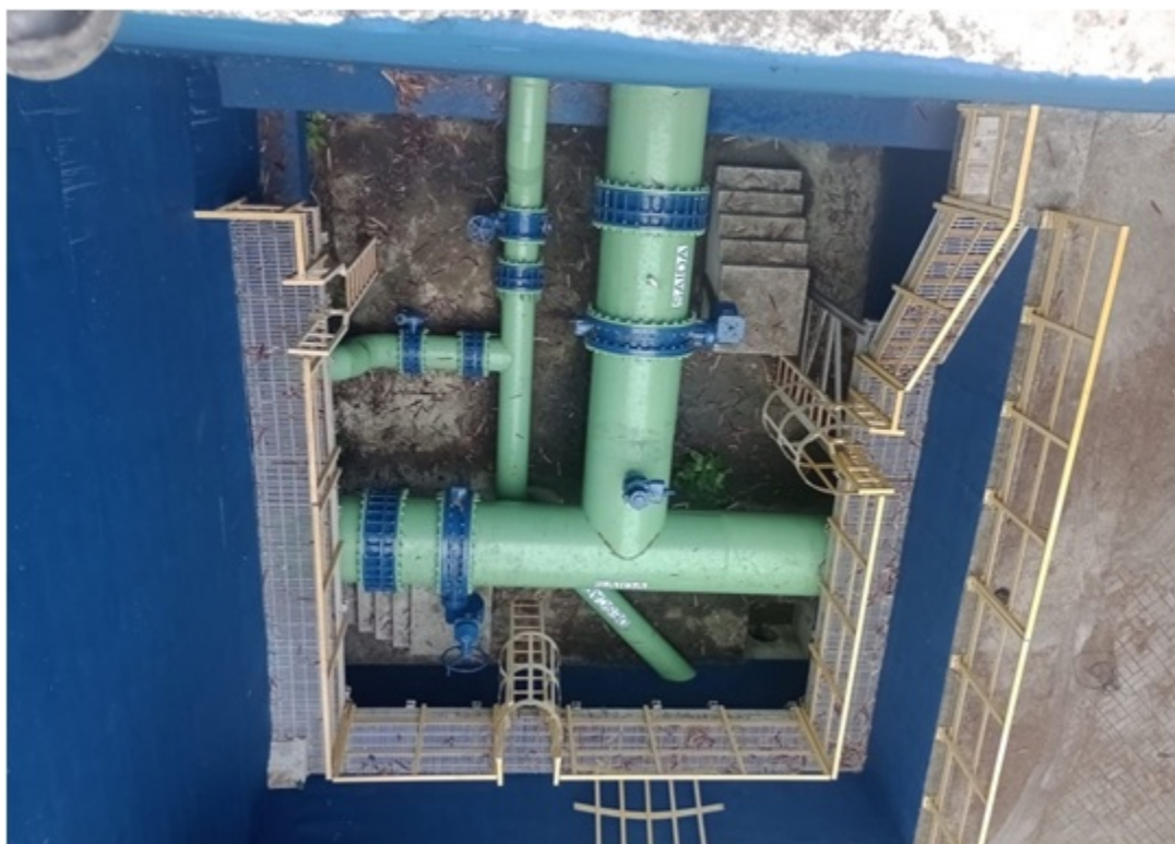
Foto 17 – Tubulações de distribuição (saída) e limpeza (descarga)
