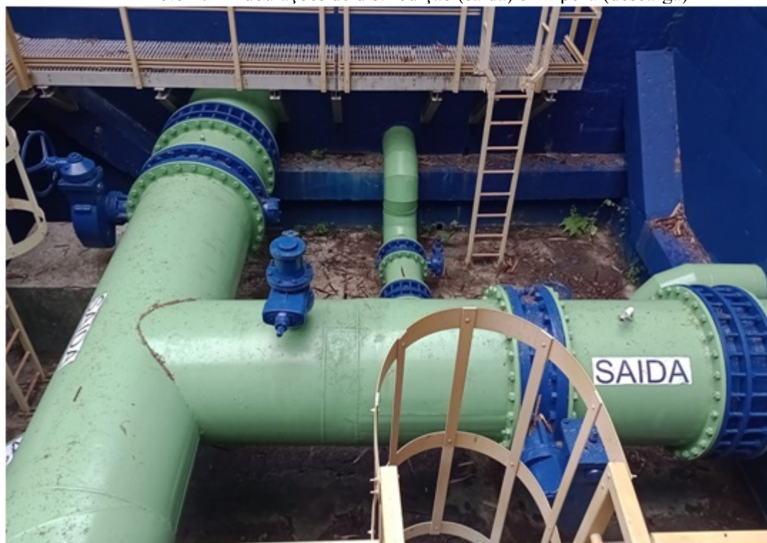
Foto 18 – Tubulações de distribuição (saída) e limpeza (descarga)
