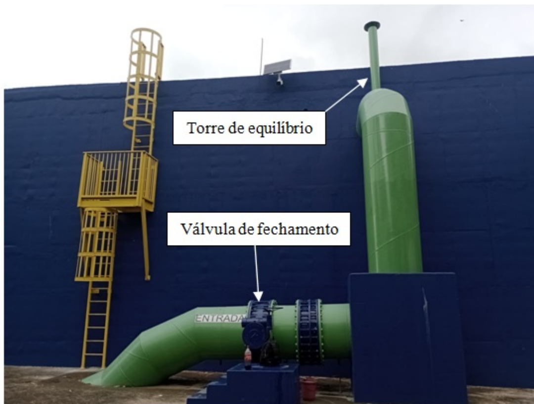
Foto 15 – Tubulação de entrada da 1ª célula
