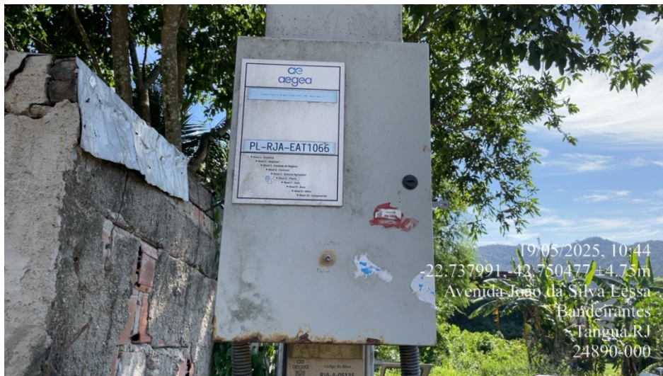
Foto 2 – Cabine elétrica com placa de identificação
