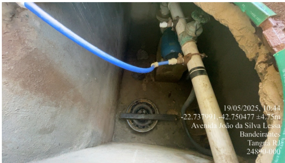
Foto 3 – Vista interna do poço da bomba
