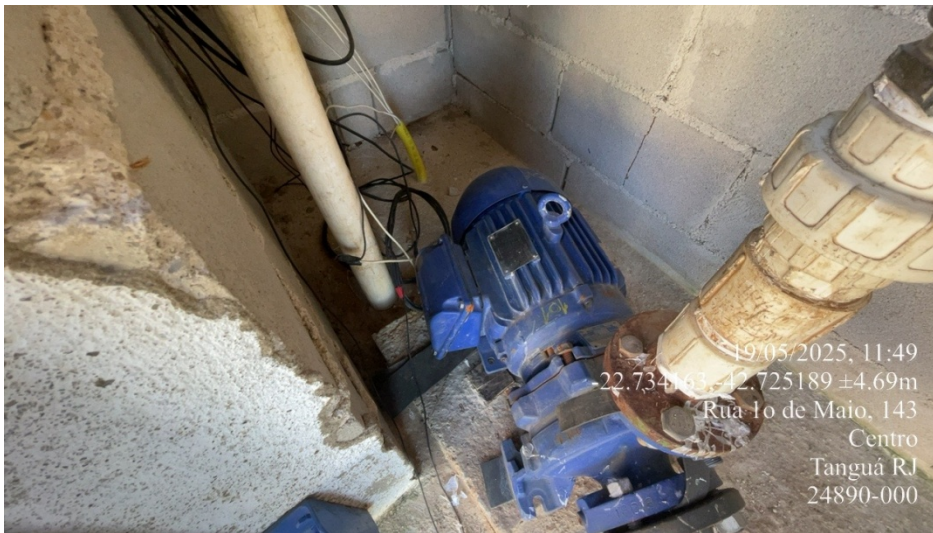
Foto 3 – Vista interna da clausura da bomba
