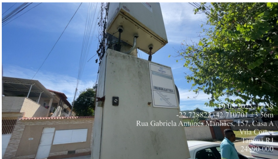
Foto 4 – Cabine de energia com placa de identificação
