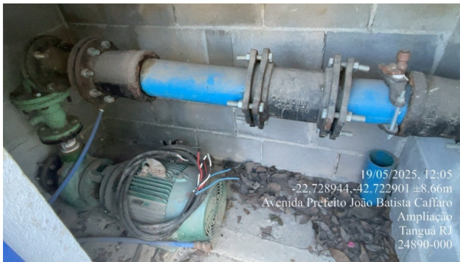
Foto 3 – Vista interna da EEAT com bomba desativada
