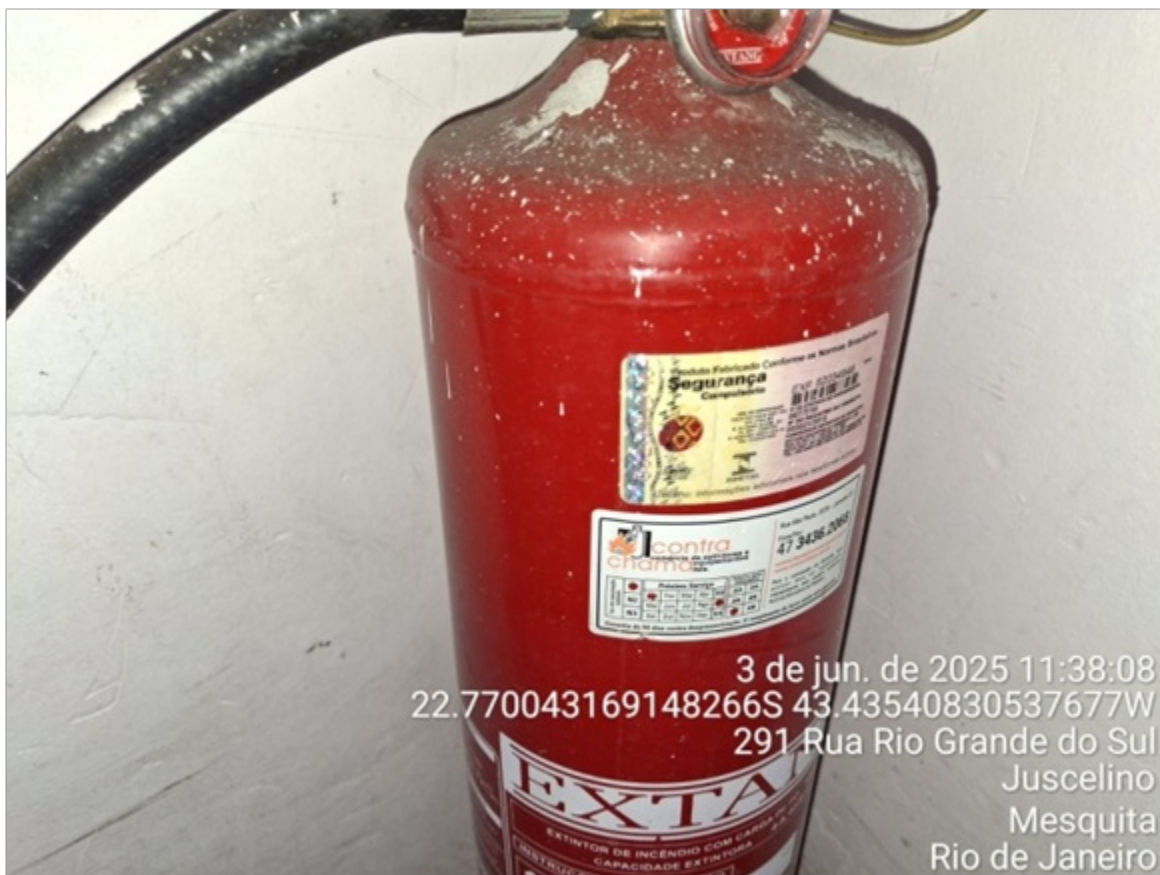
Foto 17 – Um dos extintores vencidos
