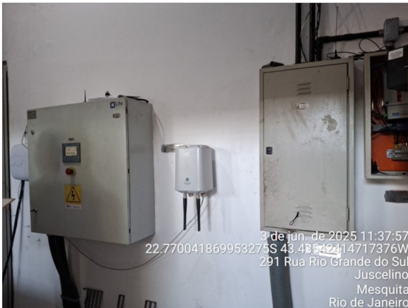
Foto 7 – Painéis de operação
