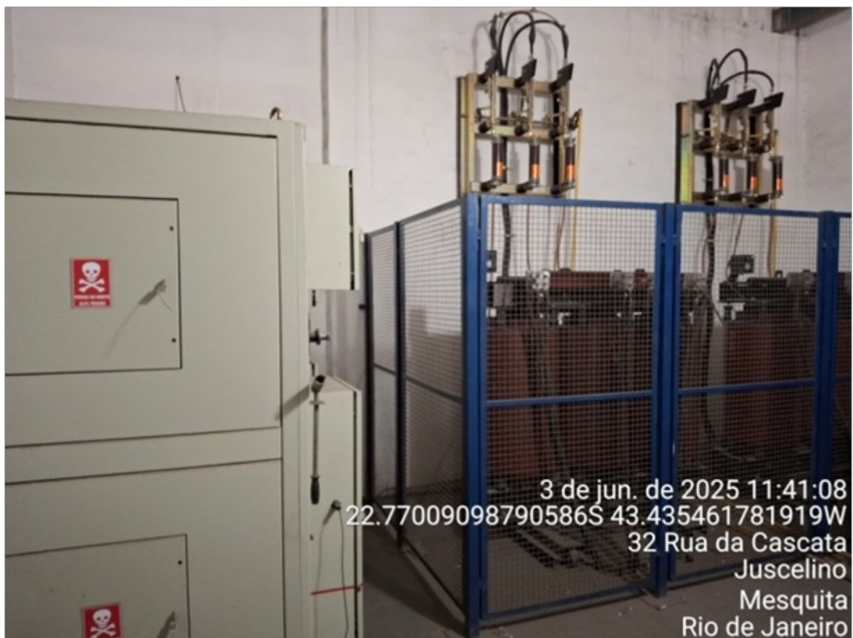
Foto 12 – Subestação de energia
