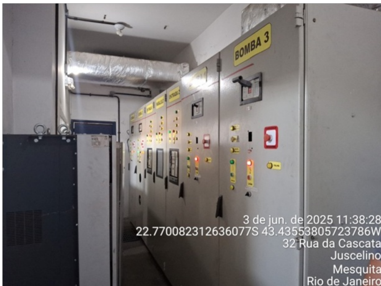
Foto 8 – Painéis de operação das bombas
