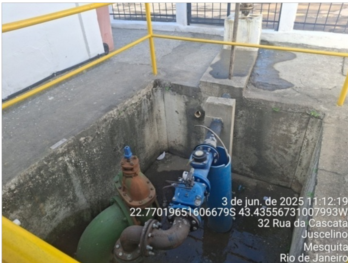
Foto 15 – Barrilete da tomada caminhão pipa
