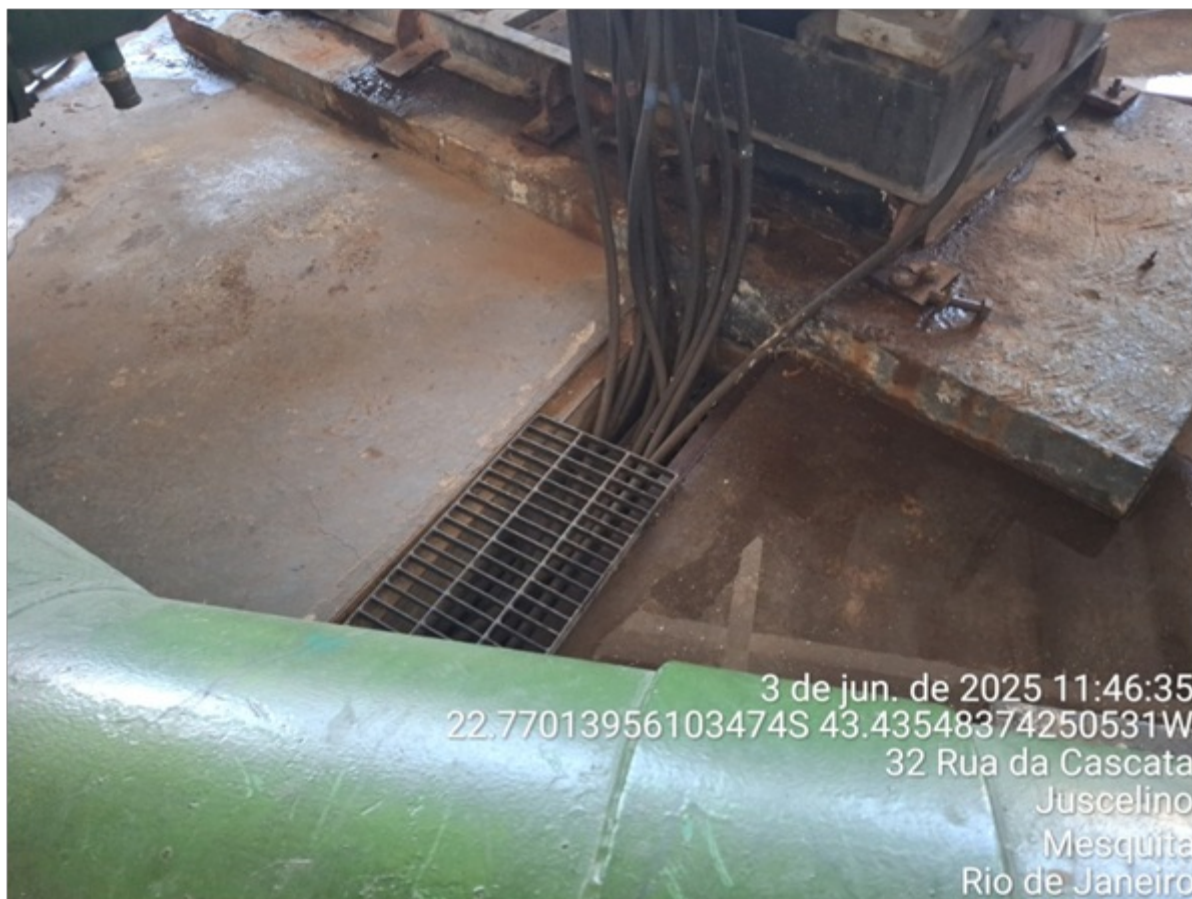
Foto 10 – Fiação da canaleta ao conjunto motobomba
