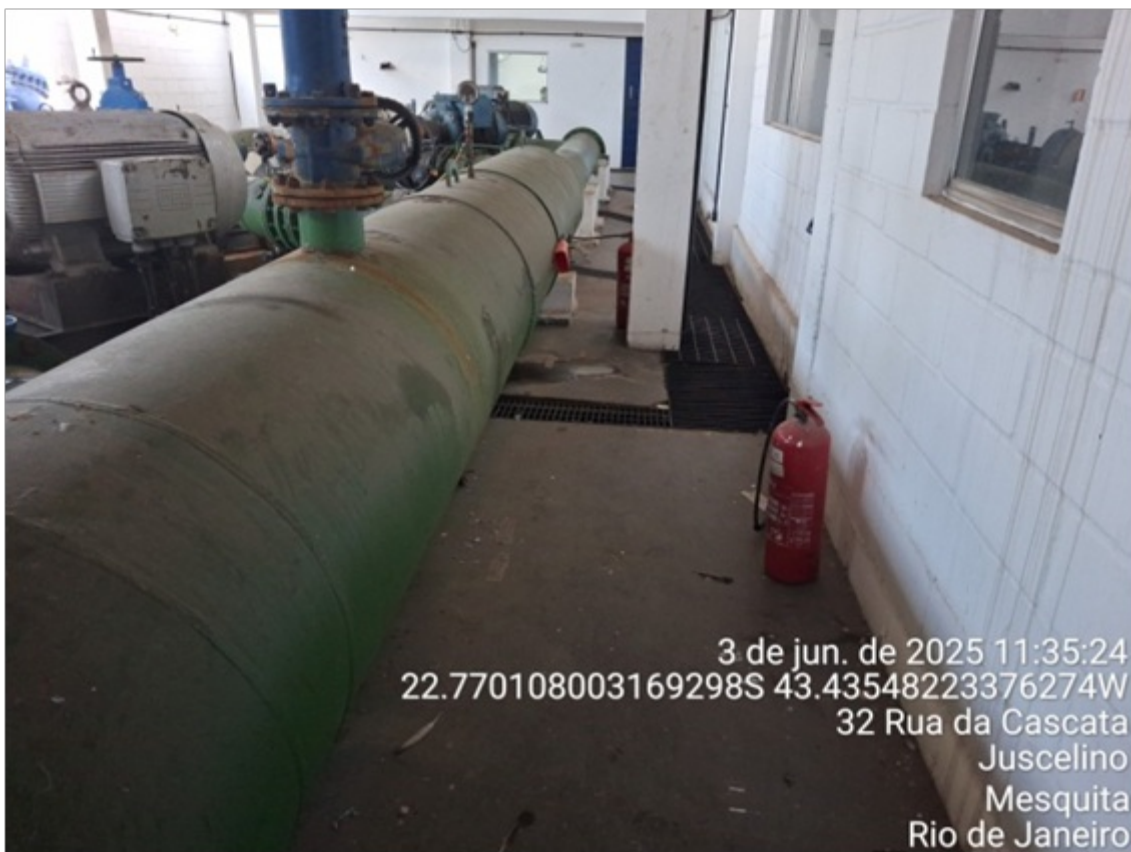
Foto 16 – Extintores no chão
