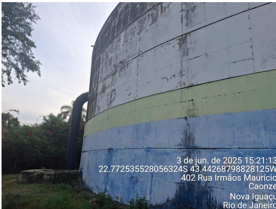
Foto 1: Reservatório JK II, com sinais de infiltração e pintura defasada.
