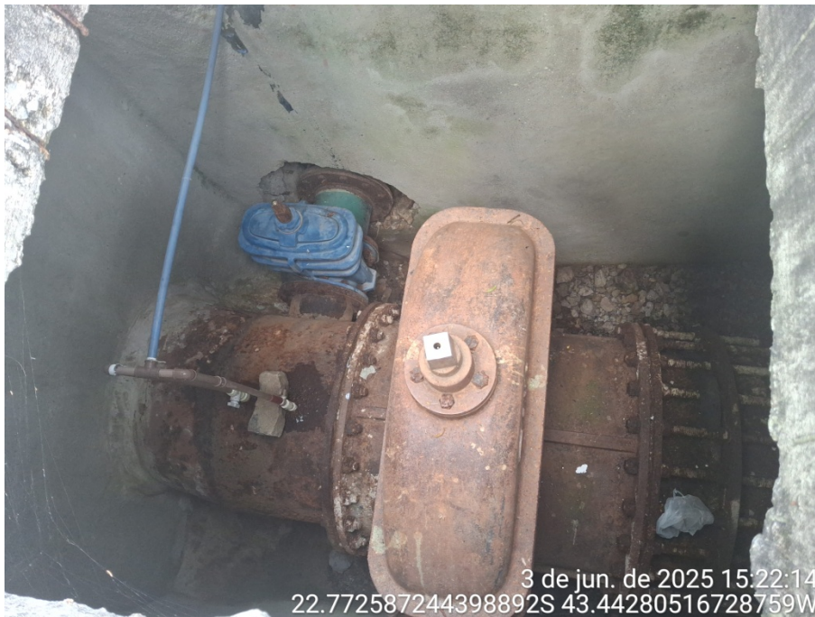
Foto 2: Acesso ao registro e tubulação vandalizado. Acúmulo de lixo e alto grau de oxidação da estrutura.
