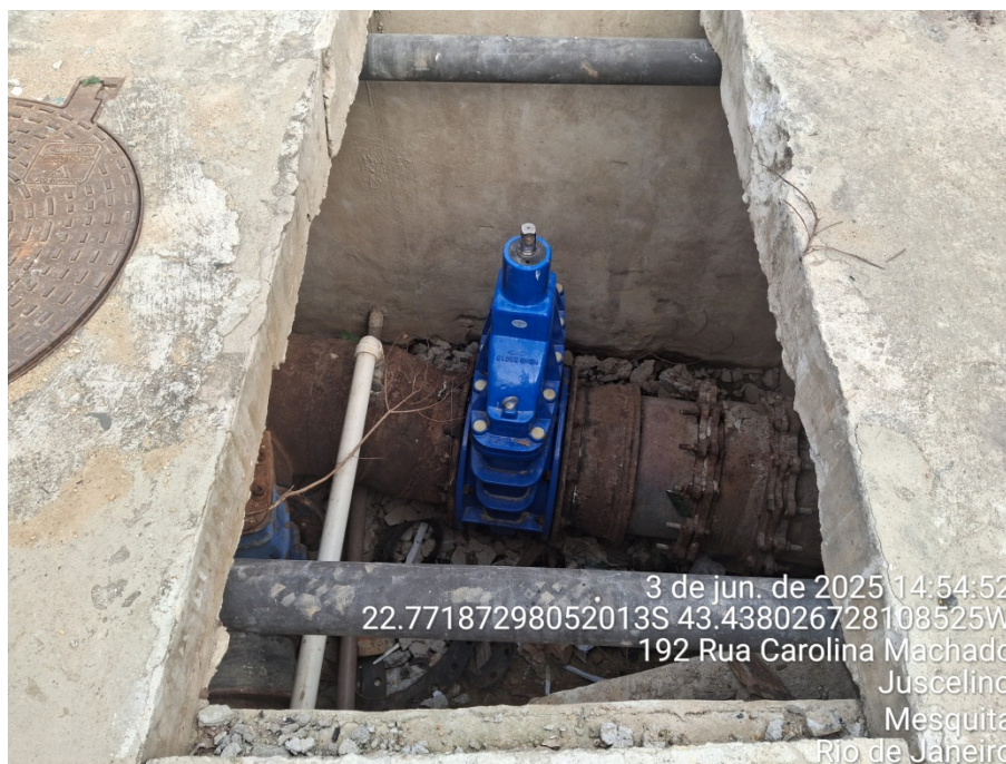
Foto 5: Tubulação de distribuição com tampa vandalizada. Registro em boas condições.
