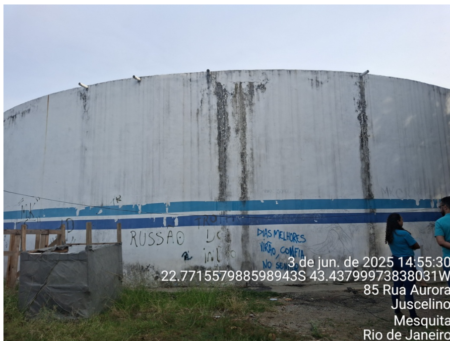
Foto 1: Reservatório JK 1, com sinais de vandalismo e invasão.
