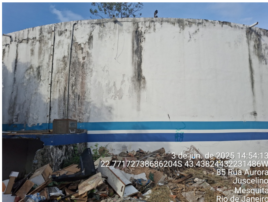
Foto 2: Sinais de Infiltração, deterioração e entulhos no perímetro.
