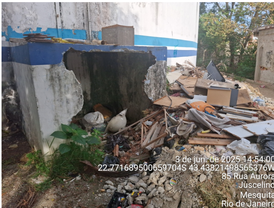
Foto 3: Entulhos e lixo.
