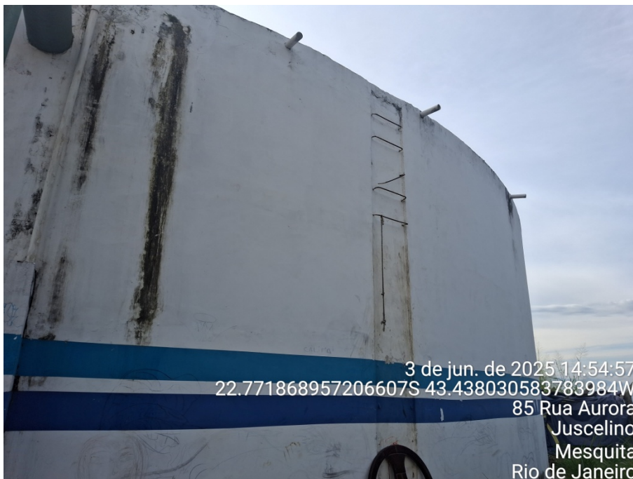
Foto 4: Escada de acesso vandalizada, impossibilitando verificação da parte superior.
