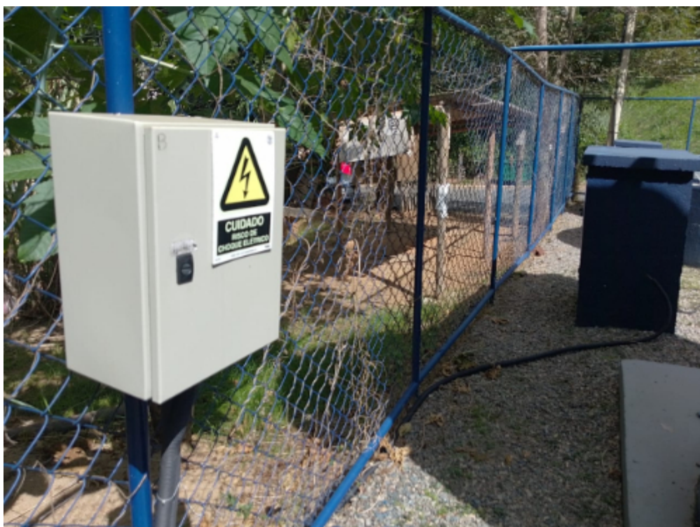
Figura 3. Cercamento da unidade e identificação de risco de choque elétrico no quadro de comando.
