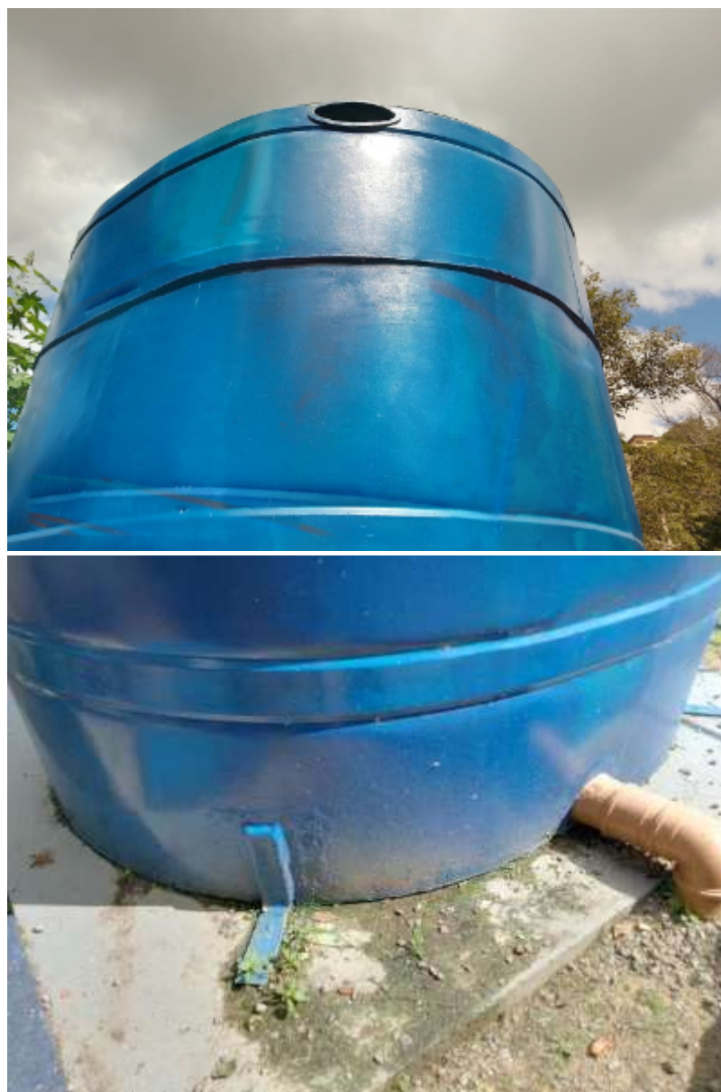
Figura 4. Filtro biológico percolador da ETE Alto do Recanto.
