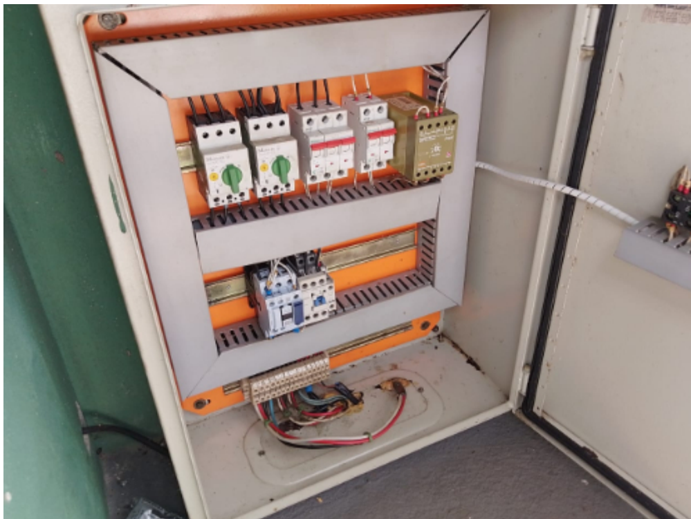
Figura 5. Quadro de comando da ETE
