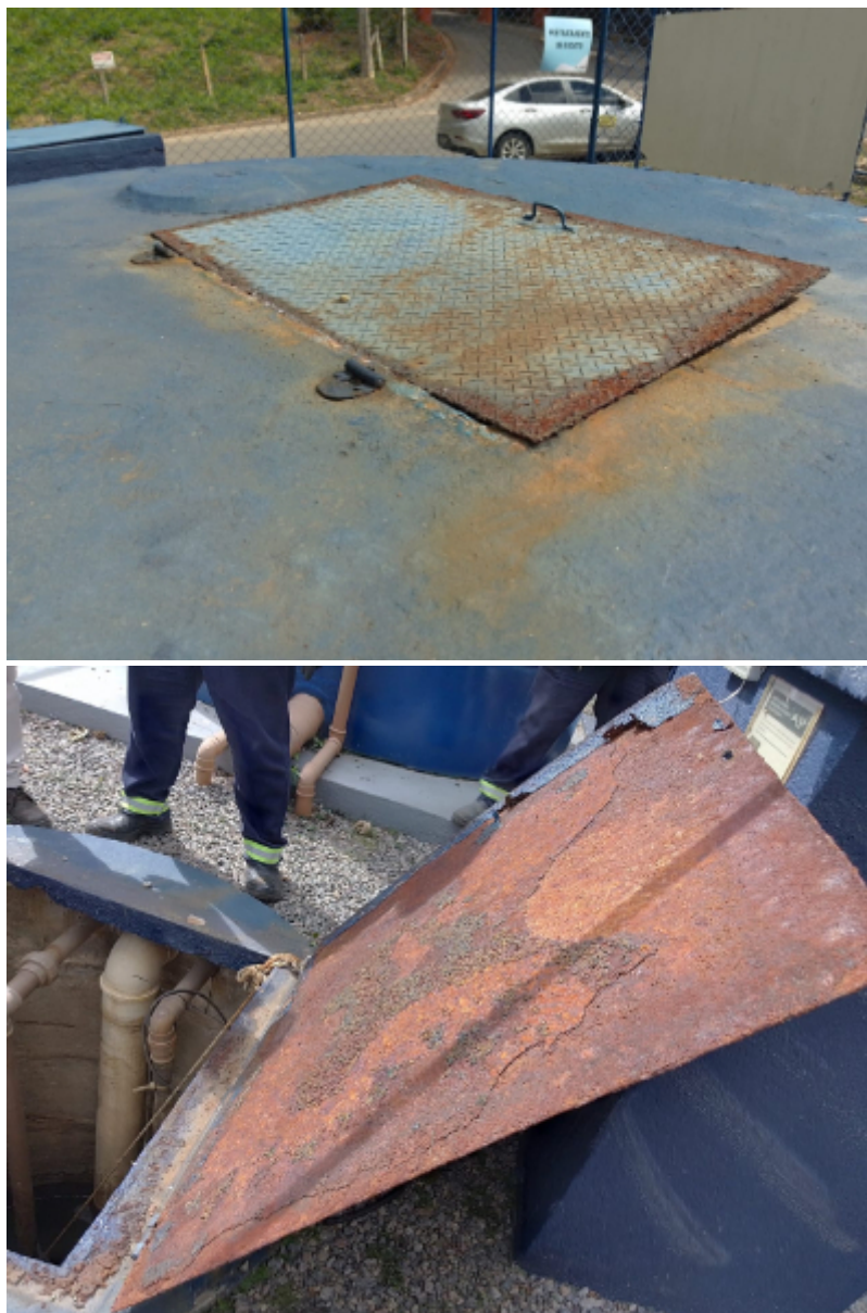
Figura 8. Tampões de fechamento oxidados.
