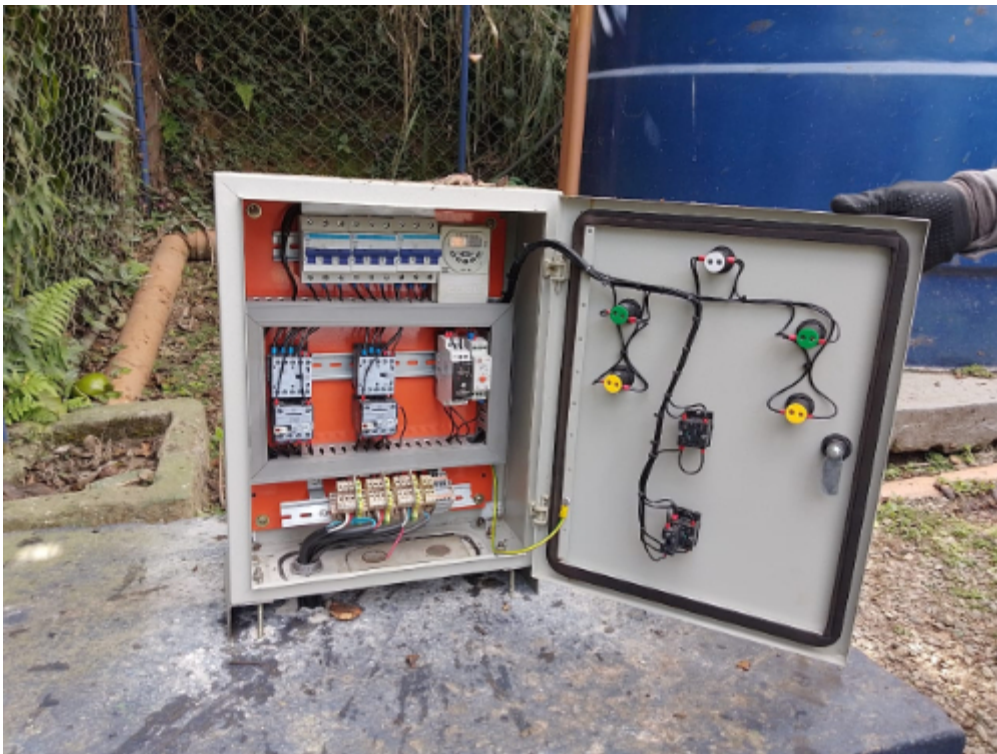
Figura 7. Quadro de comando da ETE.
