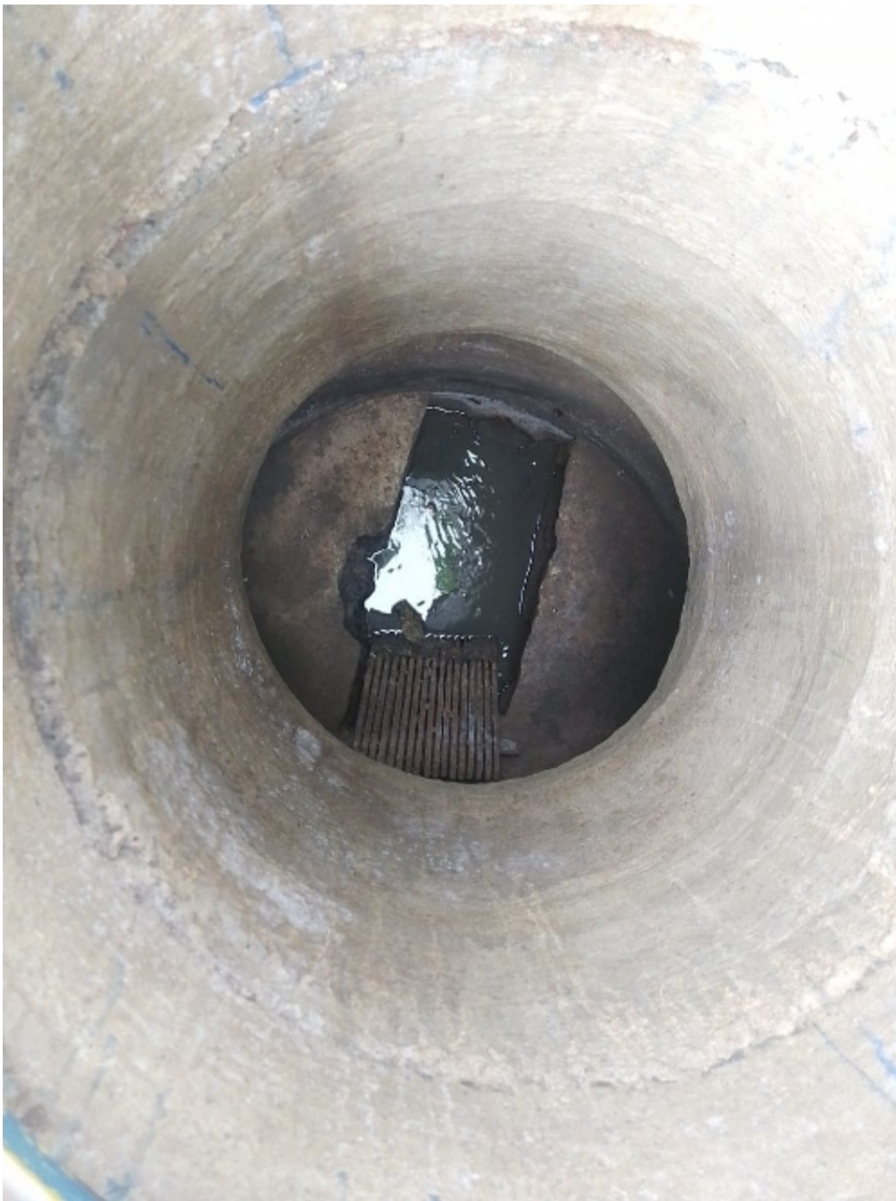
Figura 3. Gradeamento de entrada da ETE.
