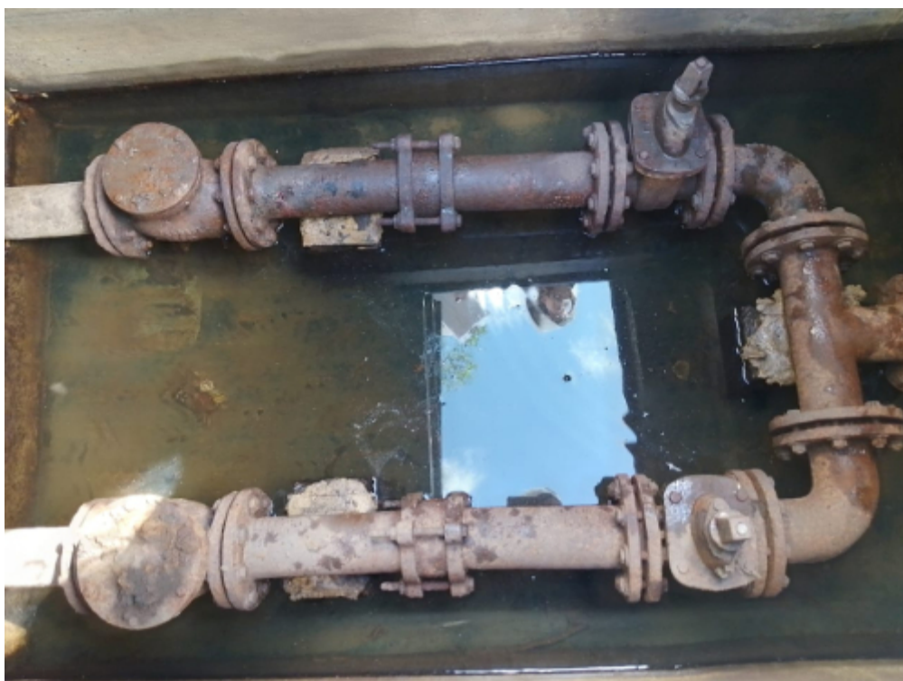
Figura 3. Caixa de válvulas da EEEB contendo válvulas de retenção e fechamento.
