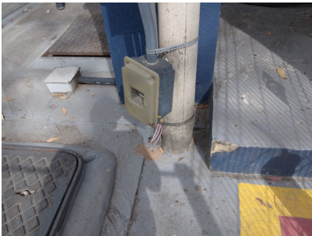
Figura 9. Fiação exposta sem eletroduto.
