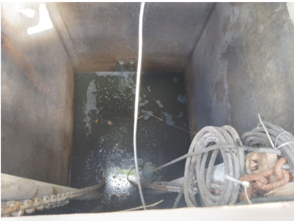
Figura 6. Poço de sucção com sensor de nível e corrente de içamento.
