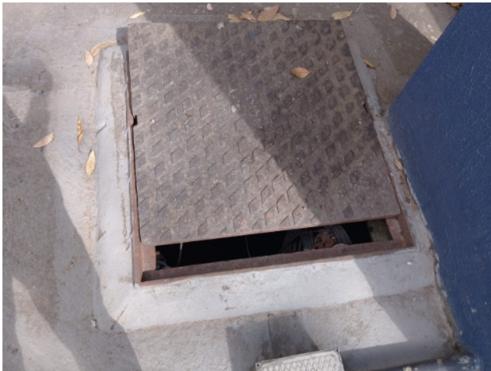
Figura 8. Tampa entreaberta com risco potencial.
