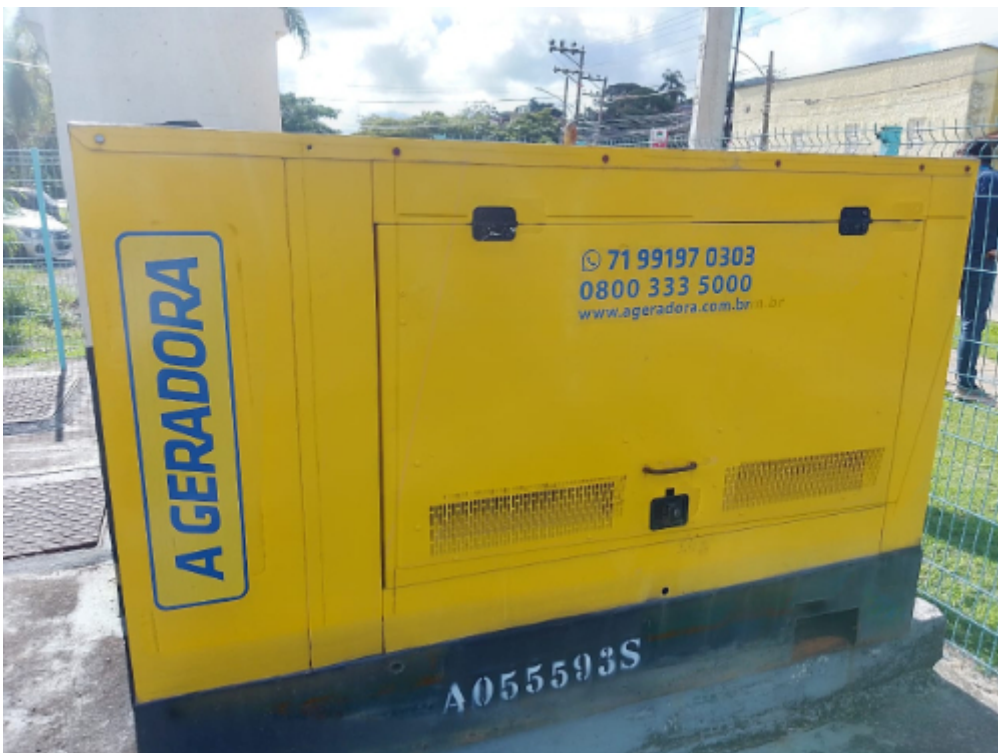
Figura 2. Unidade geradora de energia disponível na EEEB 1A.
