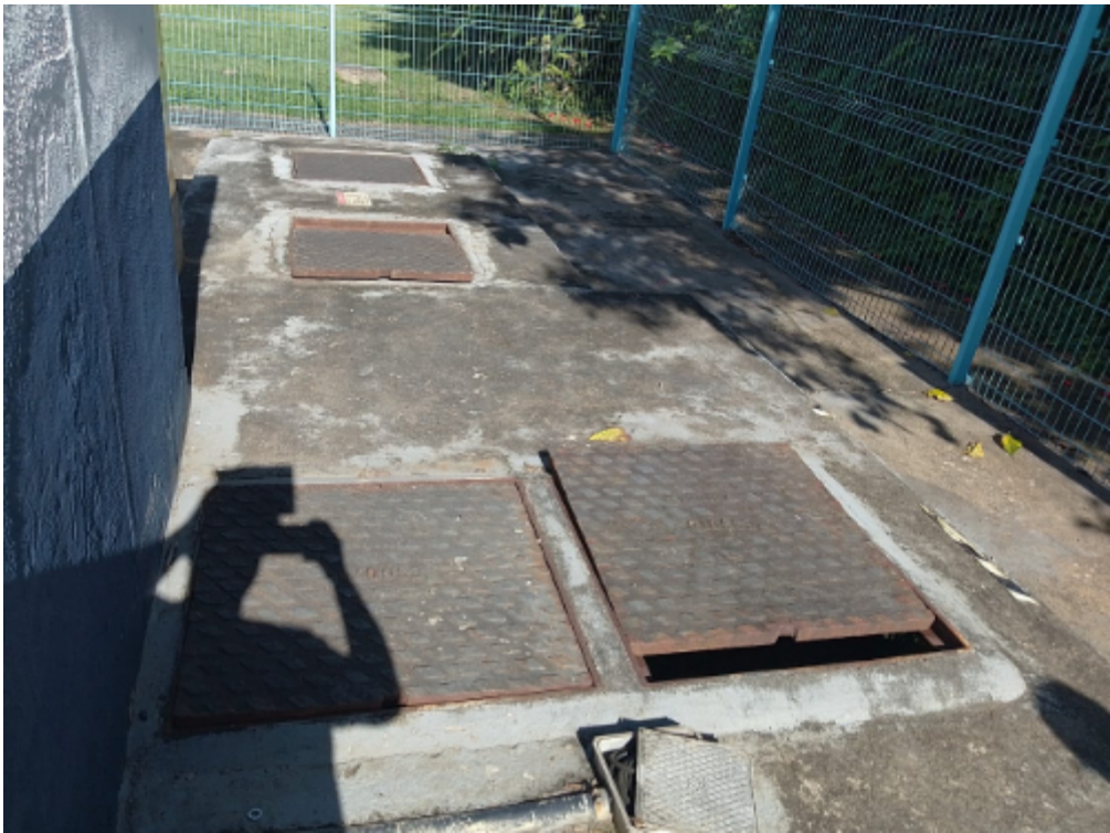
Figura 9. Tampa entreaberta com risco potencial.
