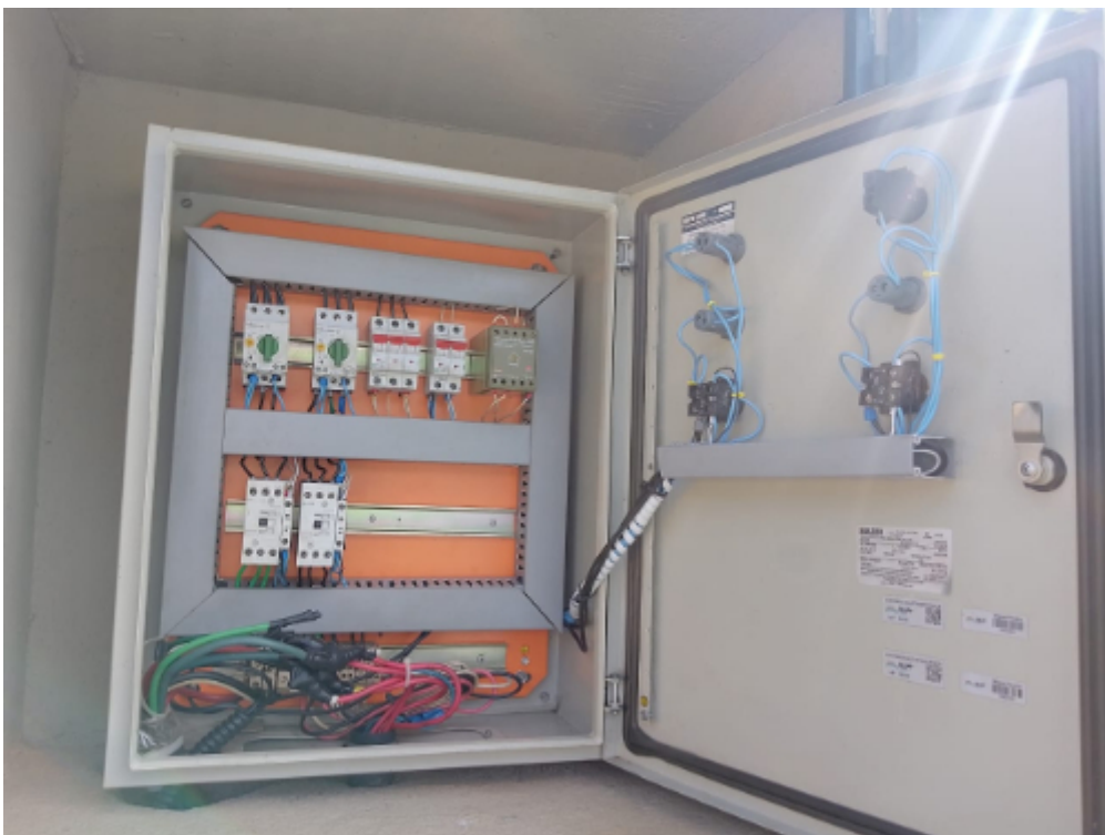
Figura 8. Quadro de comando da EEEB.
