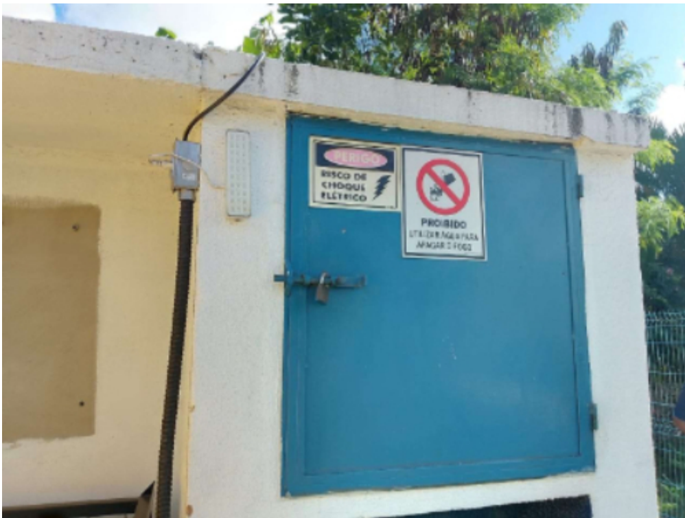
Figura 5. Sinalização de risco de choque elétrico
