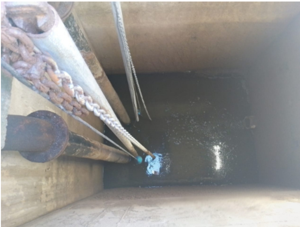
Figura 7. Poço de sucção com sensor de nível e corrente de içamento.
