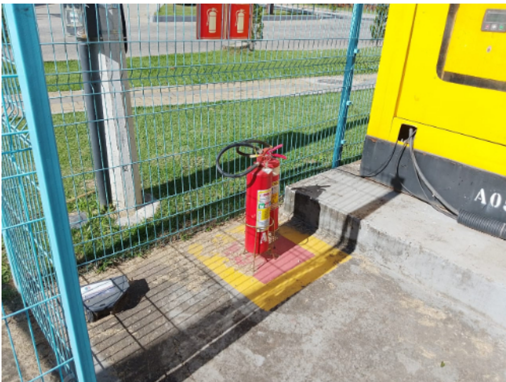
Figura 4. Extintor disponíveis na EEEB.
