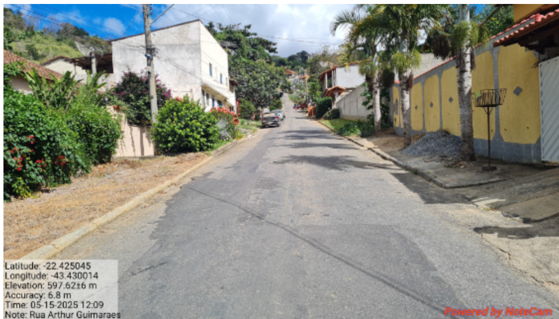
Figura 8. Foto da fiscalização na Rua Arthur Guimarães sem a presença de Poços de Visita (PVs).
