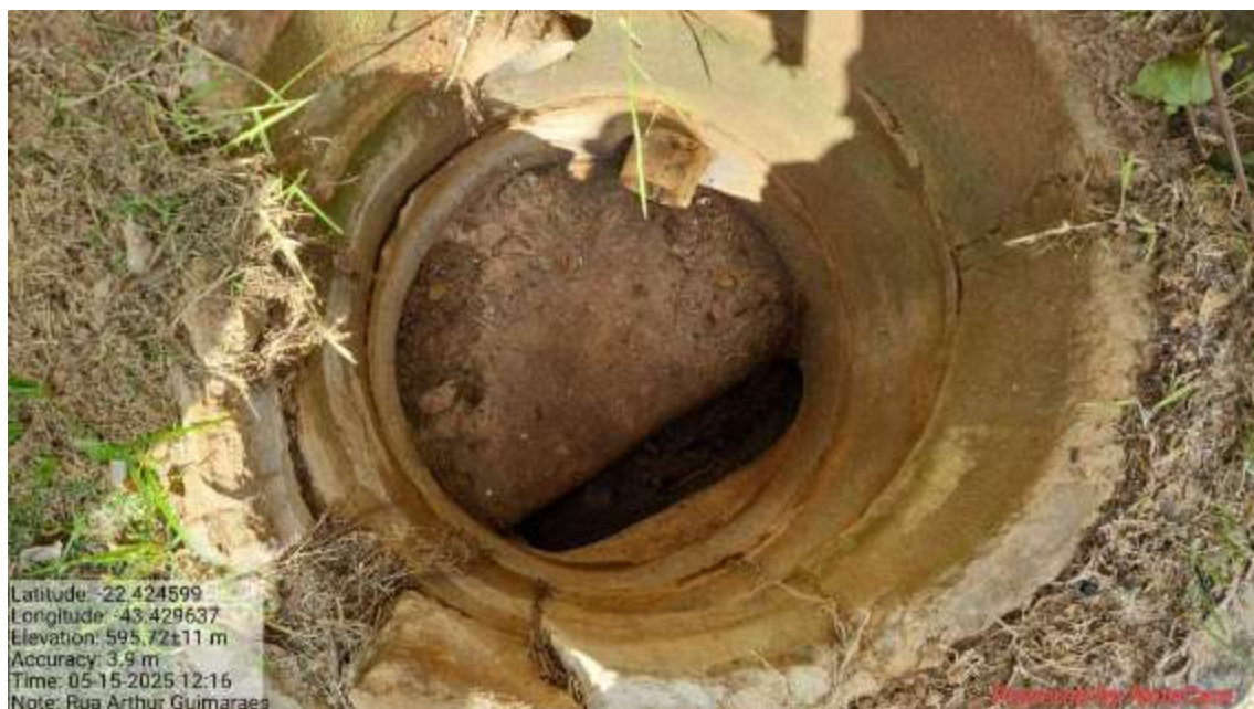
Figura 9. Foto de possível ligação de esgoto na Rua Arthur Guimarães.
