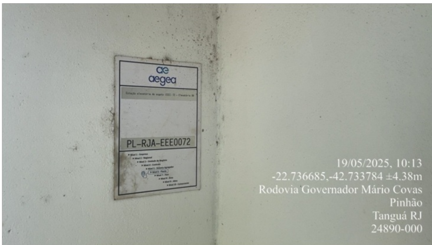
Foto 4 – Placa de identificação da elevatória.
