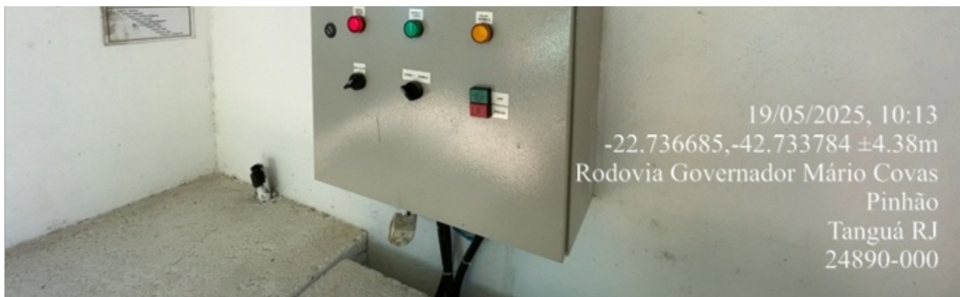
Foto 5 – PAINEL DE CONTROLE
