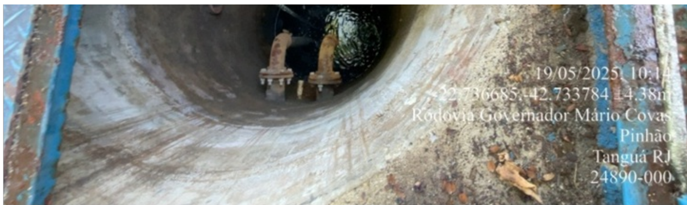
Foto 7 – Poço da motobomba submersível de recalque.
