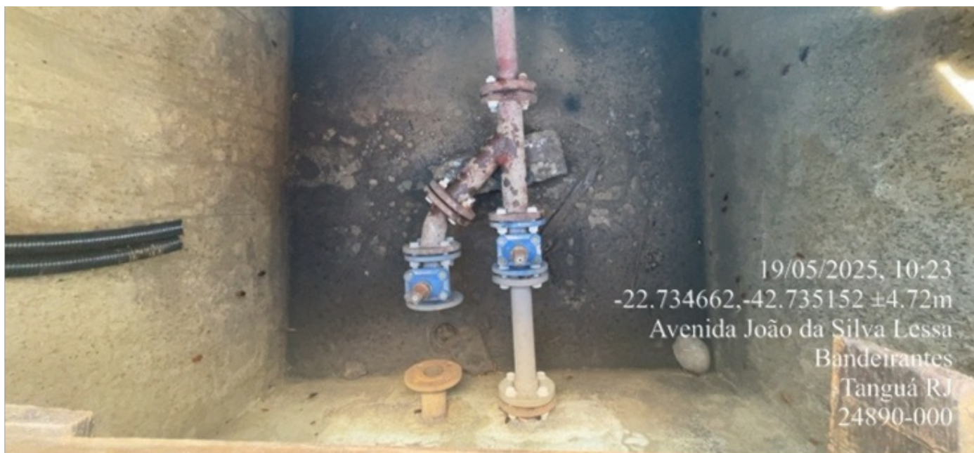
Foto 6 – Tubulação de recalque, válvulas de retenção e fechamento
