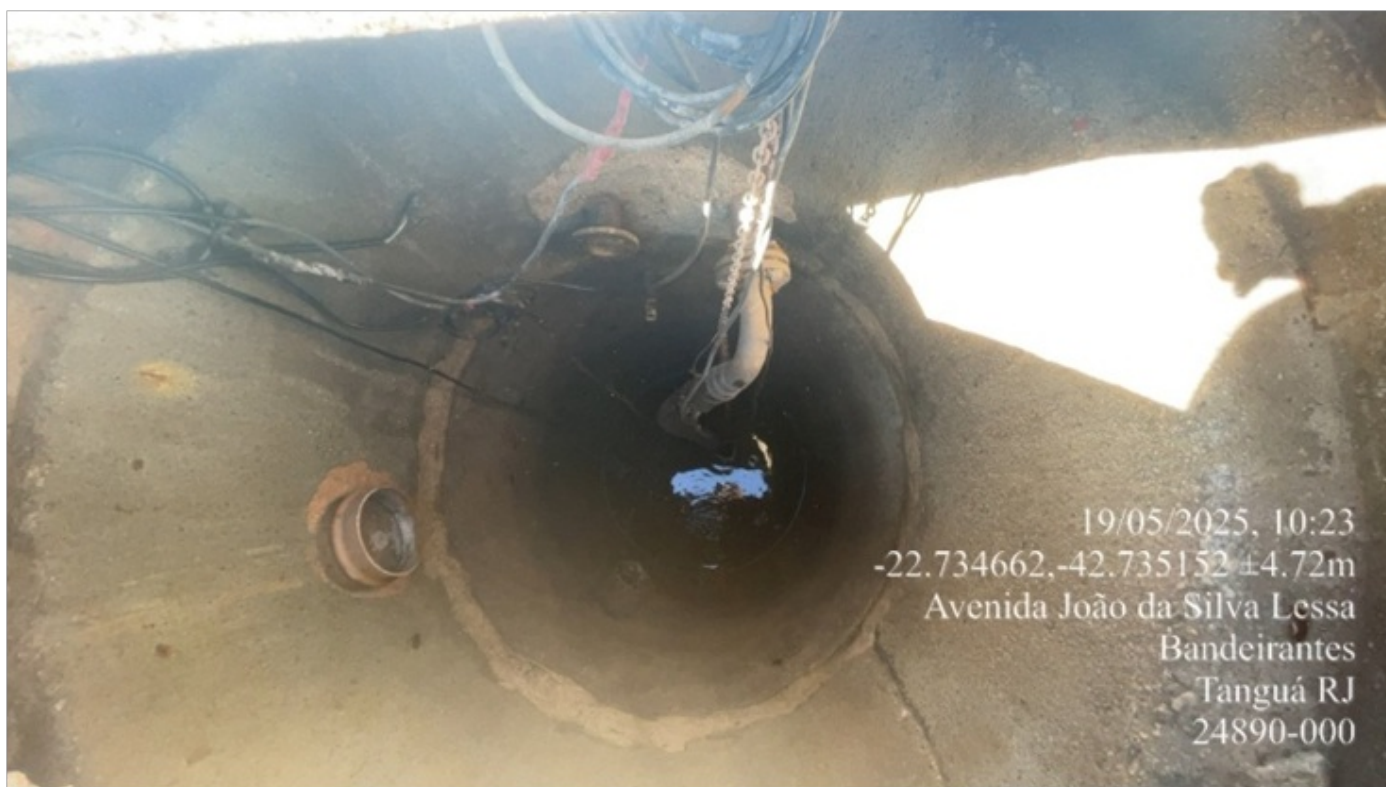
Foto 6 – Poço da motobomba submersível de recalque.
