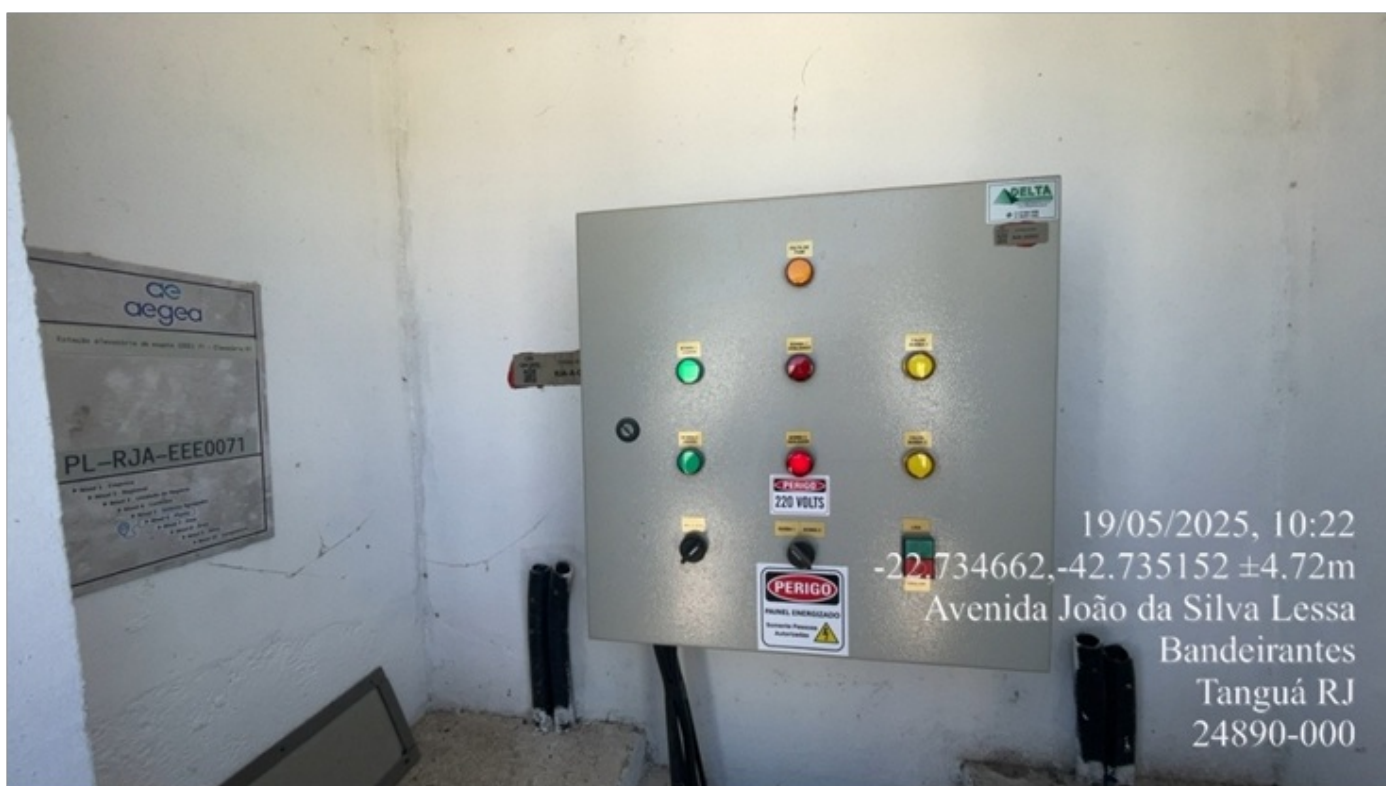
Foto 3 – Painel de controle.
