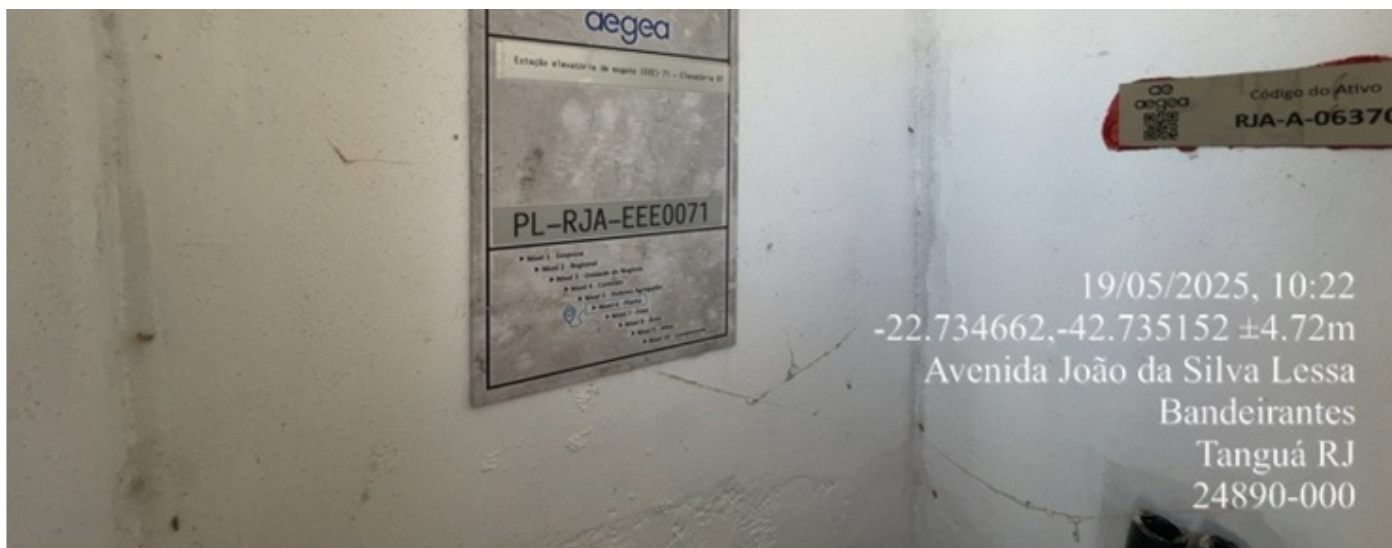
Foto 2 – Placa de identificação da elevatória.
