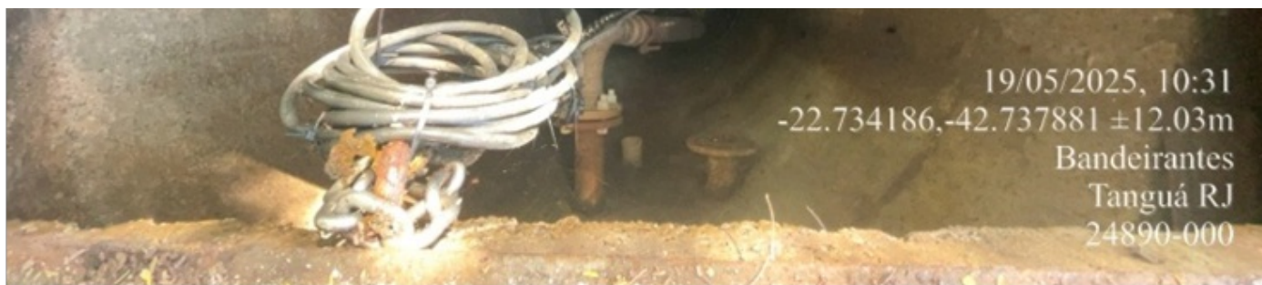
Foto 6 – Poço da motobomba submersível de recalque.
