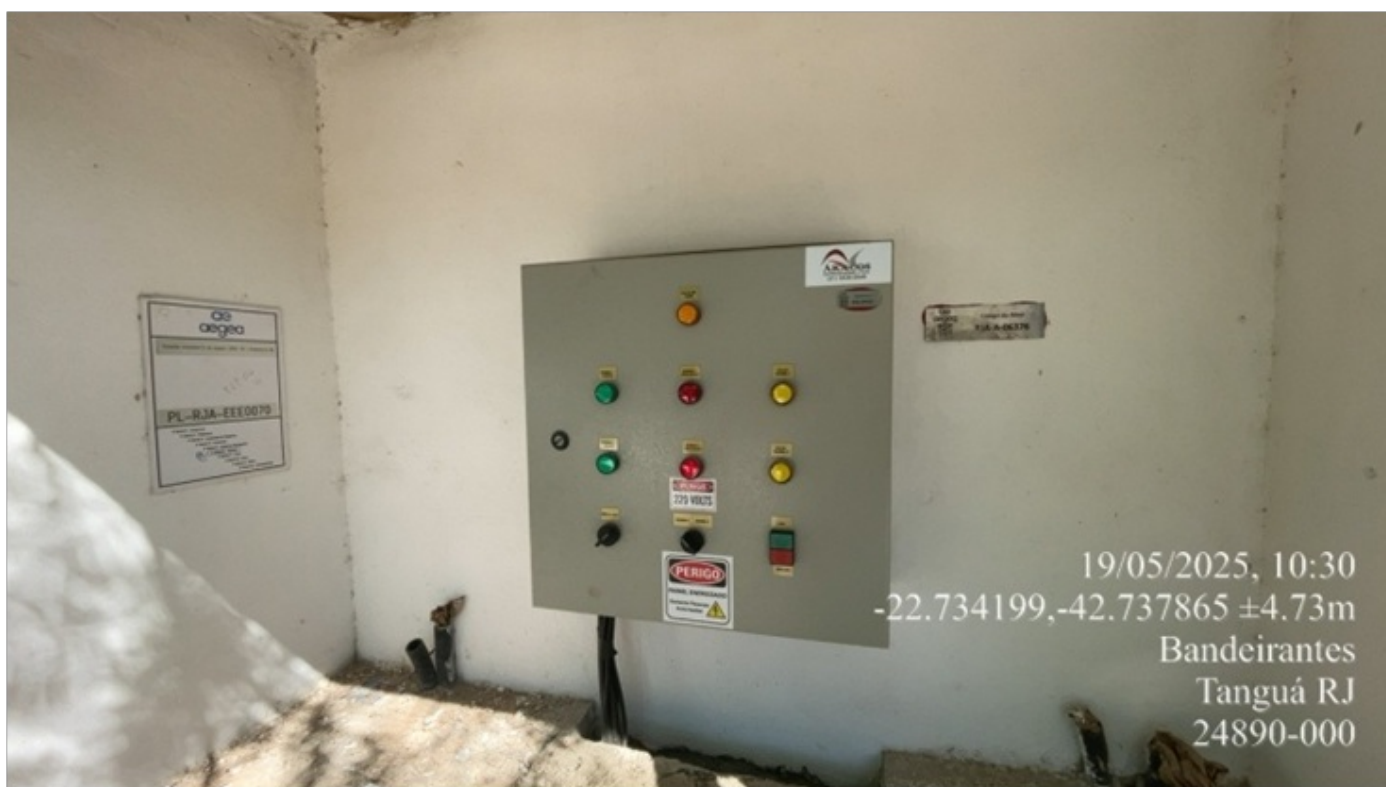
Foto 4 – Painel de controle.
