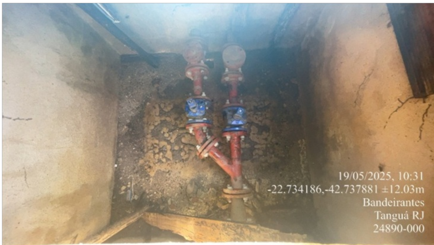
Foto 7 – Tubulação de recalque, válvulas de retenção e fechamento.
