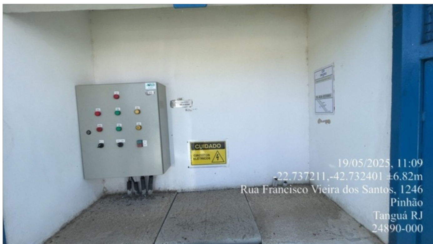
Foto 4 – Painel de controle da elevatória.
