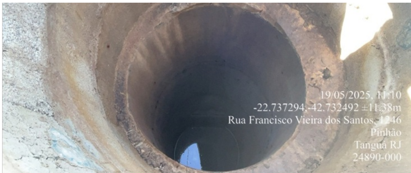
Foto 5 – Poço da chegada do esgoto e gradeamento de sólidos.
