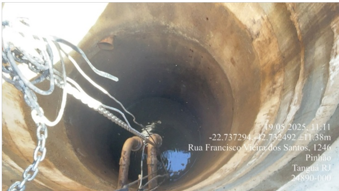
Foto 6 – Poço da motobomba submersível de recalque.
