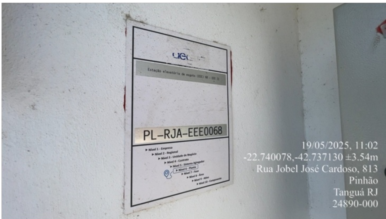
Foto 2 – Placa de identificação da elevatória.
