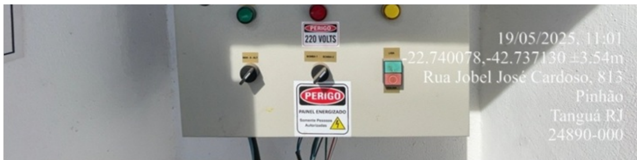
Foto 3 – Painel de controle.
