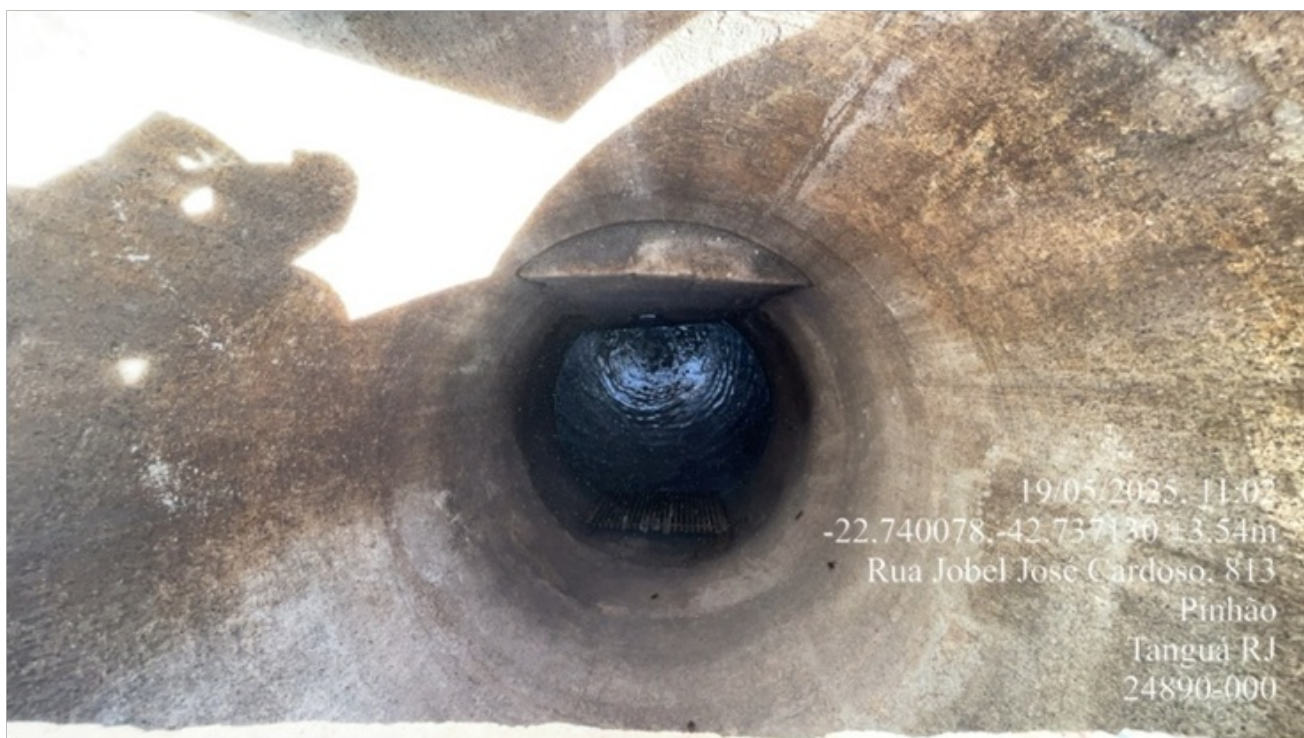
Foto 4 – Poço da chegada do esgoto e gradeamento de sólidos.
