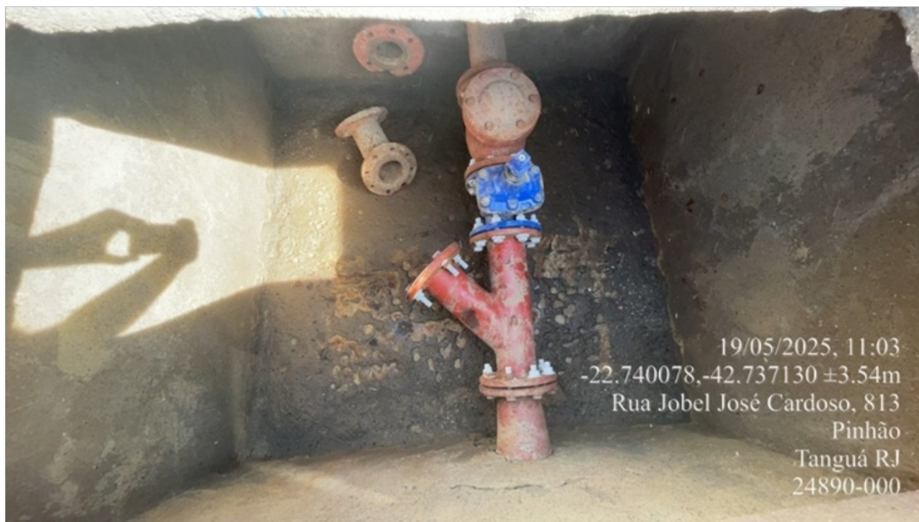
Foto 6 – Tubulação de recalque, válvulas de retenção e fechamento.
