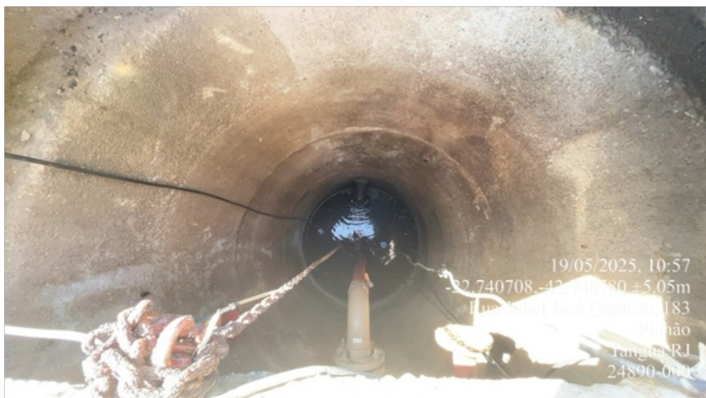
Foto 5 – Poço da motobomba submersível de recalque.
