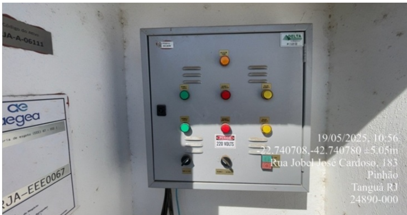
Foto 3 – Painel de controle
