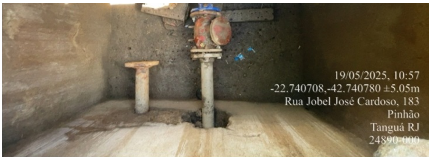
Foto 6 – Tubulação de recalque, válvulas de retenção e fechamento
