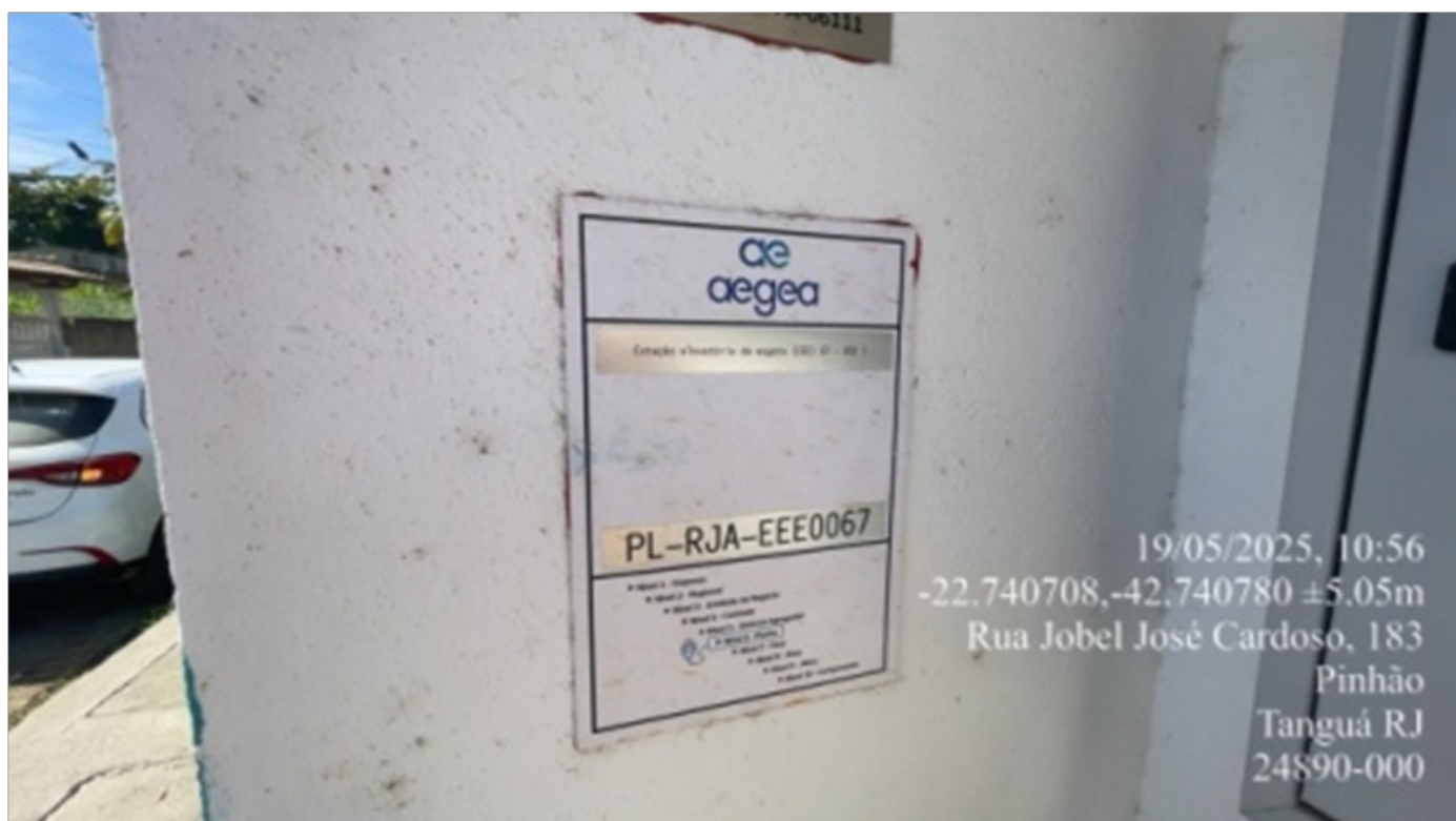
Foto 2 – Placa de identificação da elevatória.
