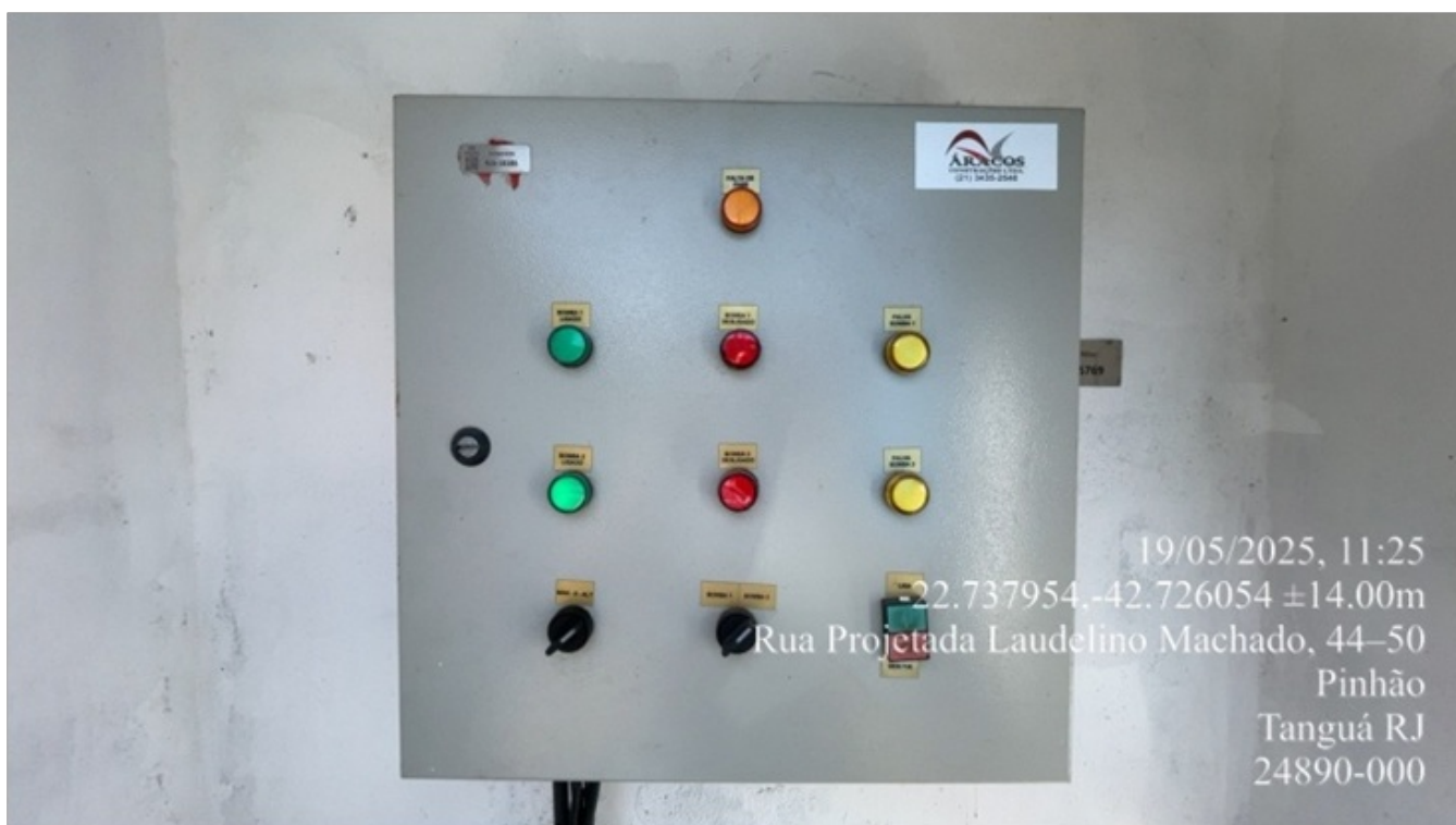
Foto 4 – Painel de controle
