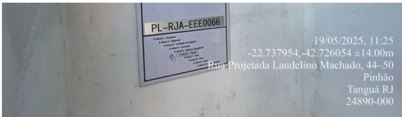
Foto 3 – Placa de identificação da elevatória.
