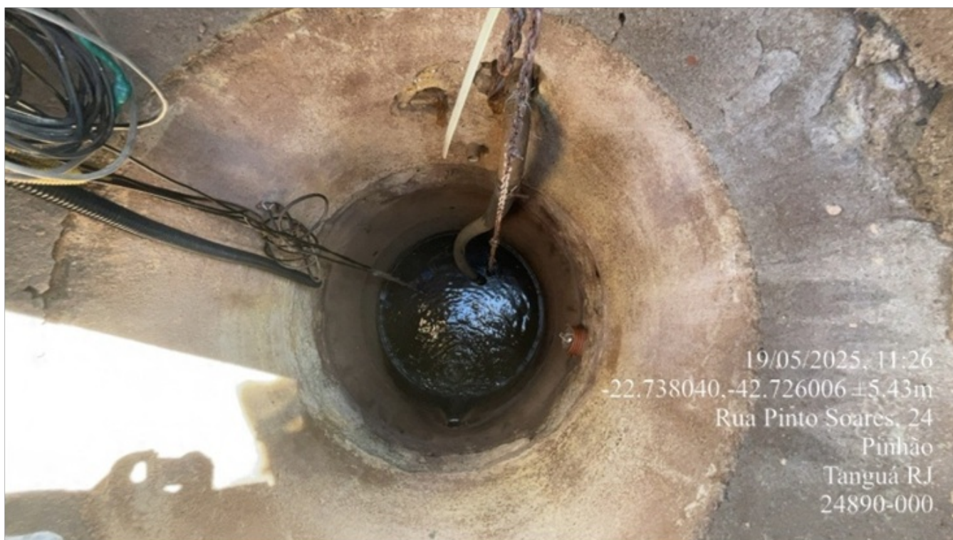
Foto 6 – Poço da motobomba submersível de recalque.
