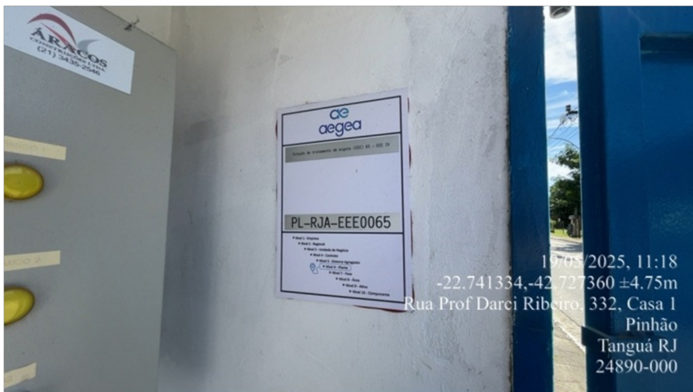
Foto 2 – Placa de identificação da elevatória.
