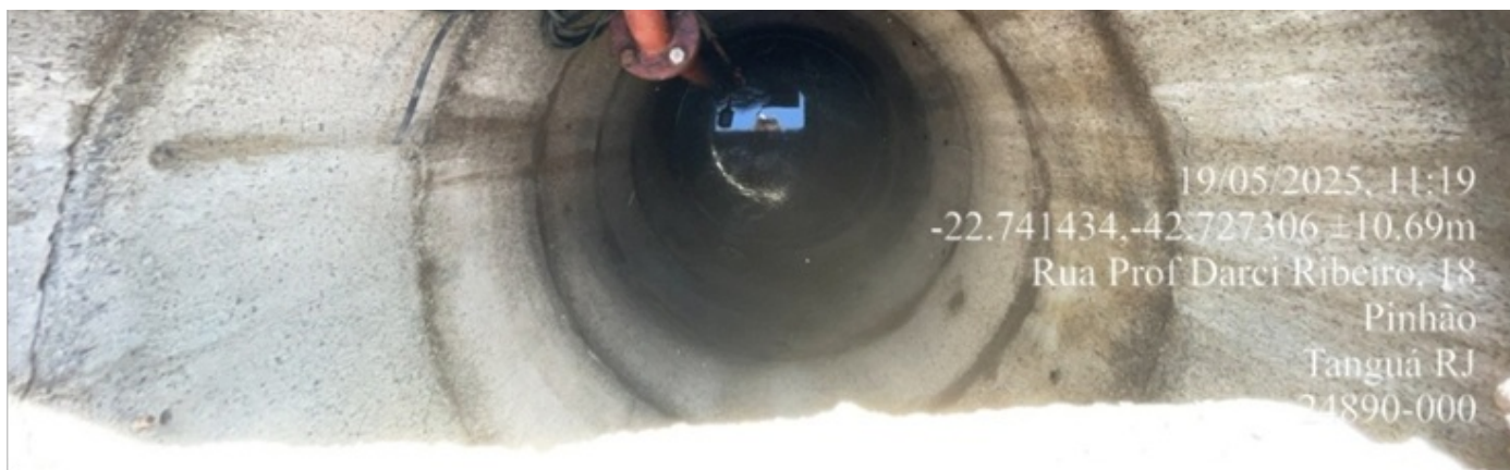
Foto 4 – Poço da motobomba submersível de recalque.
