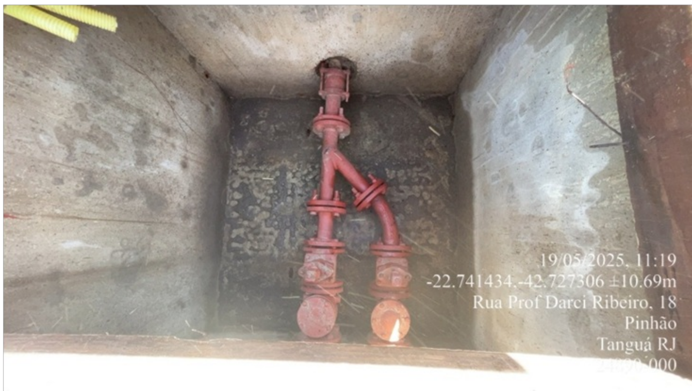
Foto 5 – Tubulação de recalque, válvulas de retenção e fechamento.
