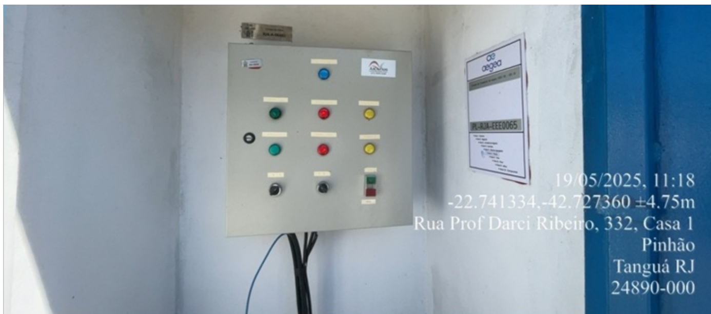
Foto 3 – Pannel de controle da elevatória.
